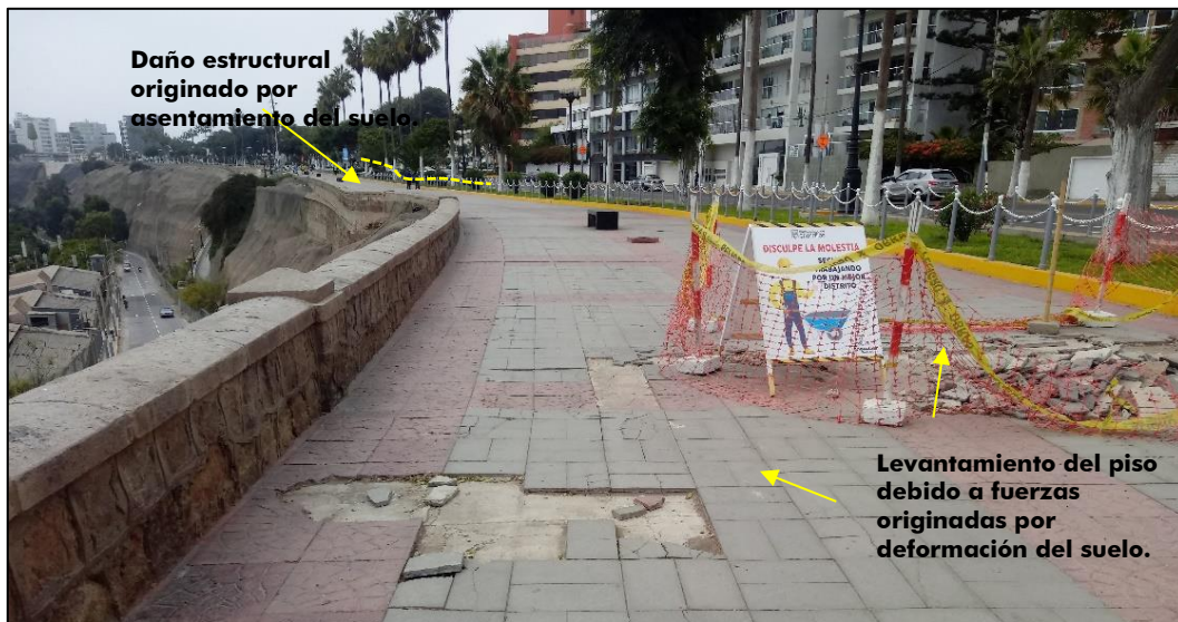
Figura 43. Daños estructurales debido a la deformación del suelo.
