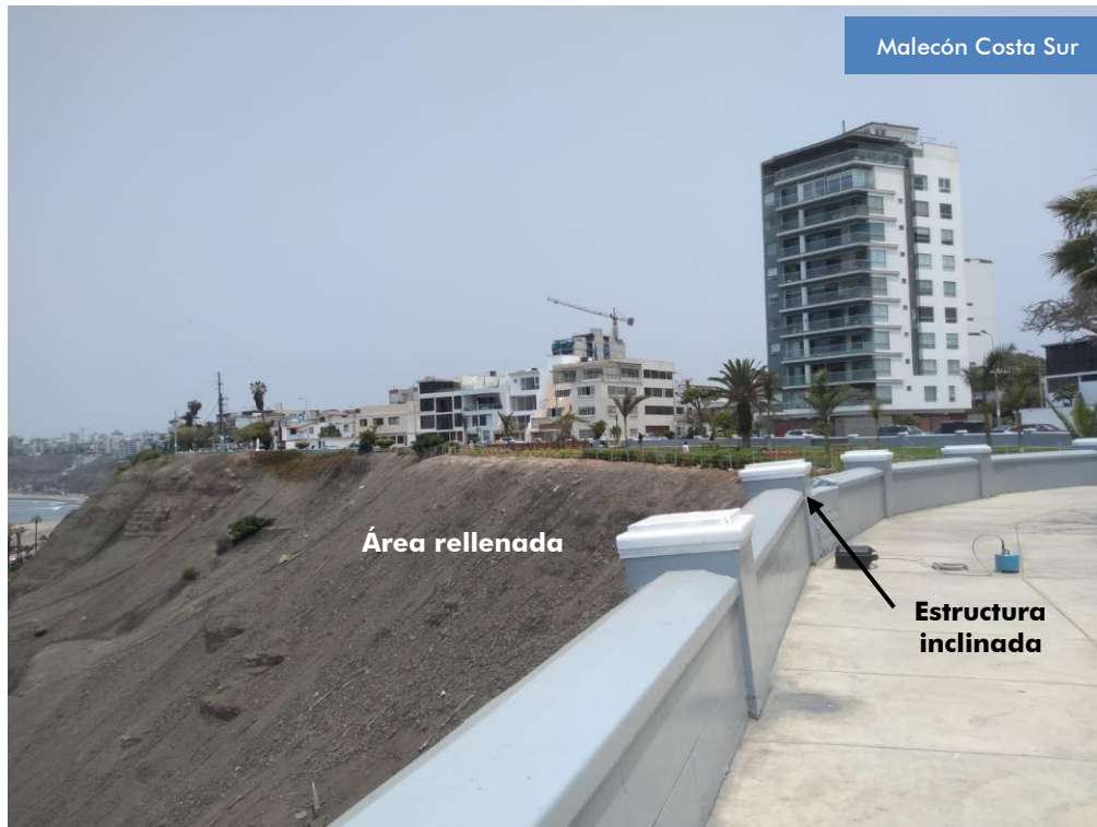
Figura 4. c) Daño estructural debido la inestabilidad del suelo identificado en el Malecón Costa Sur del distrito de Chorrillos.
