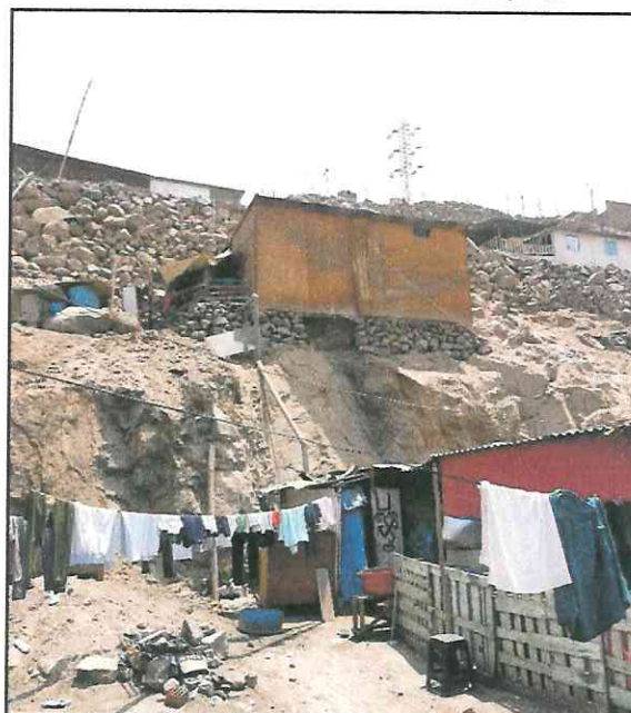
Ilustración N° 7 Caída de rocas de una pirca
