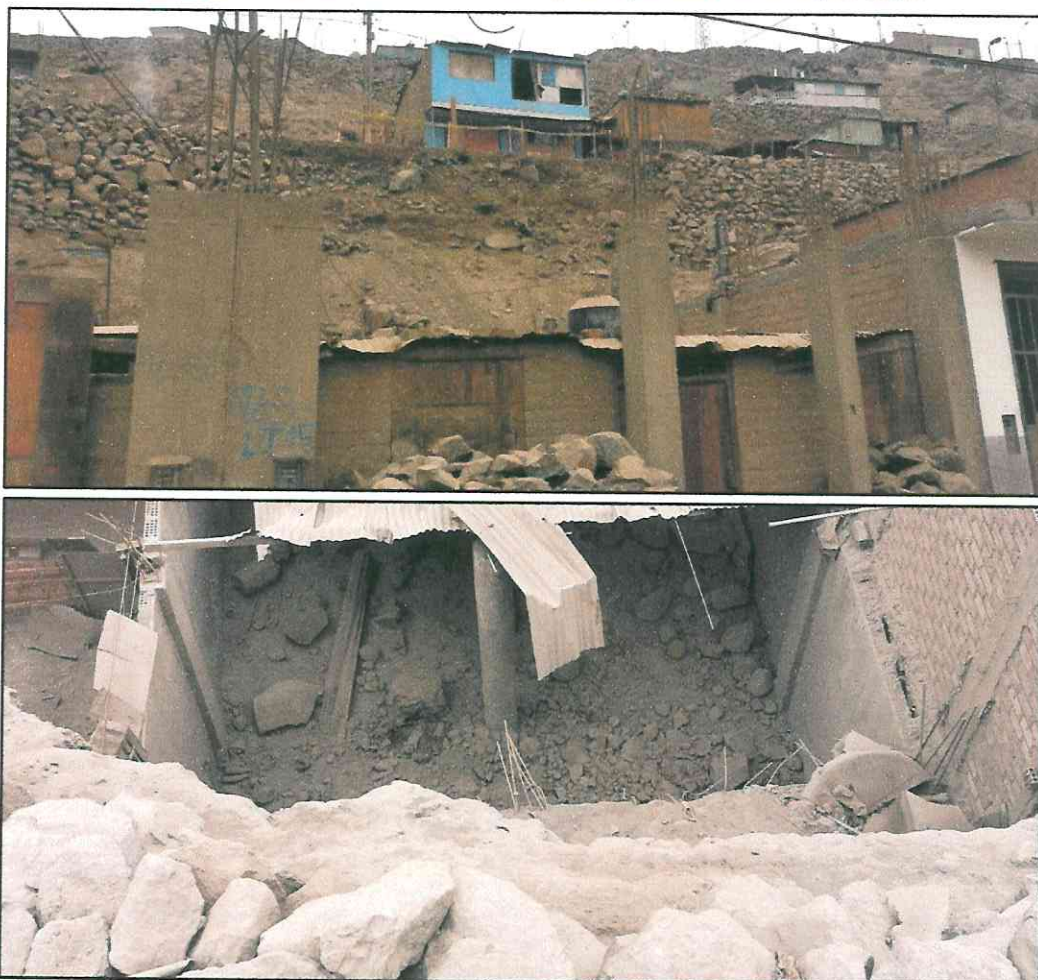
Ilustración N° 8 Derrumbe en la calle Las Orquídeas y alcance de los bloques caídos
