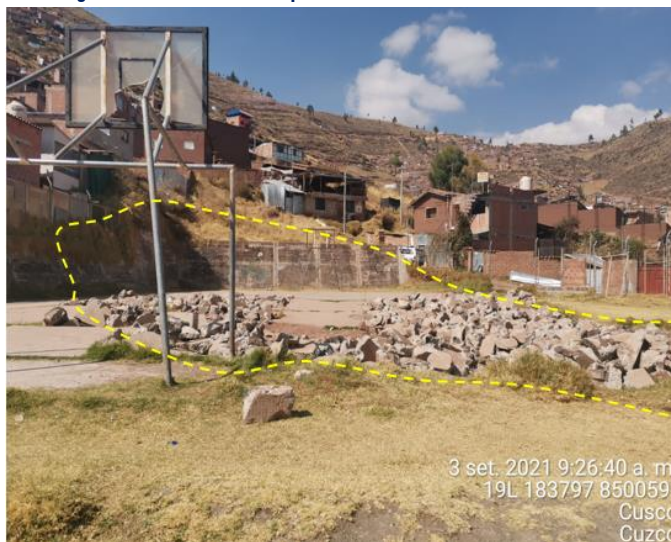
Imagen N° 26: Asentamiento por activación de cárcava Ccaramascara.
