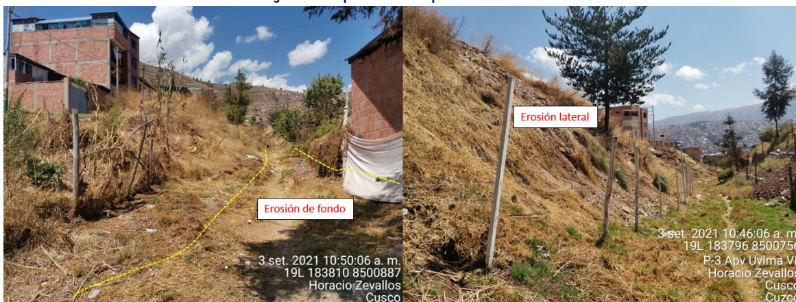
Fotografía 17: Tipos de erosión pluvial en cárcava
