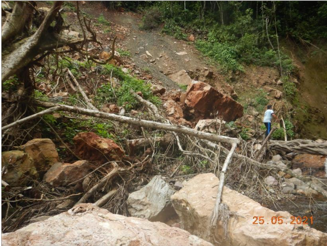
Fotografía 1. Deslizamiento de la margen derecha de la quebrada Macoshoato, se produjo en las calizas del Grupo Tarma-Copacabana.
