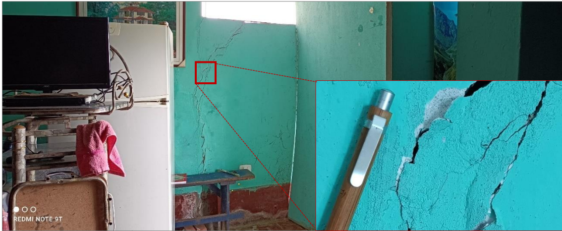
Figura 7. Grietas diagonales en la pared de la vivienda 22-B, con 2 a 5 cm de ancho y 2.5 m de longitud de piso a techo.
