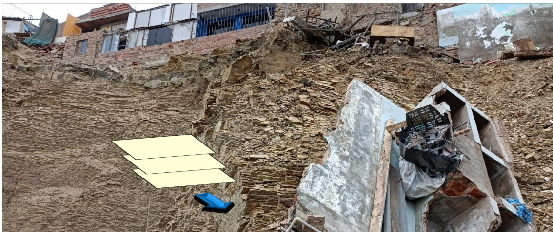
Figura 11. Estratos delgados de limolitas arenosas con buzamientos a favor de la pendiente.
