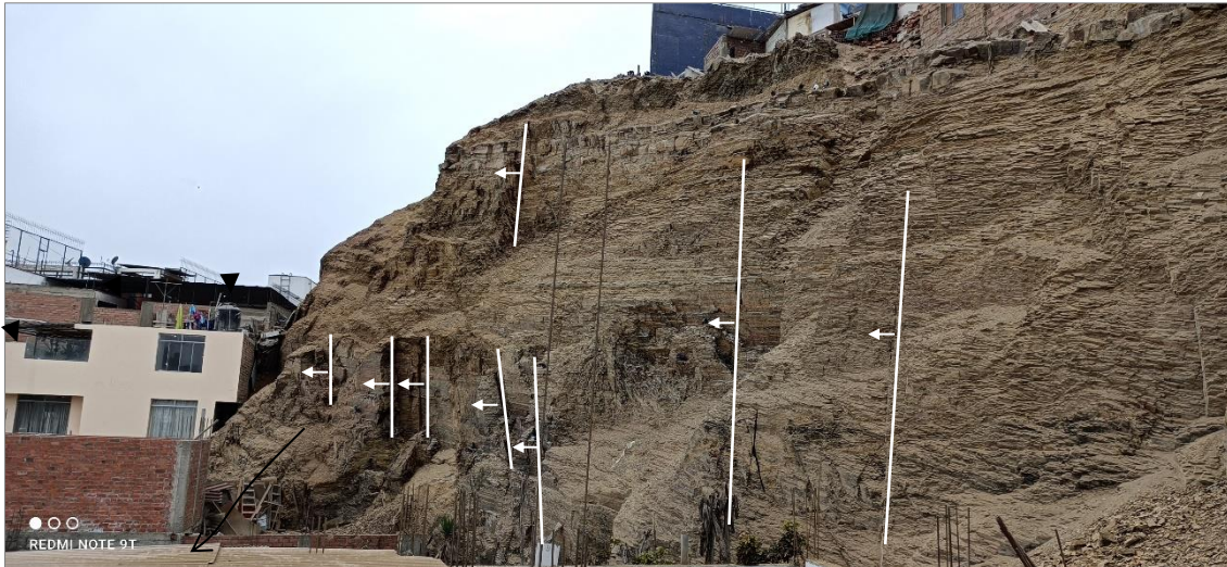
Figura 4. Vista hacia el talud en estado crítico, con pendientes subverticales expuesto a volcamientos.
