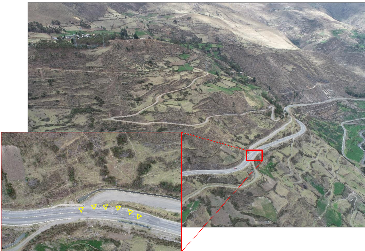
Figura 4. Vista del asentamiento de la plataforma en el km 27+760 al 28+000 de la carretera Conocochoa-Aquia, en dirección noreste, con escarpe en formación de 30 m de longitud y un desnivel de 0.30 m en la parte central.
