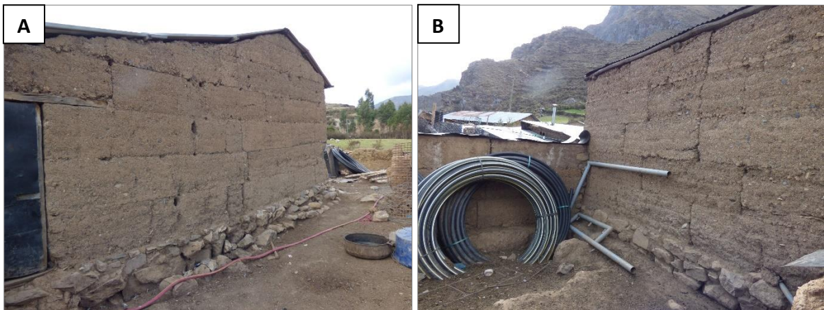
Figura 6. A, B. Viviendas del sector San Miguel, con paredes agrietadas, a consecuencia del asentamiento del terreno.
