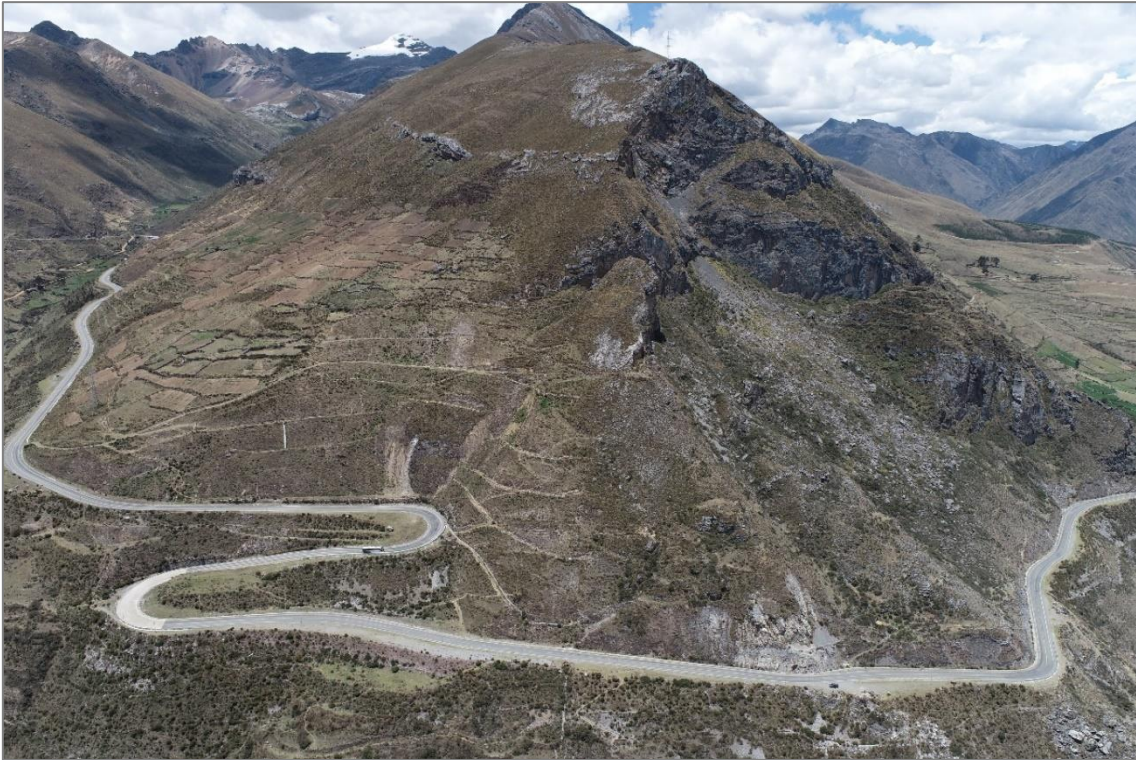
Fotografía 4. En el tramo 23+100, se observa caída de rocas, avalanchas y vuelcos, con probabilidad de rotura planar y cuñas en rocas de muy mala calidad geomecánica y buzamientos a favor de la pendiente.
