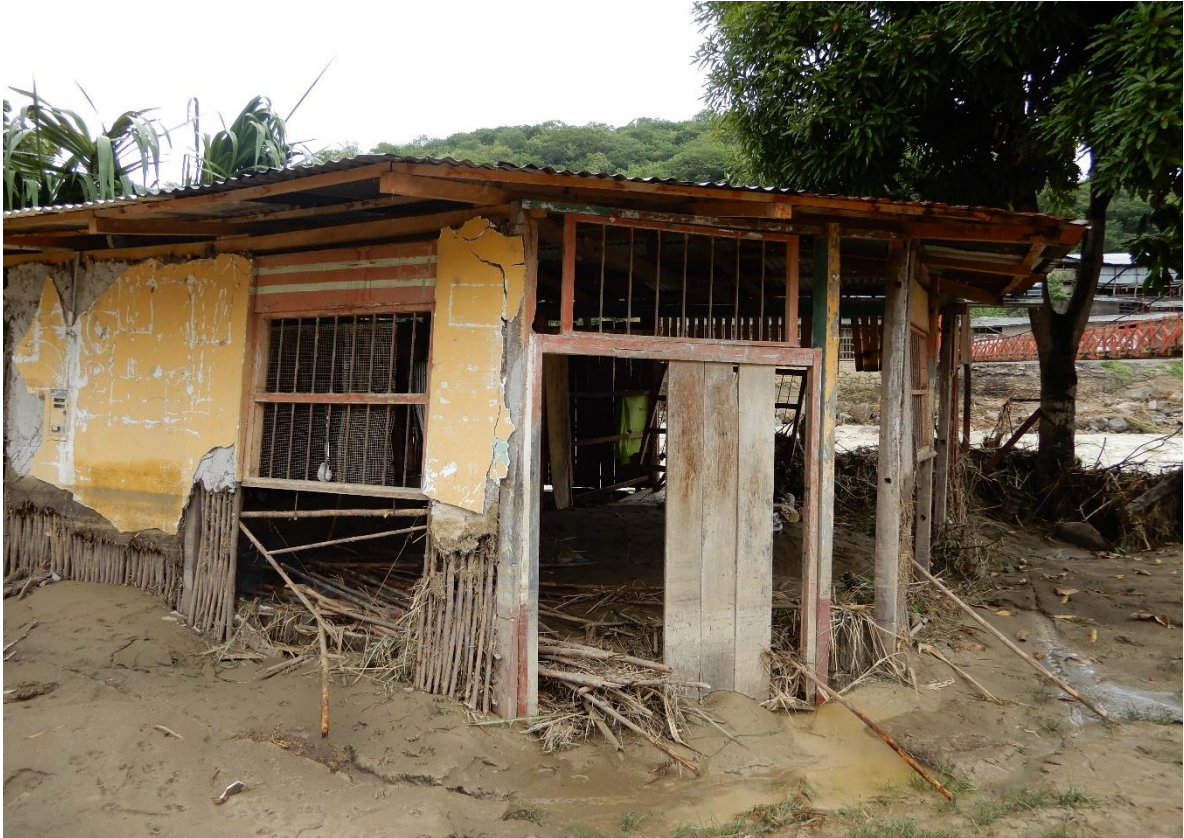
Fotografía 2. Vivienda destruida por la inundación, producto del desembalse, en la margen derecha del río Utcubamba, caserío Salao (Puerto El Huingo). Altura de agua alcanzada 1 m.
