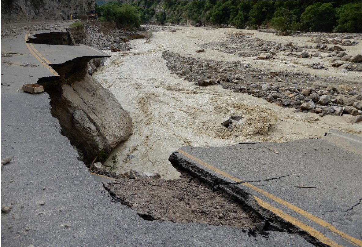
Fotografía 1. Carpeta asfáltica de la carrera Fernando Belaunde afectada por la erosión, aguas abajo del dique, luego del desembalse del represamiento de Aserradero.
