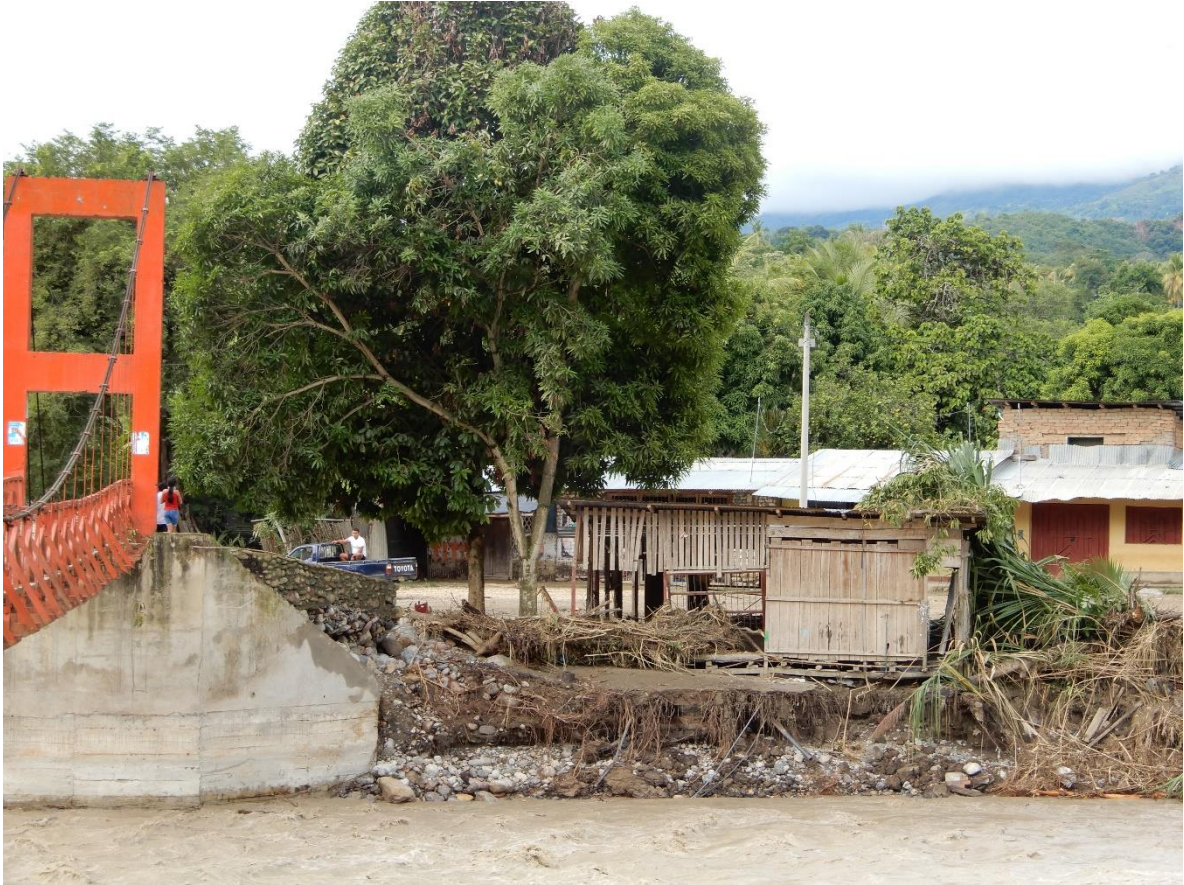
Fotografía 3. Estribo de la margen derecha del río Utcubamba en el caserío El Salao, aguas arriba se observa erosión (Puerto El Huingo).
