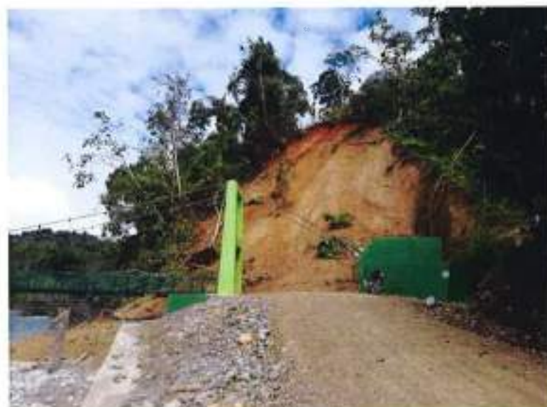
Imagen 45. Deslizamiento en el Puente Guadalupe
