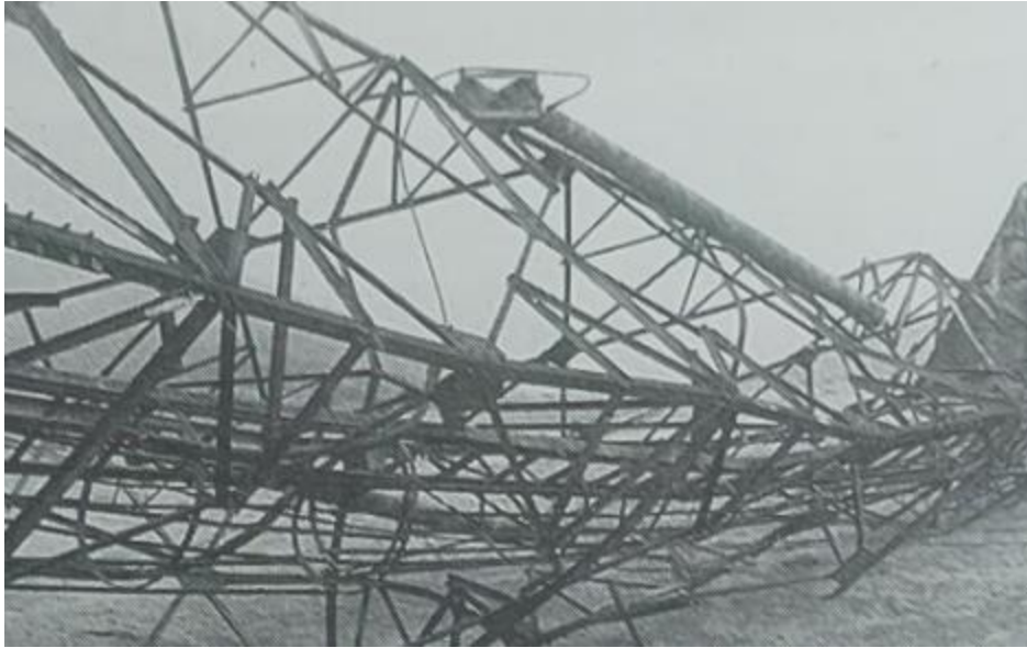
Figura 10: Daños en la estación hidroeléctrica de Aricota, en Tacna (Diario Expreso. 27/01/1998)
