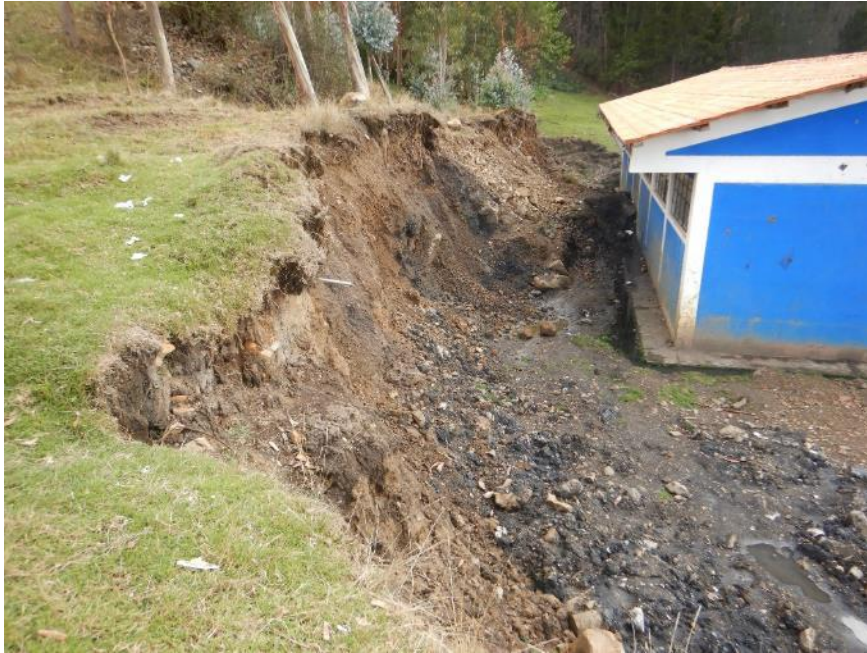
Fotografía 14. Derrumbes que afectan el local comunal de Chagapampa. Se puede observar la inclinación de los arboles producida por la reptación de los suelos.
