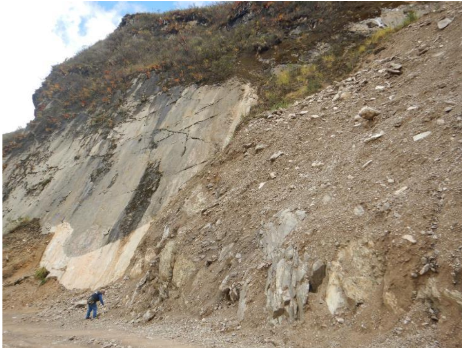
Fotografía 3. Calizas de la Formación Jumasha en el sector Chillín. Estos afloramientos se encontraban medianamente a muy fracturados y moderadamente a altamente meteorizados.
