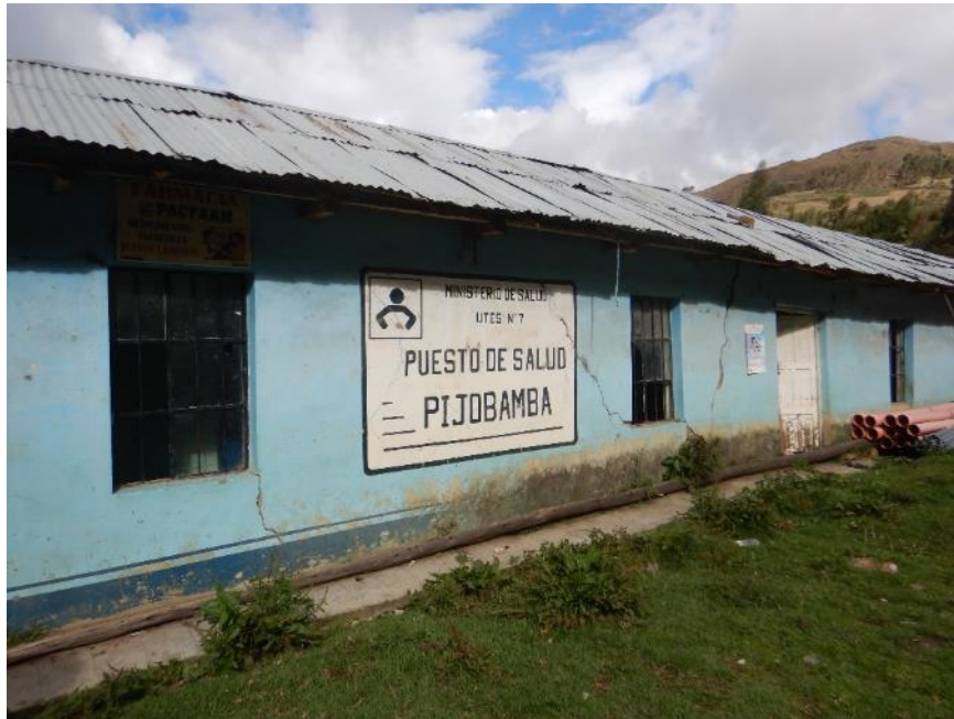
Fotografía 18. Agrietamientos en el Puesto de Salud Pijobamba debido a los asentamientos del terreno.
