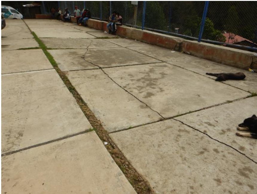
Fotografía 15. Agrietamientos en la losa deportiva del centro poblado Chagapampa producidos por asentamientos del terreno.
