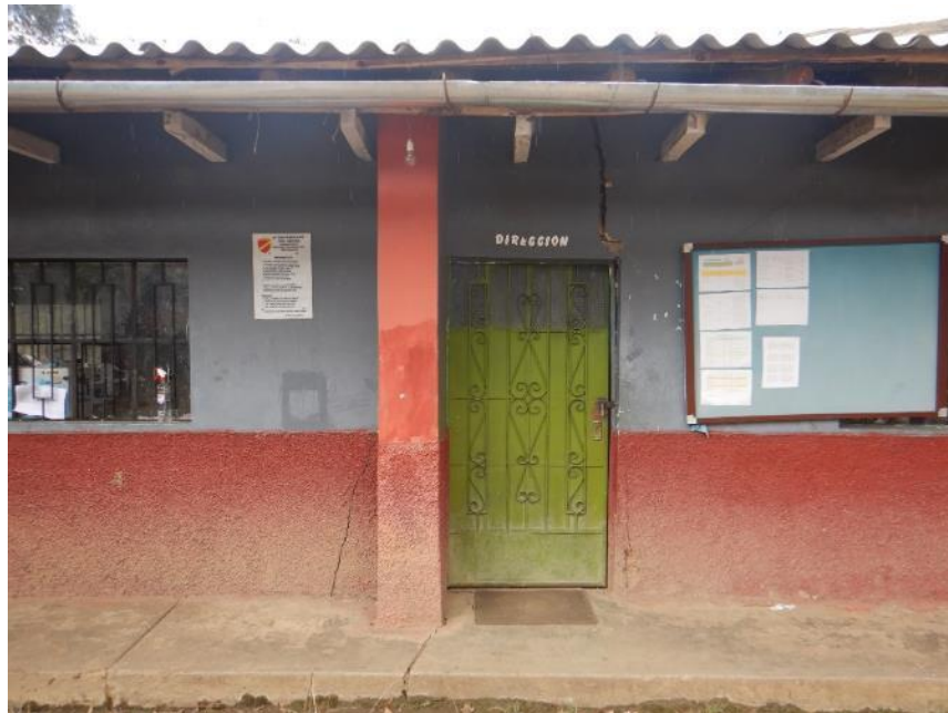
Fotografía 12. Agrietamientos en la I.E. Mario Vargas Llosa 80595-Chagavara.
