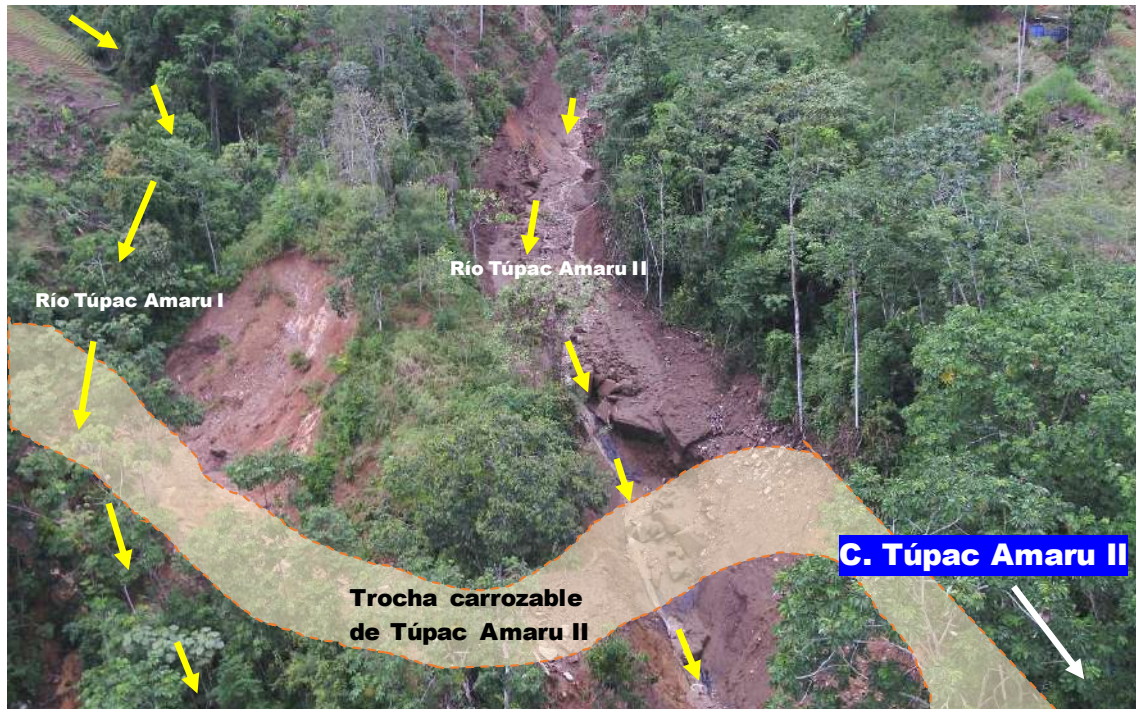
Fotografía 14. Vista aérea frontal de la trocha carrozable de Túpac Amaru II destruida debido al crecimiento del rio del mismo nombre, las flechas amarillas muestran la dirección del flujo. Fuente: INDECI-PICHARI
