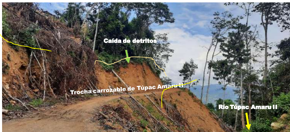
Fotografía 20. Vista de la carretera Túpac Amaru II rehabilitada, flanco izquierdo del río Túpac Amaru II, se observa la presencia de derrumbes por donde pasó el flujo de detritos.
