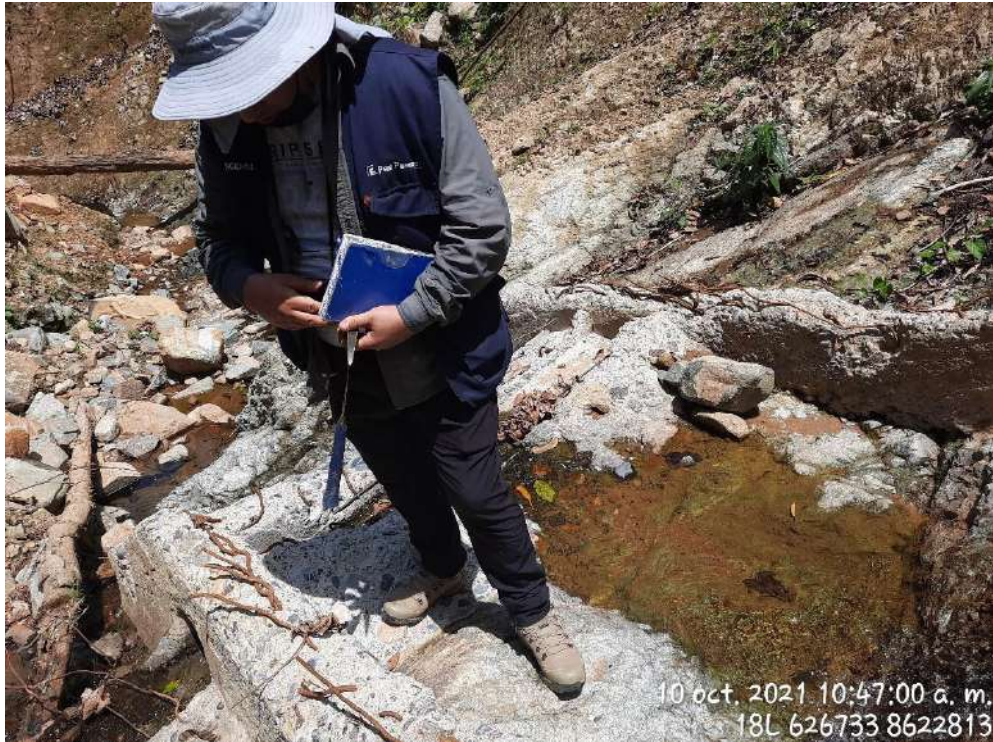
Fotografía 16. Bocatoma destruida por el flujo de detritos del 21 de abril de 2021
