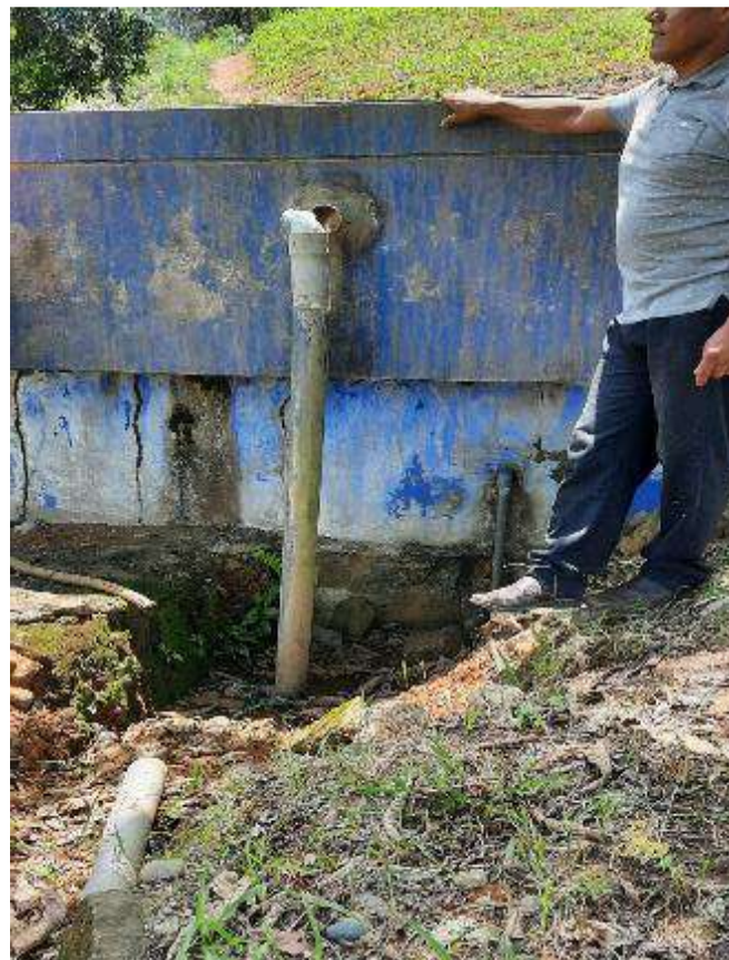
Fotografía 17. Pozo de filtración en mal estado ubicado de 60 m del flanco izquierdo del río Túpac Amaru, se observa tuberías rotas y abundante material arenoso y limoso en el interior del pozo.
