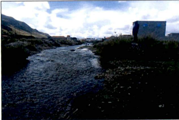
Fotografía 1: Quebrada Seca colmatado en un 60%, erosión de la ribera ambas margenes, sector Ninacaca.
