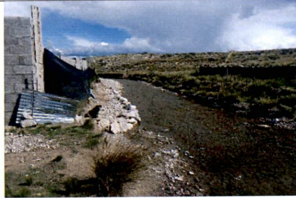
Fotografía 4: Quebrada Seca, construccion de casa en las riberas, crianza de porcinos, posible desborde.
