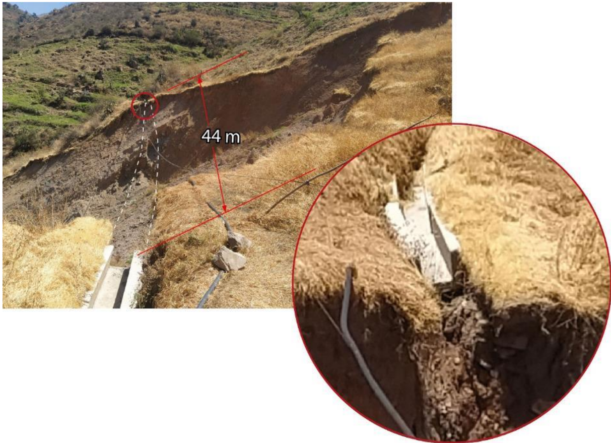
Figura 21. Canal de concreto destruido.
