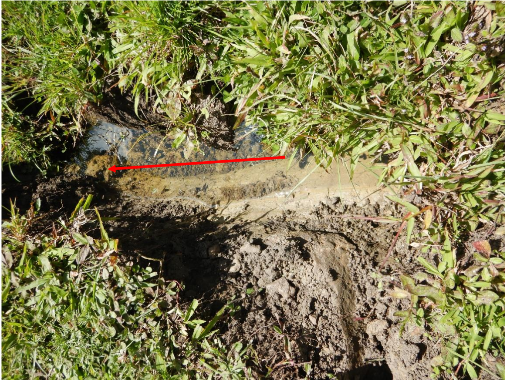
Figura 4. Se observa una escorrentía superficial de agua transparente de aproximadamente 1 l/s de caudal que se pierde en un de los agrietamientos que actúa como un sumidero.
