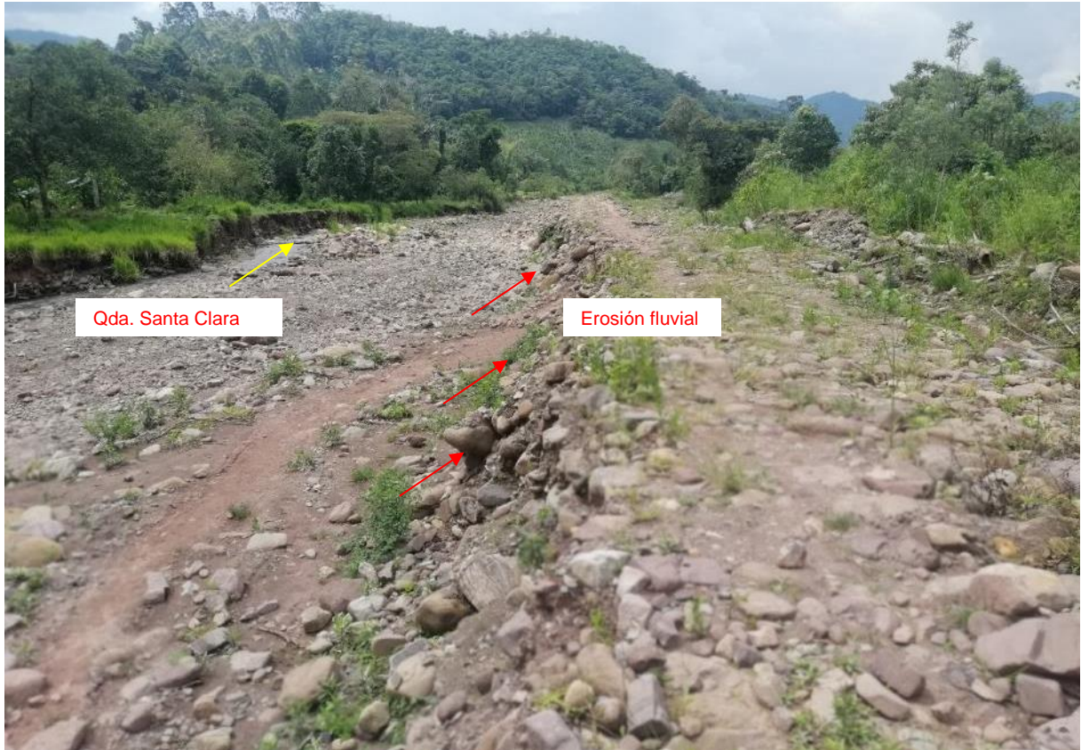
Figura 22. Dique de relleno granular con evidencias de erosión fluvial. Nótese el desmoronamiento de los clastos que componen la estructura.
