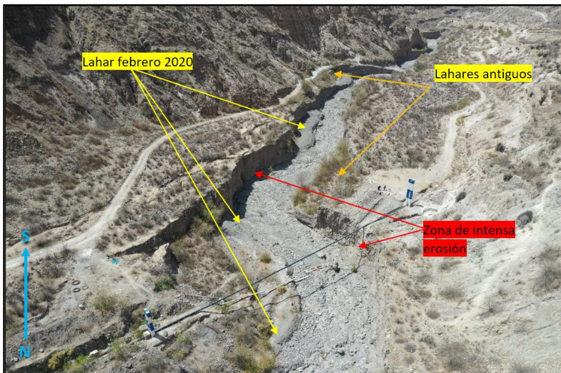
Figura 32. Pase aéreo de tubería en la quebrada El Volcán. (Coordenadas UTM WGS84 301319E, 8153128N).
