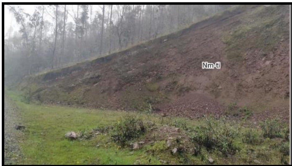
Imagen N° 16: Se observan areniscas intercaladas con lodolitas altamente fracturadas y meteorizadas de la Formación Huanta. Coordenadas UTM (WGS 84): 550900 E, 8610800 S, a 3797 m.s.n.m.
