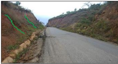
Figura 8: Erosión laminar y en surcos de laderas
