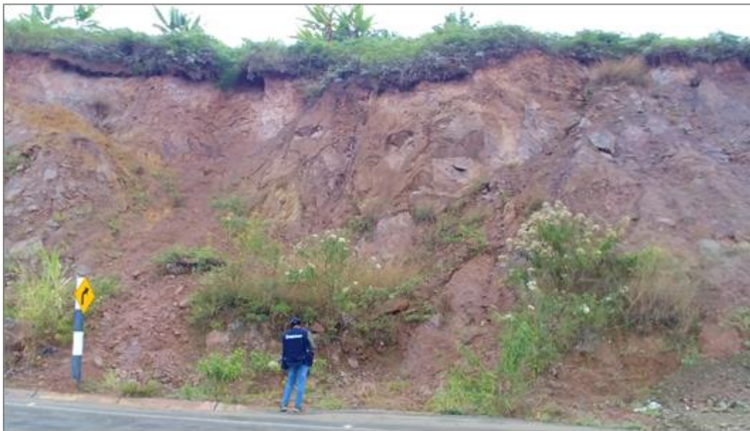
Fotografía 1: Afloramiento de limolitas pardo rojizas de la Formación Oyotún en el talud superior de la vía de Evitamiento que conduce de San Ignacio a Namballe entre el sector
