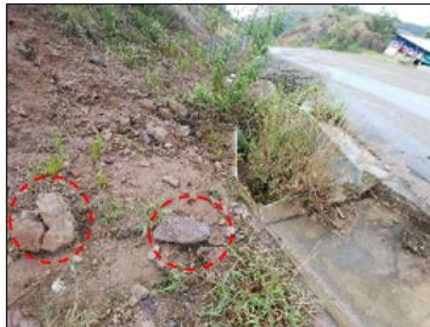
Figura 9: Caída de pequeños bloques de roca
