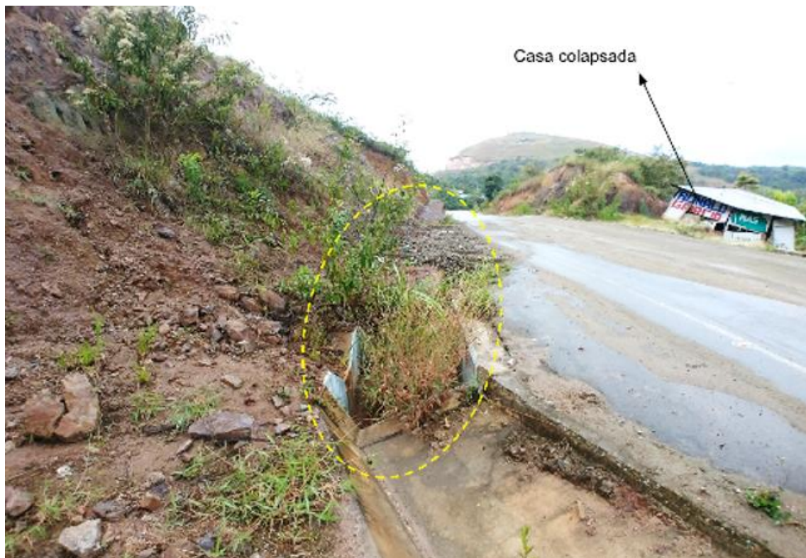
Figura 14: Cunetas y alcantarillas colmatadas por material proveniente de la erosión de laderas y caídas de bloques pequeños.
