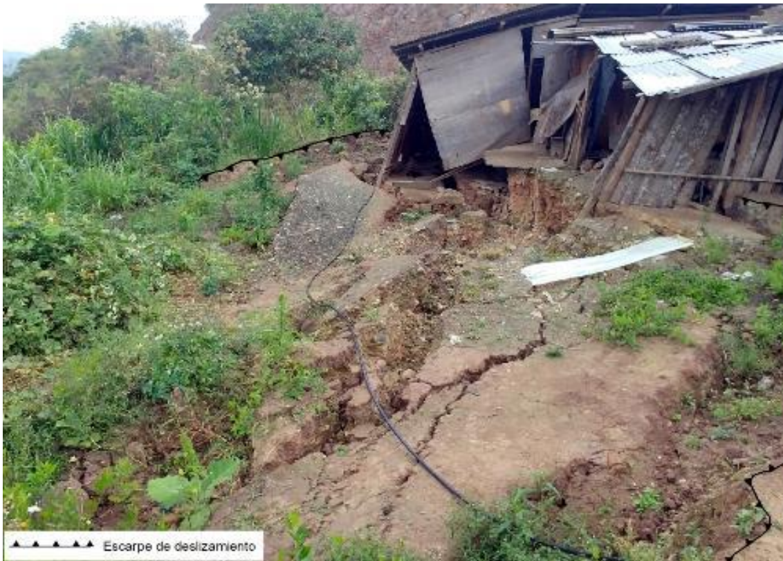
Figura 16: Vivienda gravemente afectada a causa del deslizamiento, nótese que la deformación y agrietamiento del terreno han causado el colapso de la vivienda.
