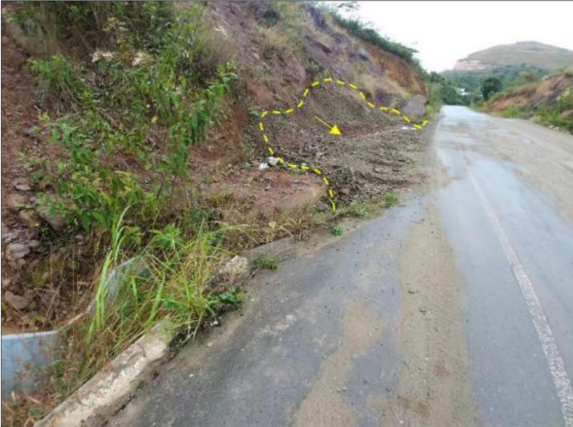
Figura 4: Erosión de talud superior con acumulación de material detrítico en la plataforma de la carretera.
