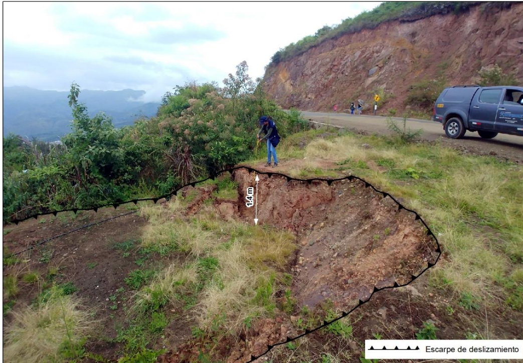
Figura 12: Forma semicircular de la corona del deslizamiento en el talud inferior de la vía de Evitamiento.
