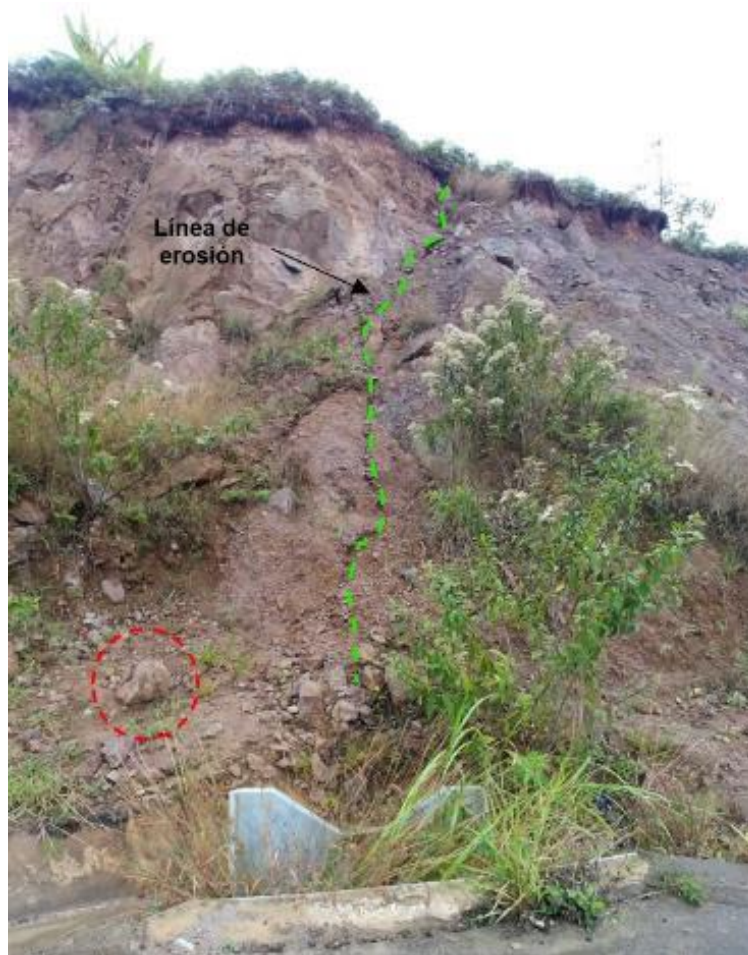
Figura 19: Erosión laminar en talud superior desprovisto de vegetación, que arrastra finos y pequeños fragmentos de roca, estos han colmatando la alcantarilla.
