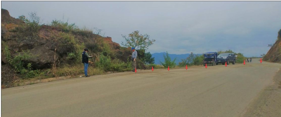
Figura 10: Agrietamiento semicircular en la plataforma de la vía de evitamiento.
