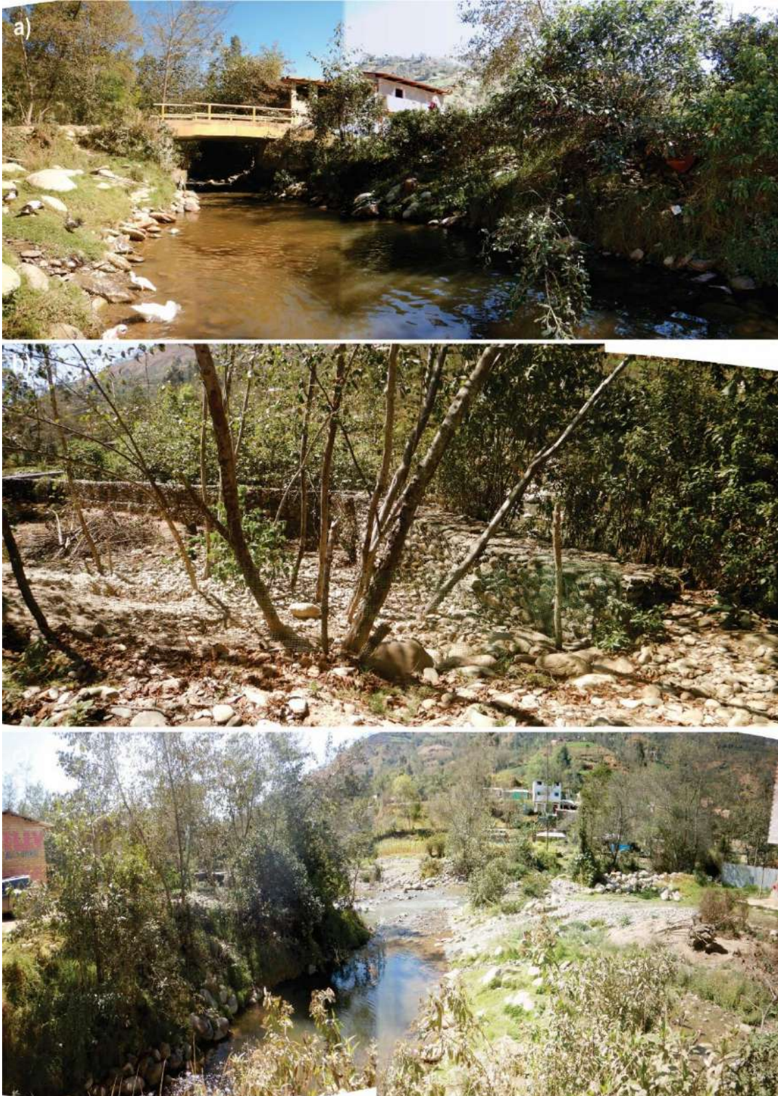
Figura 28. a) La inundación sobrepasa el puente del sector, b) En la margen izquierda del río Cochato se observa gaviones; los cuales fueron instaladas post inundación; c) Intersección de los ríos Cochato y Manzano.
