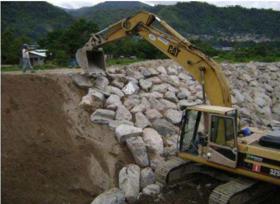
Fotografía 02. Protección de riberas mediante enrocados.
