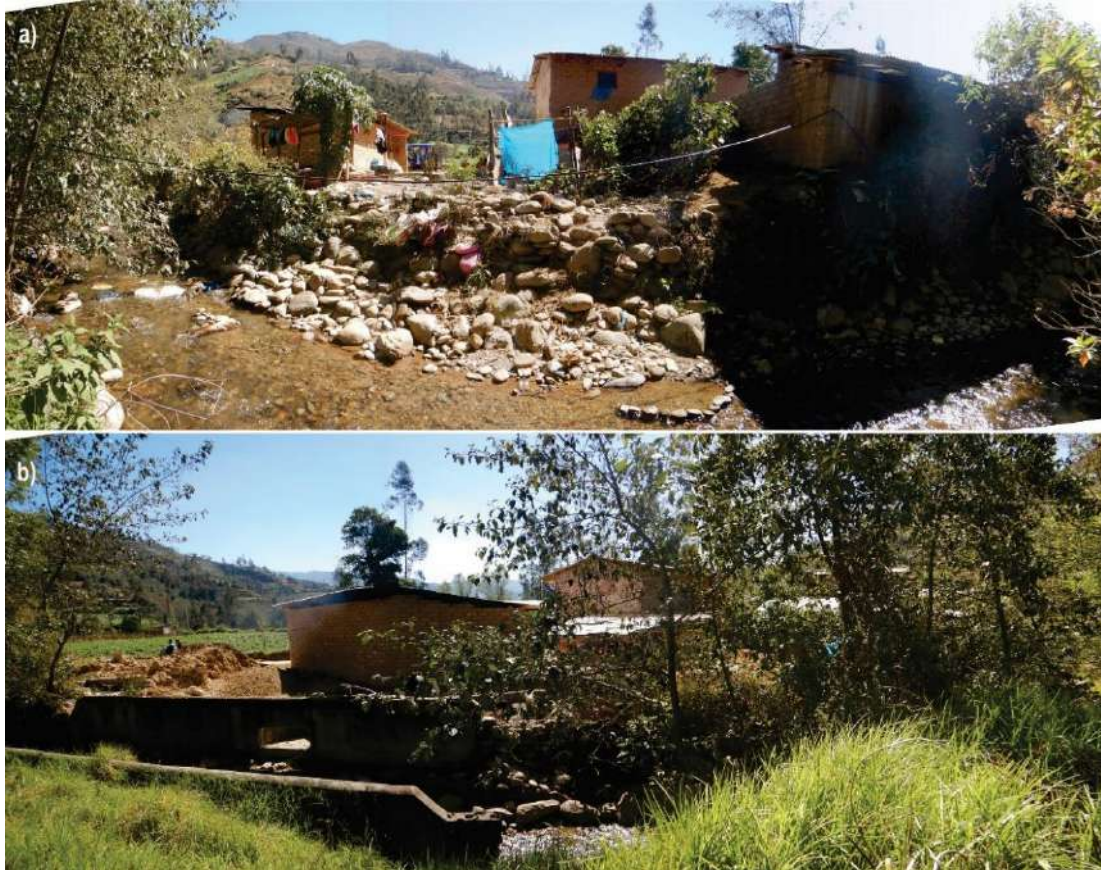
Figura 26. Se observa colapso del enrocado producto del desborde del río.
