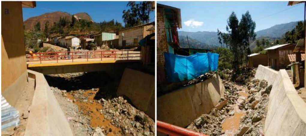
Figura 12. Vista con dirección al norte, en la cual se puede observar que algunos propietarios estrecharon el cauce principal.
