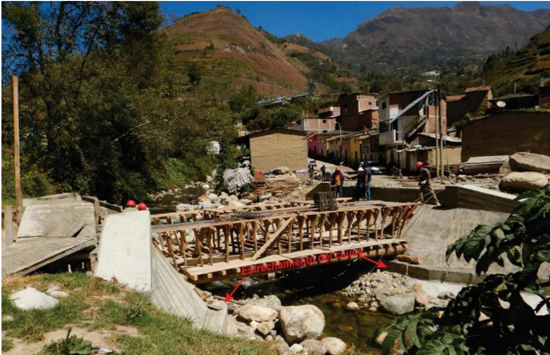
Figura 19. Se observó que en el río Manzano se están construyendo un nuevo puente, en donde se puede notar que los estribos de dicho puente están reduciendo más el cauce.
