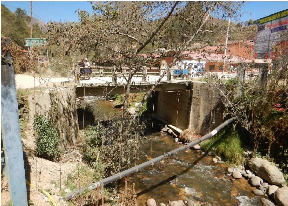
Fotografía 3. Tubería de agua potable afectado; actualmente fue reparado y continua en uso.
