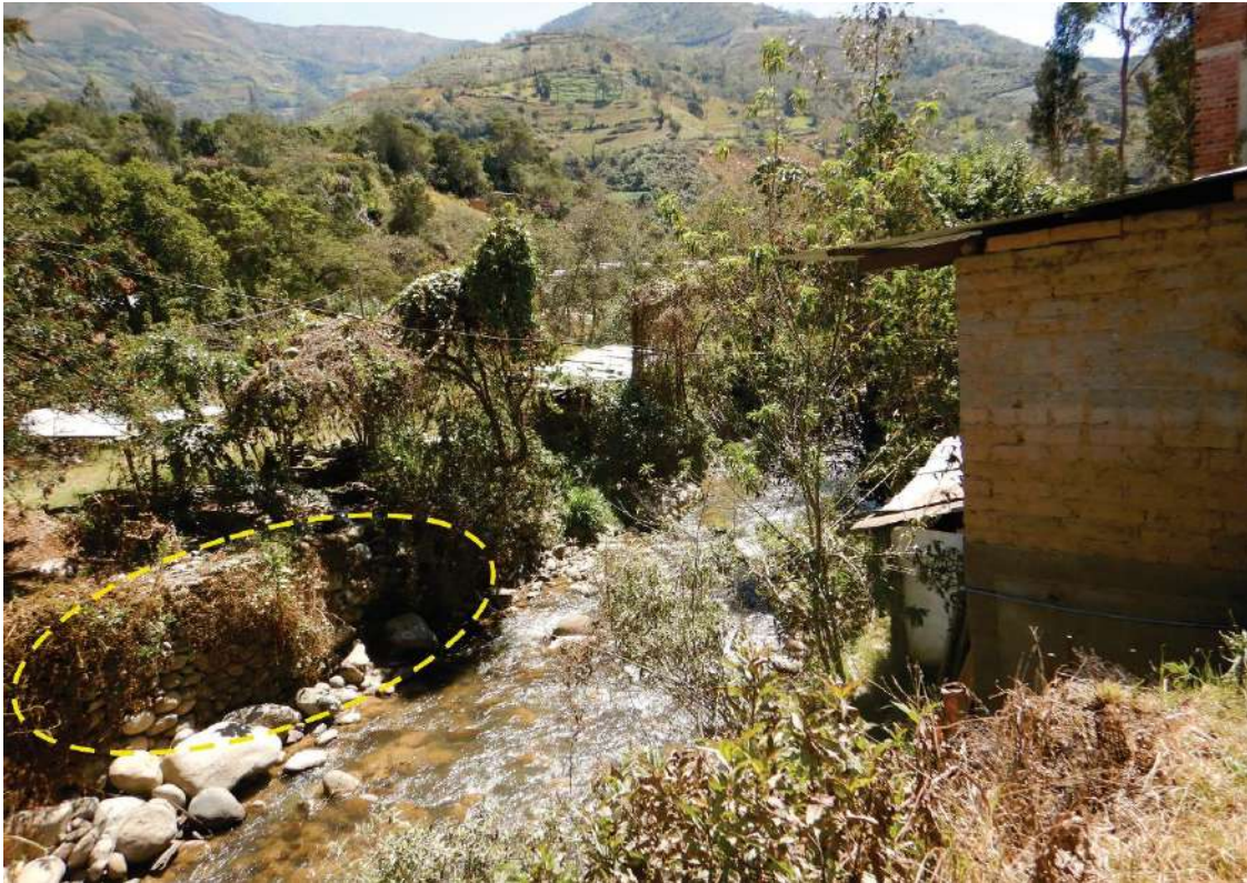
Figura 23. Se observa enrocado rustico en la margen izquierda del río Chinchaycocha.
