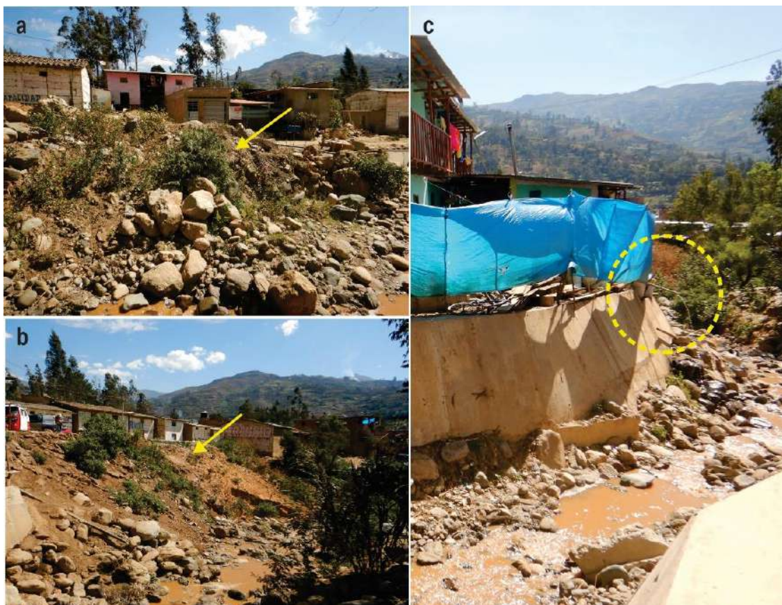
Figura 15. a) Material de desmonte depositado en las márgenes del río, b) Desmontes y residuo sólidos y c) tubería por donde están discurriendo aguas servidas hacia el río Tirish Huanca
