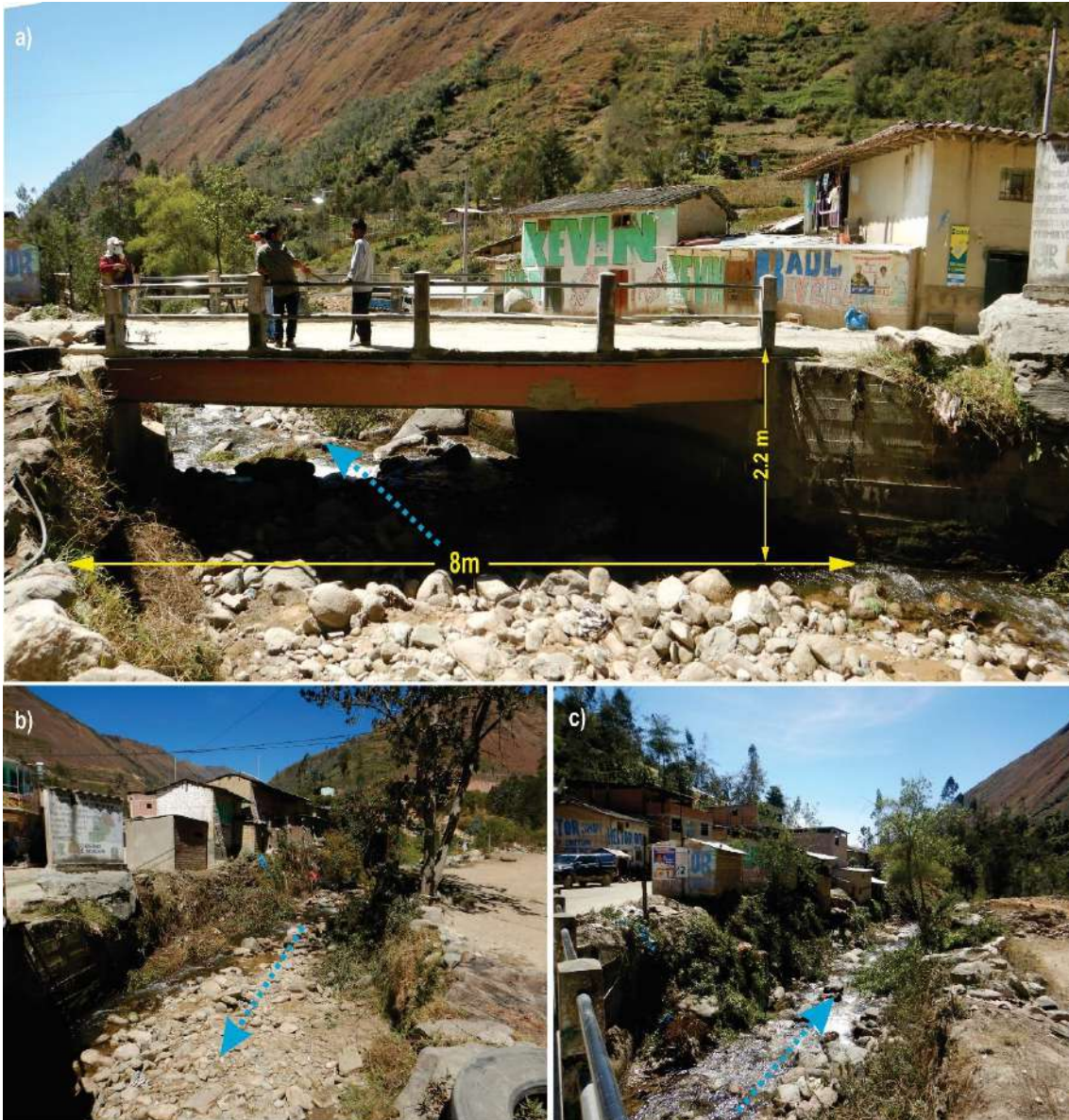
Figura 17. a) El cauce del río tiene un ancho de 8 m, por donde cruza un puente de concreto por donde desbordo el río Cuchimachay, b) Vista con dirección aguas arriba se observa viviendas en la margen derechas dos de estas colapsaron producto de la inundación y la antigüedad de la vivienda; actualmente fueron reconstruidas, c) Vista aguas abajo donde se puede observar el desnivel del suelo, la margen izquierda presenta una pendiente más alta.
