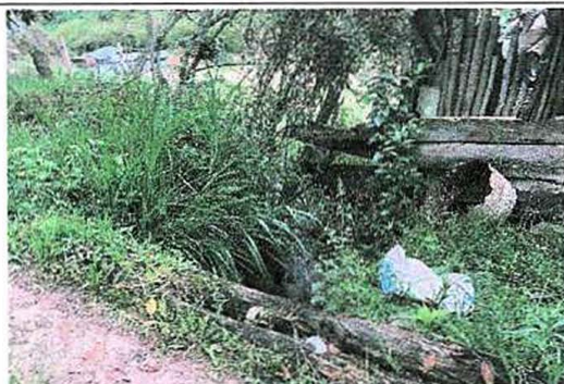
Fotografía N° 1: Porción artesanal existente, indicado como punto de desborde de la quebrada hacia las viviendas.
