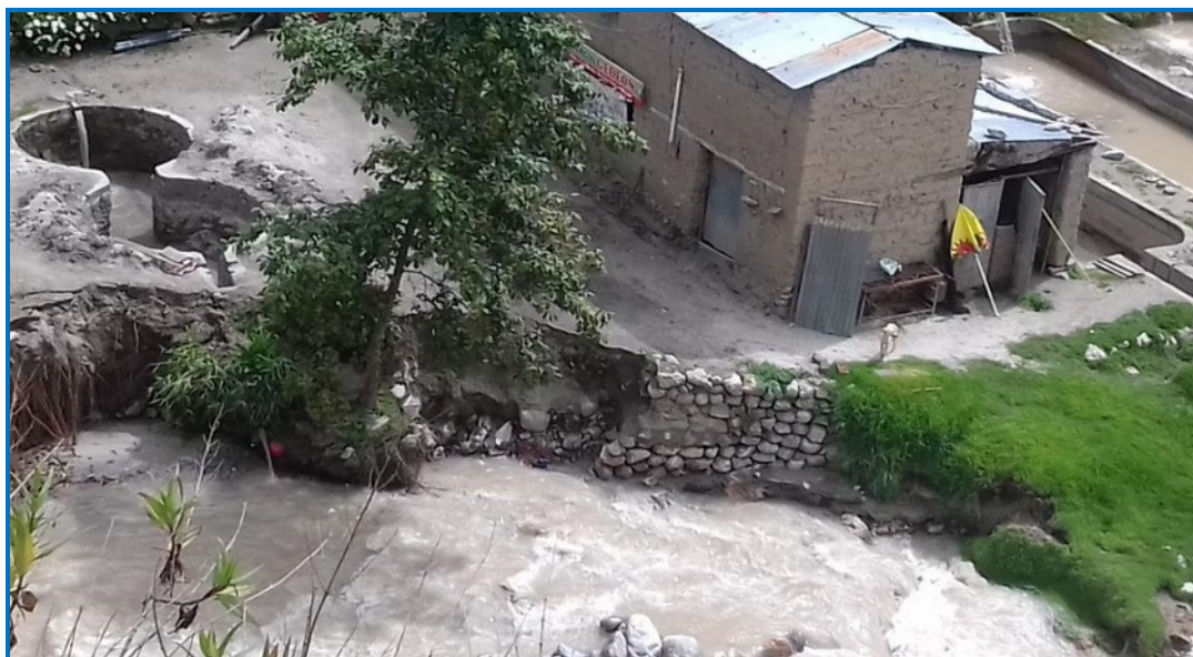
Fotografía N° 3. En la imagen fotográfica se muestra vestigios de inundación y erosión fluvial.
