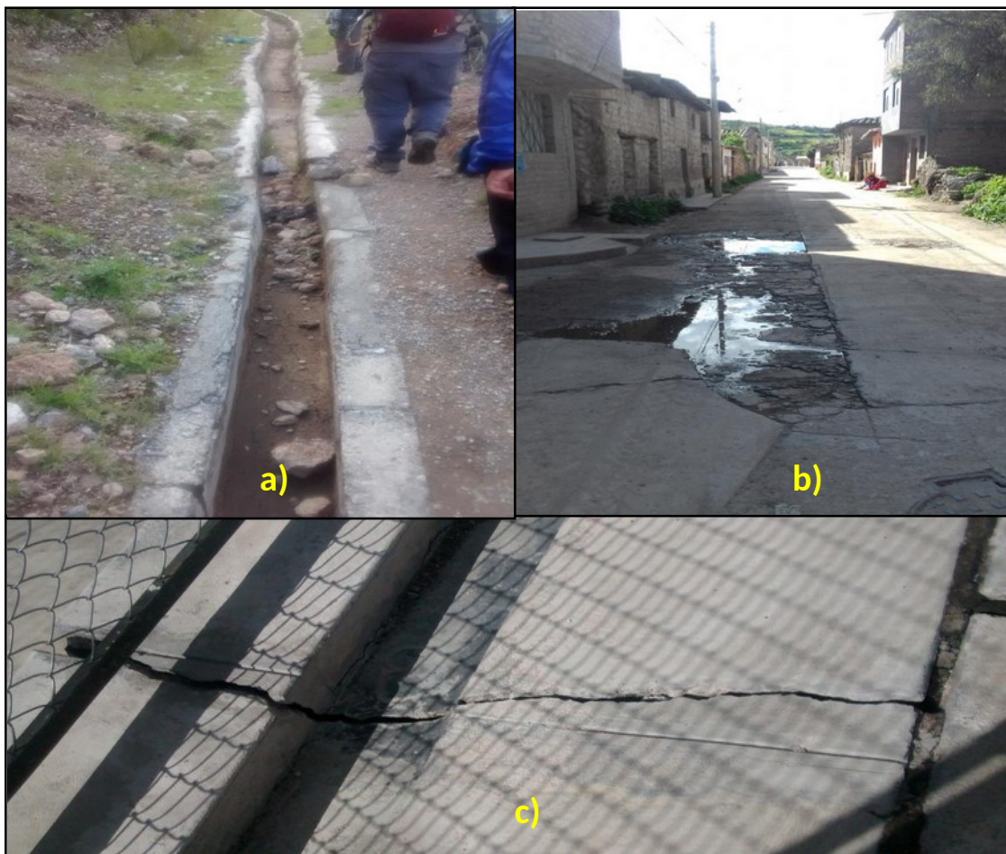
Fotografía N° 9. Infraestructuras en mal estado de conservación: a) Resquebrajamiento del canal San Luis, b) pistas y veredas agrietadas y c) Loza deportiva Maracaná
