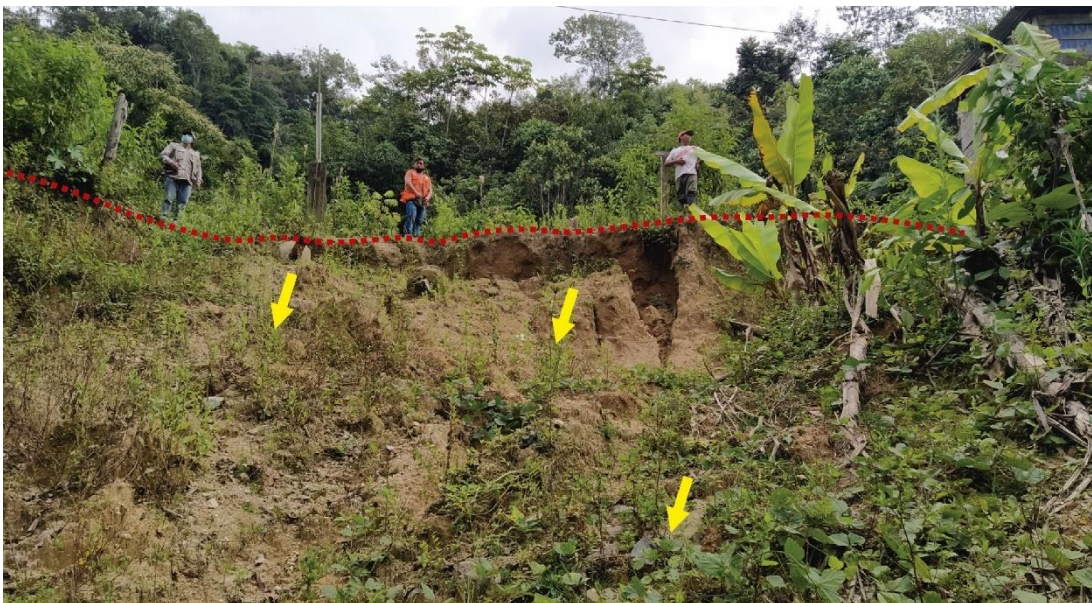
Figura 6. Escarpe del deslizamiento ubicado en la margen izquierda del río Fátima
