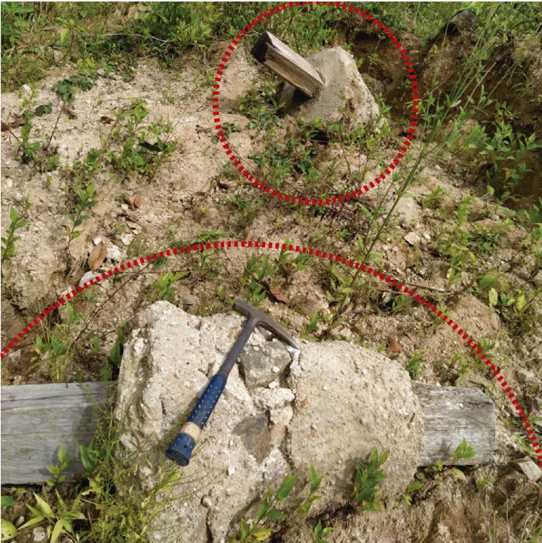
Figura 7. Pilotes de madera, destruidos por el deslizamiento rotacional de la margen izquierda del río Fátima.
