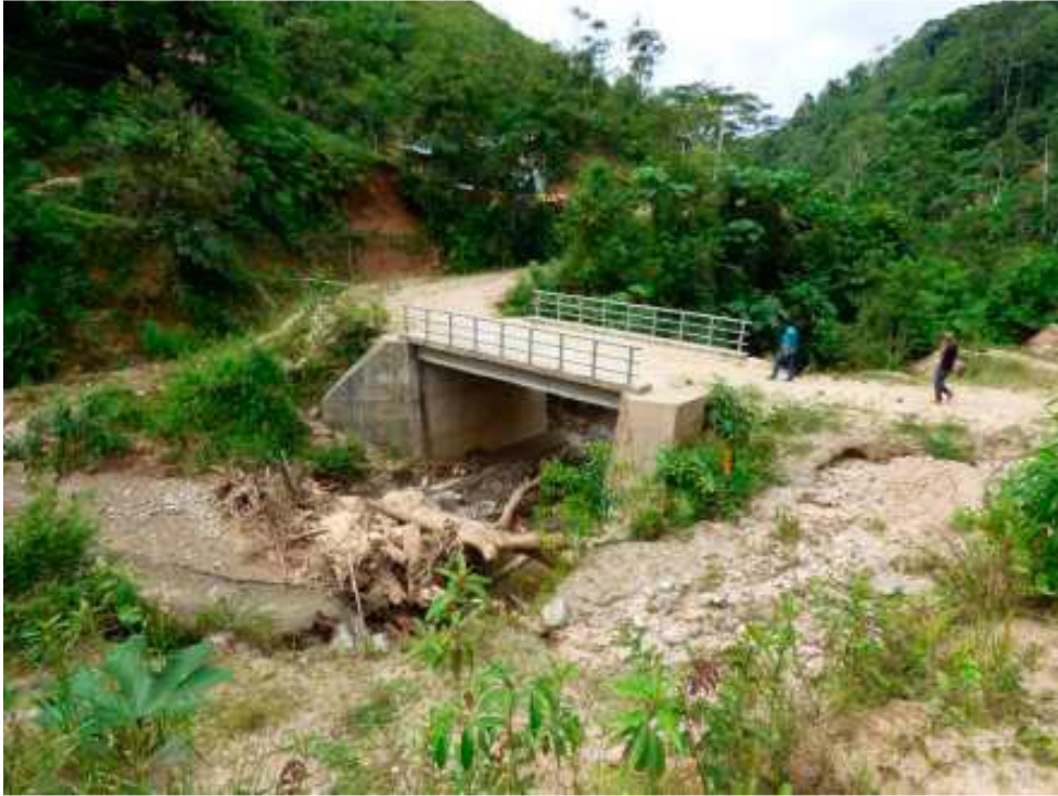
Figura 12. Palizada obstruyendo el puente sobre el río Fátima, sector La Libertad (Fuente: Informe técnico INGEMMET A6710).
