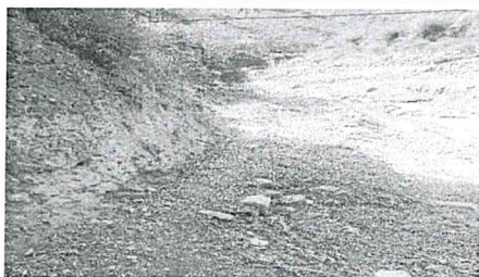
Canal de Riego Afectado por la erosión del cauce de la Quebrada Cochacan
