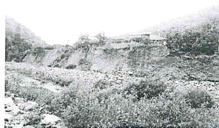
Vista del cauce del rio y la erosión de Margen derecha del Rio Huertas en la localidad de Uchucyacu.
