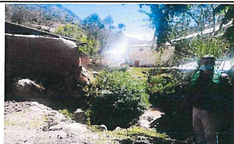
Vista del cauce de la quebrada colmatada y sin defensa ribereña.
