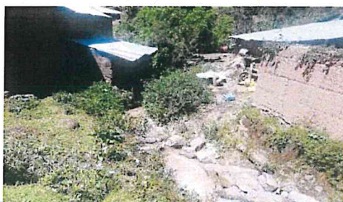
viviendas ubicadas en la quebrada Osapampa
