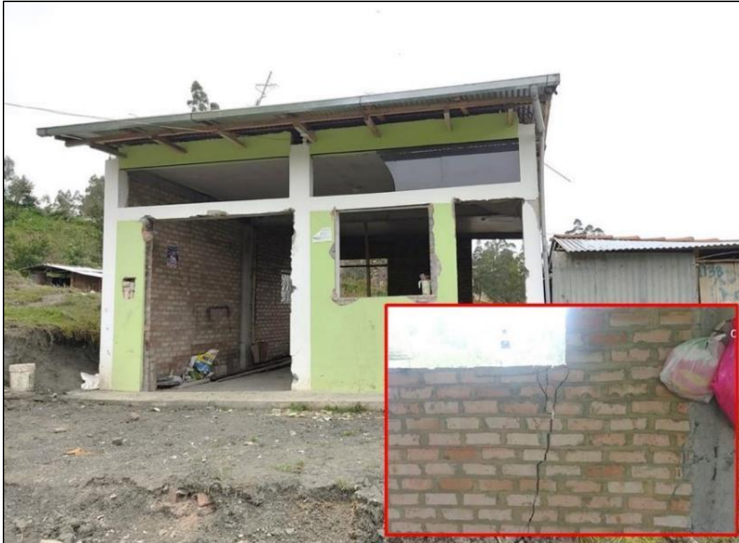
Figura 22. Vivienda afectada por agrietamientos en elementos estructurales de la vivienda (columnas y vigas), así como en muros y pisos. Coordenadas UTM 761766 E – 9273735 N
