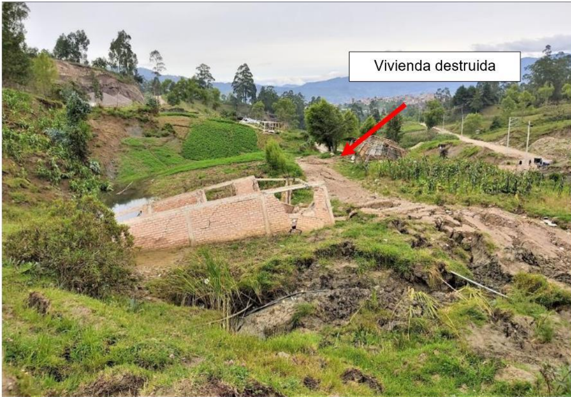
Figura 16. Destrucción de vivienda de material noble, con hundimiento diferencial, la vivienda se encuentra dentro del deslizamiento. Coordenadas UTM 761572 E – 9273805 N
