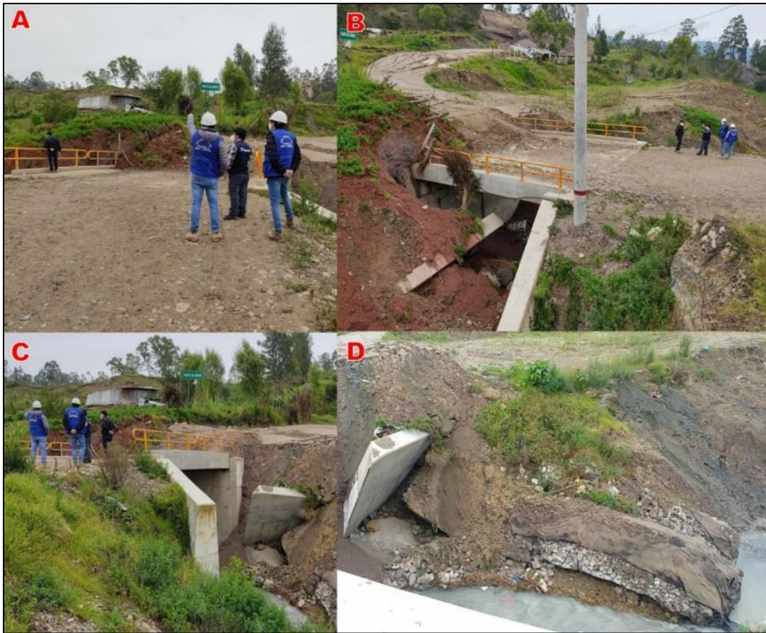
Figura 24. Puente "Las Lagunas" A) y B) en el margen izquierdo de la quebrada se aprecia el colapso del muro de contención por el empuje del deslizamiento. C y D) margen izquierda parte baja del puente, se observa el colapso del muro de contención y el volteo de los gaviones. Coordenadas UTM 761487 E – 9273855 N
