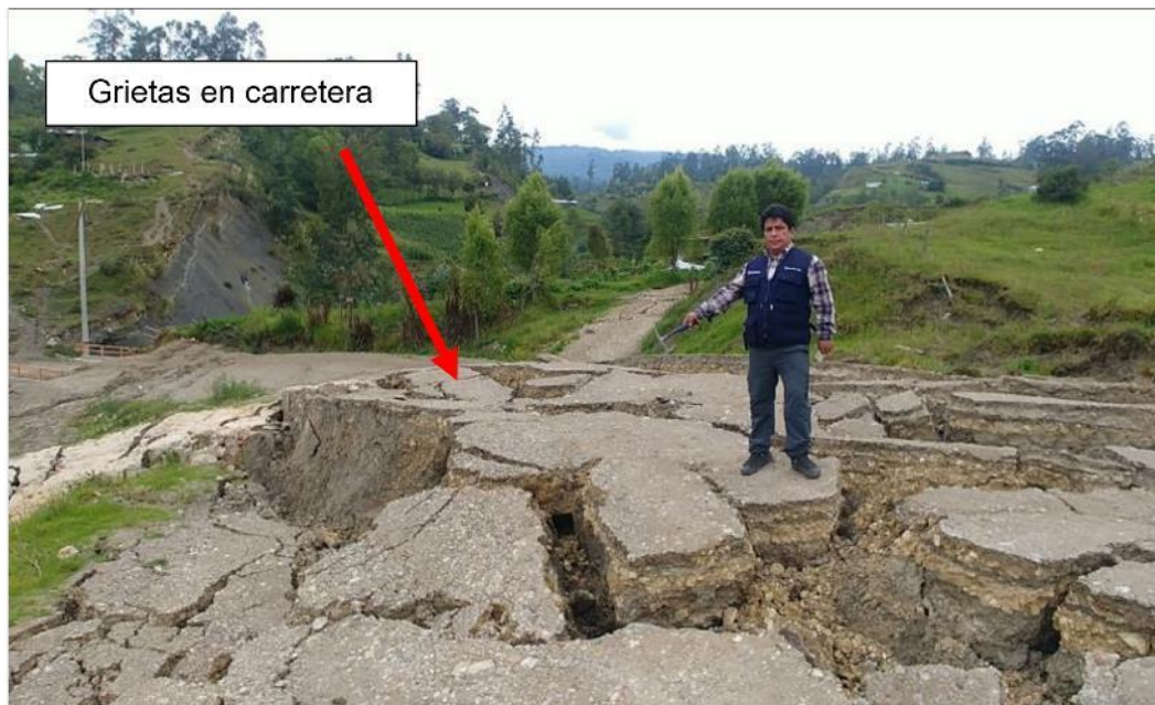
Figura 23. Carretera Chota – Santa Rosa Bajo, completamente destruida, presenta agrietamientos, hundimiento y basculamientos, producto del empuje y acumulación de material desplazado. Coordenadas UTM 761470 E – 9273812 N
