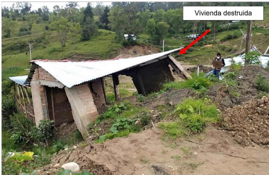
Figura 17. Vivienda destruida, se encuentra en el cuerpo del deslizamiento. Coordenadas UTM 761424 E – 9273805 N
