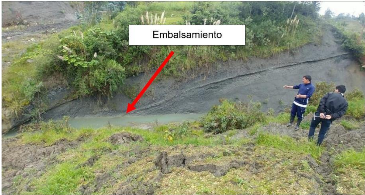
Figura 26. Embalsamiento de quebrada Potrera, el material desplazado proviene margen izquierdo. Coordenadas UTM 761595 E – 9273870 N
