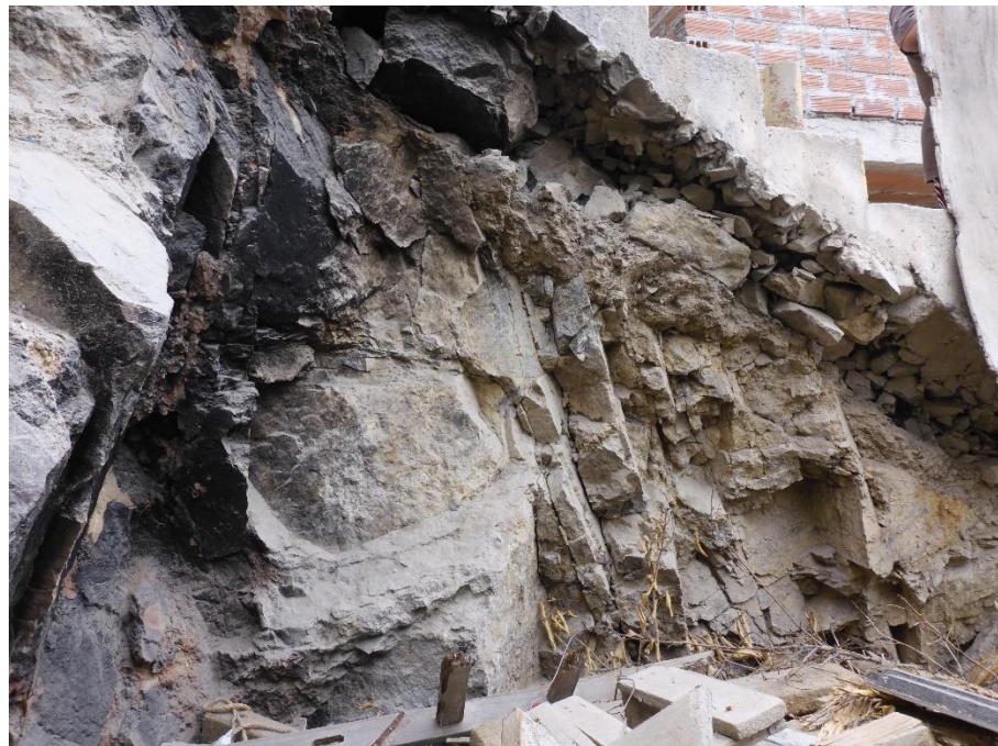
Fotografía 2. Afloramiento de brechas y aglomerados volcánicos medianamente a muy fracturadas, con espaciamentos entre las fisuras de 5 a 35 cm.
