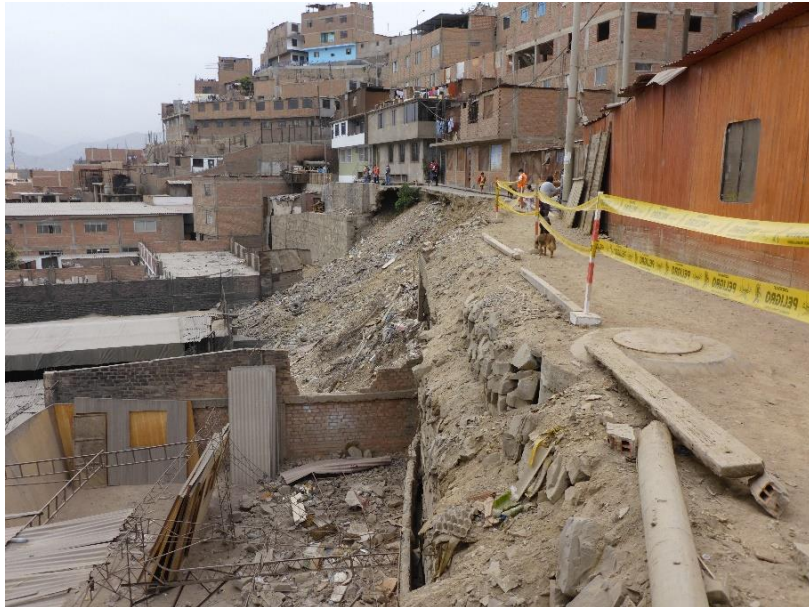
Fotografía 14. Daños generados por el derrumbe en el asentamiento humano. La Milla. Coordenadas UTM (WGS 84): 275335 E, 8670807 N.
