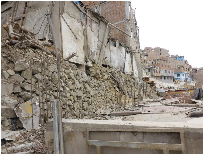
Fotografía 12. Viviendas ubicadas sobre pircas de rocas en el Pasaje Arica. Coordenadas UTM (WGS 84): 275311 E, 8670757 N. Ante un eventual sismo de gran magnitud, estas pircas podrían colapsar afectando las viviendas asentadas en ella y las ubicadas en la parte baja.
