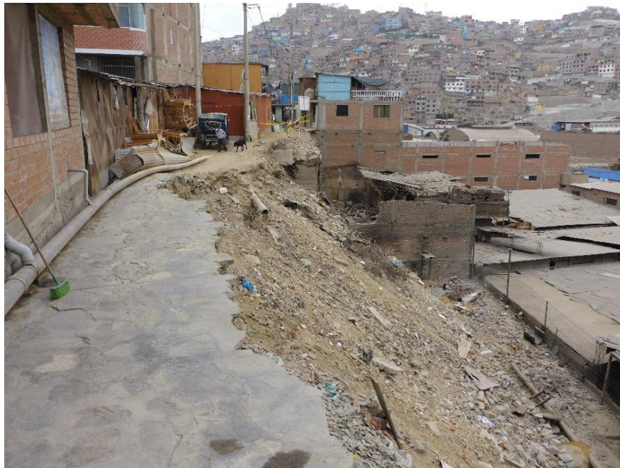
Fotografía 3. Depósitos coluviales originados por el derrumbe en el asentamiento humano La Milla.
