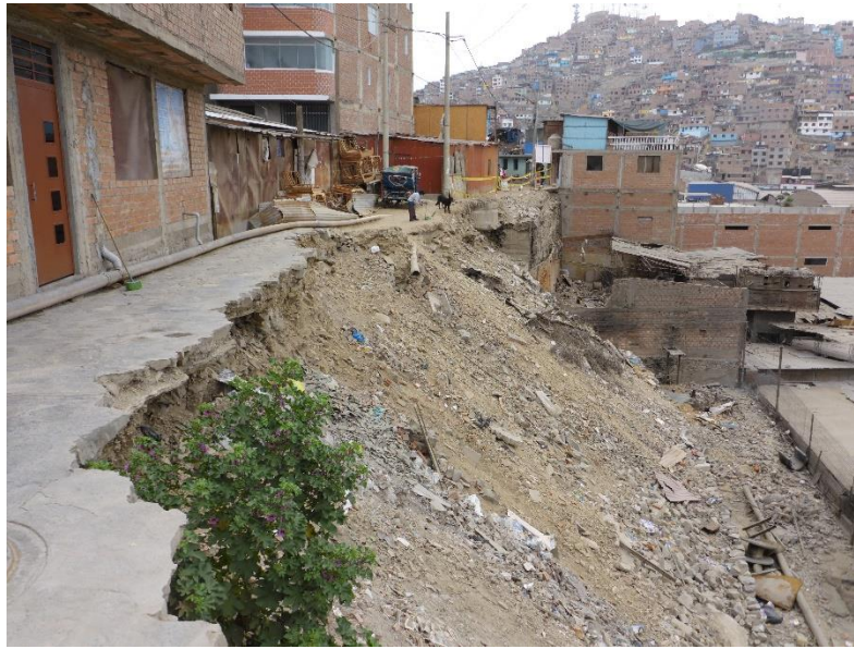
Fotografía 7. Derrumbe identificado en el asentamiento humano La Milla. Coordenadas UTM (WGS 84): 275330 E, 8670810 N.
