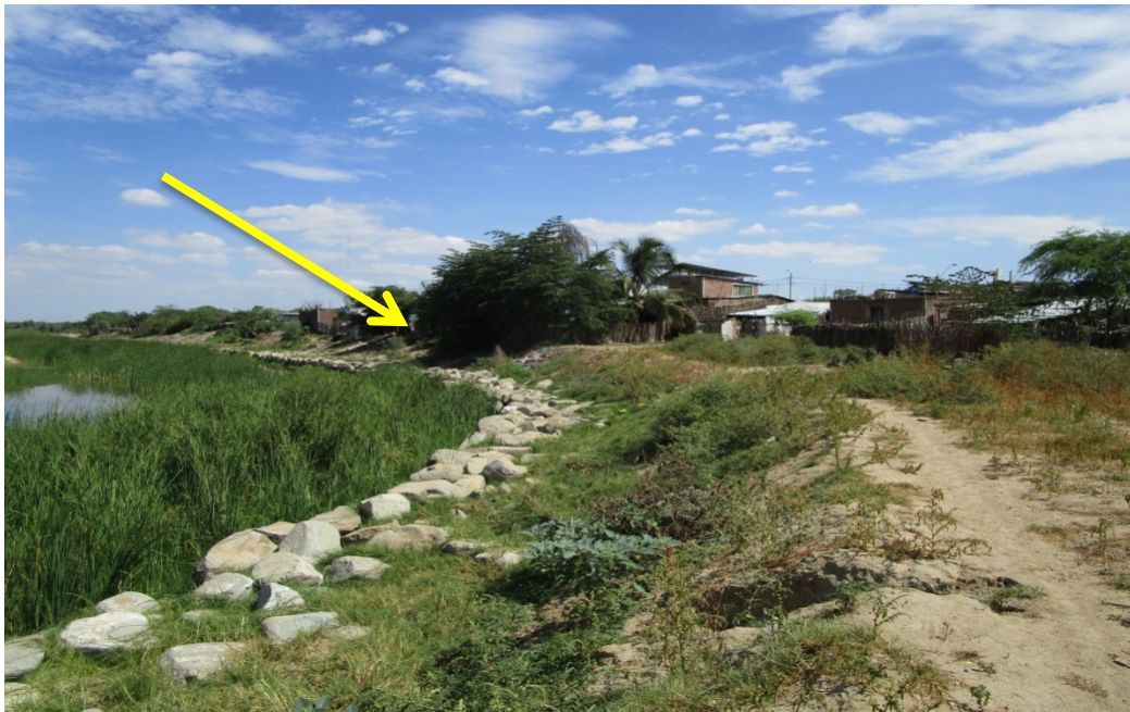
Foto: 11: Viviendas aledañas a la quebrada Carneros (flecha amarilla), las mismas que son afectadas por el desborde de la quebrada en mención. A pesar del enrocado existente, no es suficiente para controlar la erosión de las riveras de la quebrada
