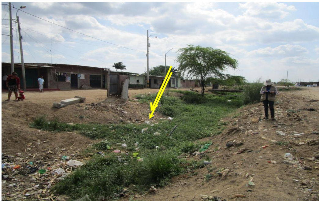
Foto 17: La falta de mantenimiento del canal que pasa por el AA.HH. Ricardo Palma, impide el flujo de las aguas, lo que permite el desborde del canal y afectar por inundación a las viviendas aledañas
