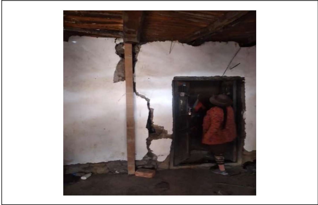
Fotografía N° 6 – Vivienda afectada por el movimiento de la superficie de terreno.
