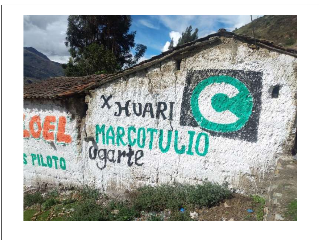
Fotografía N° 5 – Condiciones estructurales de pared y techo en mal estado de un predio del Caserío independiente de Vista Alegre del Centro Poblado de Rancas.
