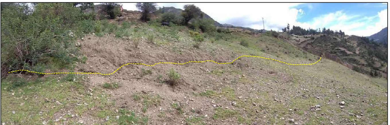
Figura N° 15. Vista de la zona de deslizamiento rotacional en el sector Vista Alegre. Ladera que presenta fracturamiento del suelo y desplazamiento vertical.
