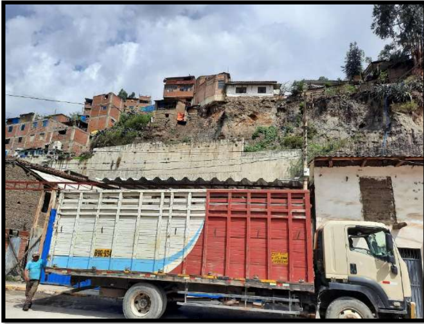
Foto 01. Construcciones sobre el cerro en terreno inestable
