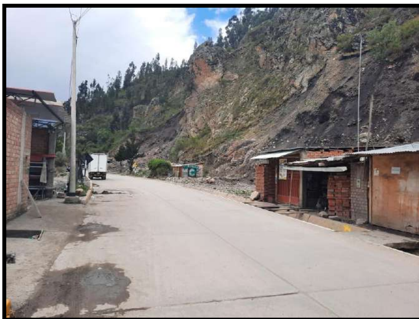
Foto 04. Caída de rocas y desprendimiento del material
