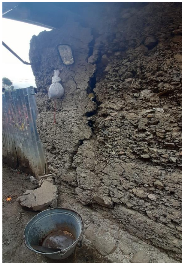
Figura 13. Grietas de 5 cm de ancho identificadas en las paredes de una vivienda
