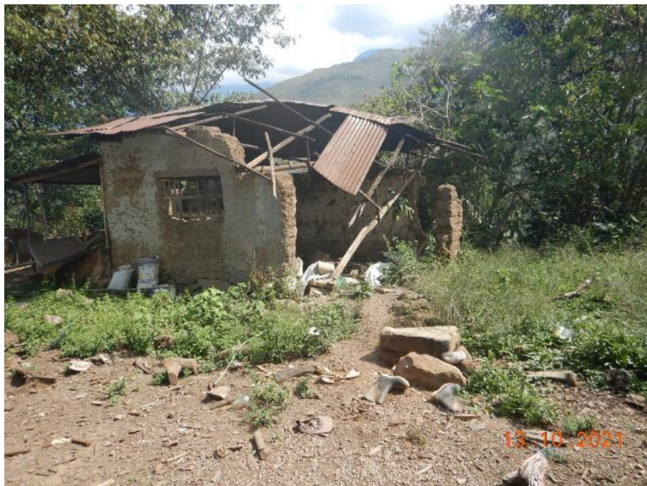
Fotografía 3. Vivienda, afectada el año 2012 en coordenadas UTM: 775679 E, 8575863 S.
