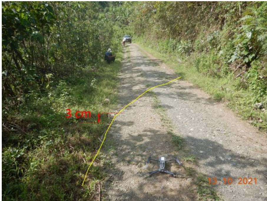
Figura 8. Vista del asentamiento del suelo de 5 cm de altura en la vía Kelcaybamba - Marampampa.
