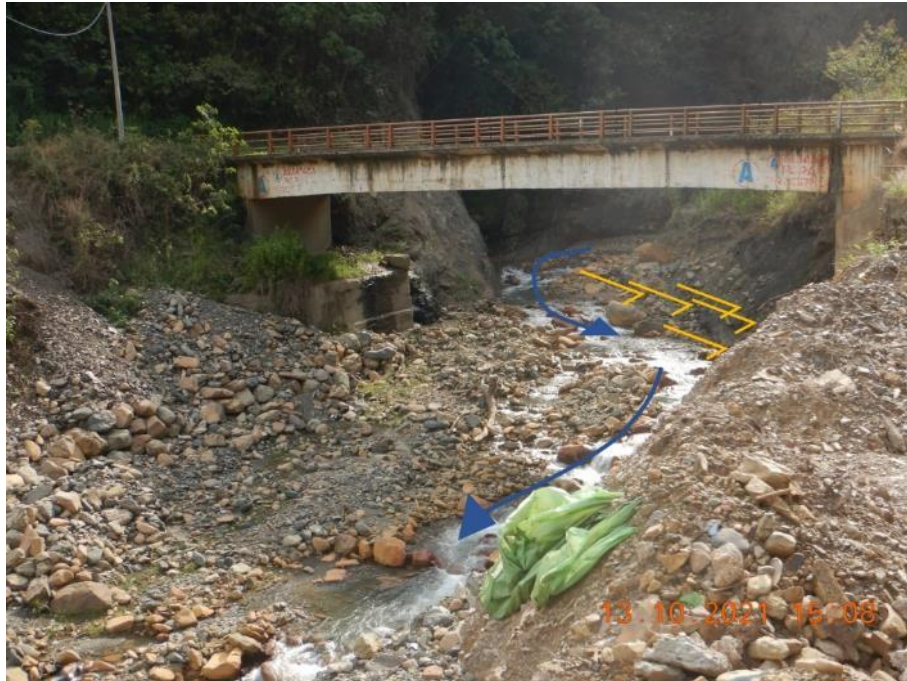
Figura 9. Margen izquierdo del río Piscantillo, la base del puente fue socavada.
