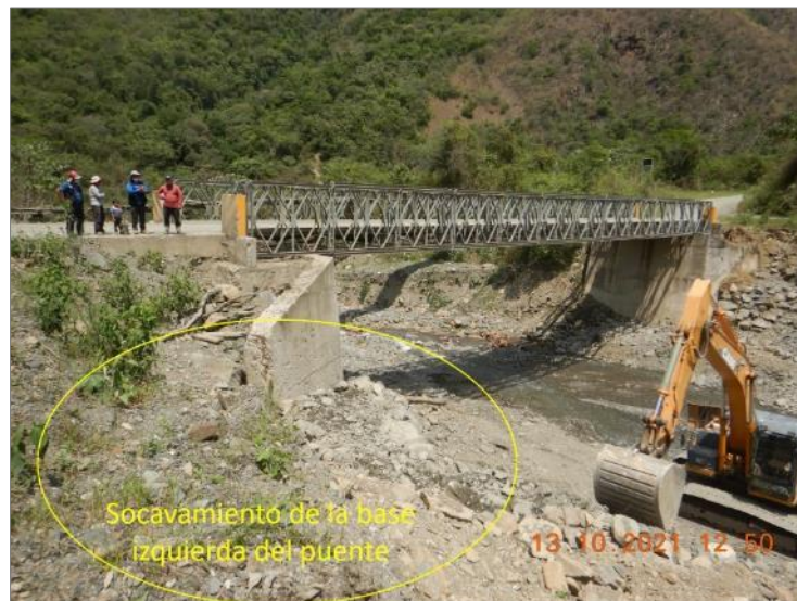
Fotografía 22. Vista de los trabajos que vienen realizando en la base del puente Antibamba, en la parte socavada del puente y en las riberas con diques.
