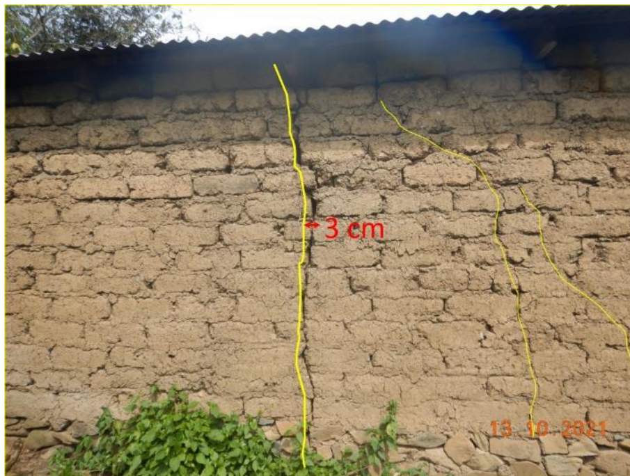
Figura 7. Vista del muro con rajadura de hasta 3 cm de ancho.
