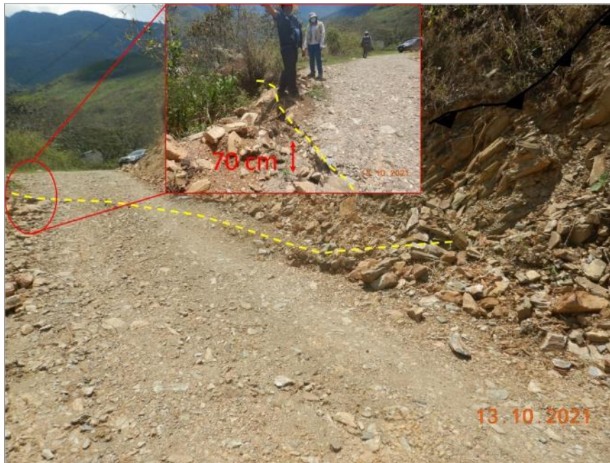
Fotografía 19. Vista de la margen derecha del deslizamiento, donde se aprecia el asentamiento de la carretera en 70 cm.
