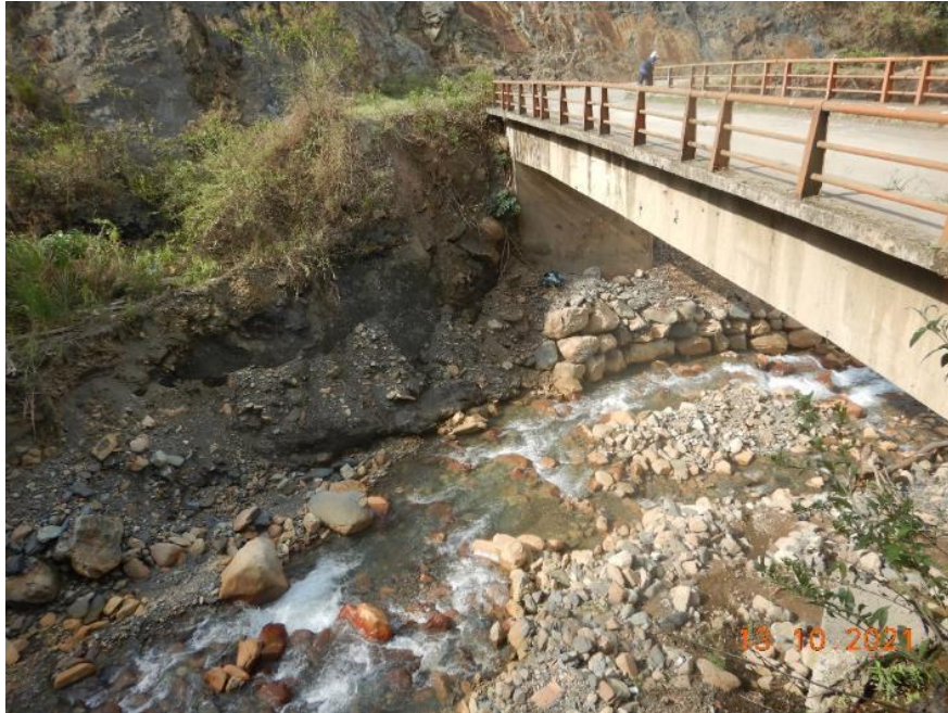
Fotografía 1. Vista al sur, en el puente y la quebrada Piscantillo, se aprecia dos estratos generados por depósitos aluviales, conformados por bloques y gravas inmersos en matriz limo arenosa.
