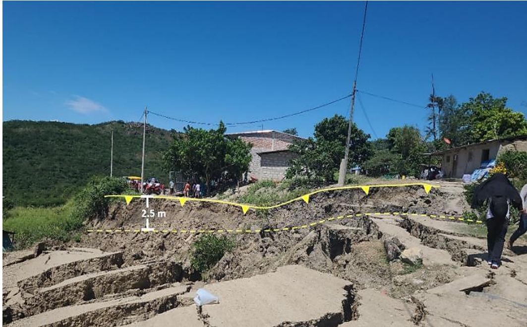
Figura 8. Escarpe ubicado en el flanco derecho, tiene un salto promedio de 2.5 metros. Coordenadas UTM WGS84, Norte: 9385531 – Este: 778833
