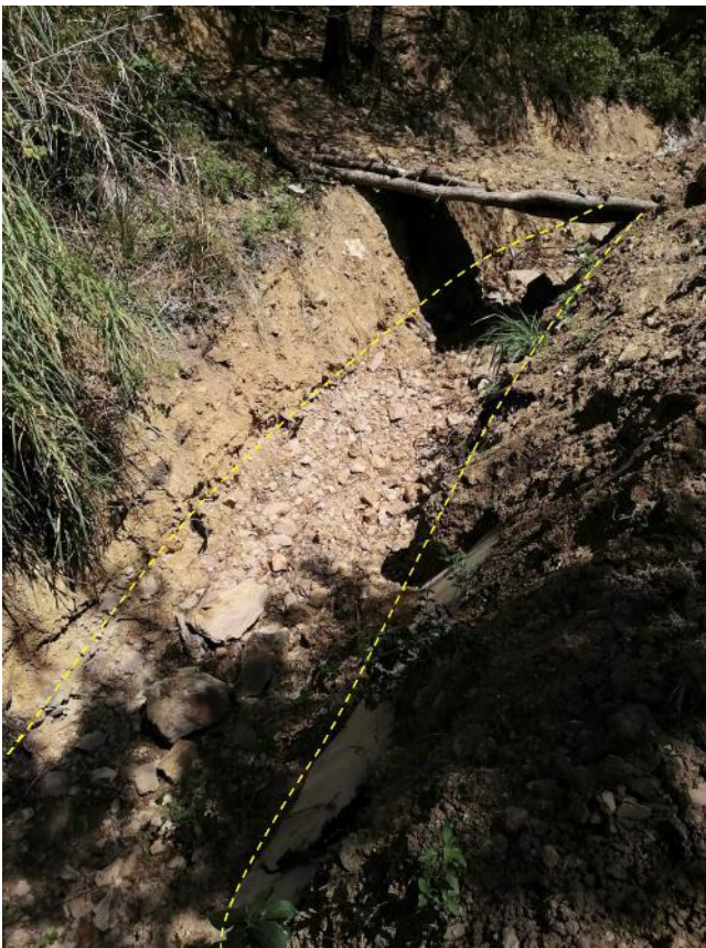
Figura 12. Canal de riego sin revestimiento, se puede observar la falta de limpieza y mantenimiento.
