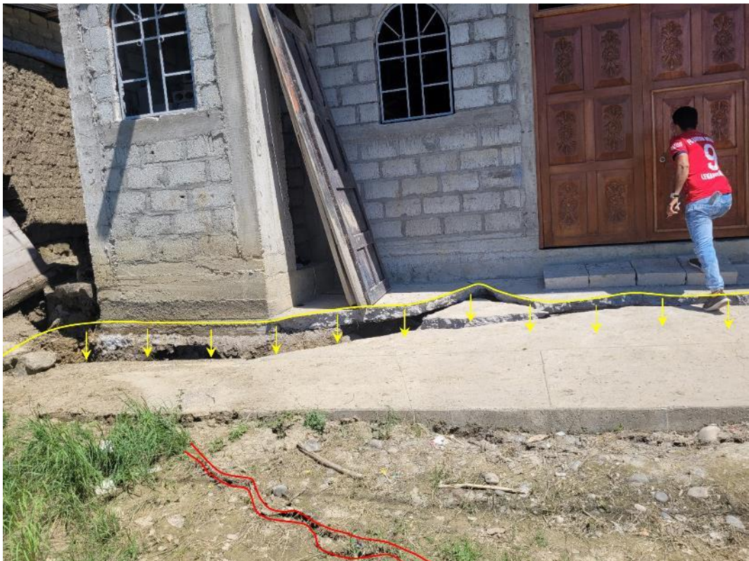
Figura 18. Templo católico afectado por agrietamientos y asentamientos.
