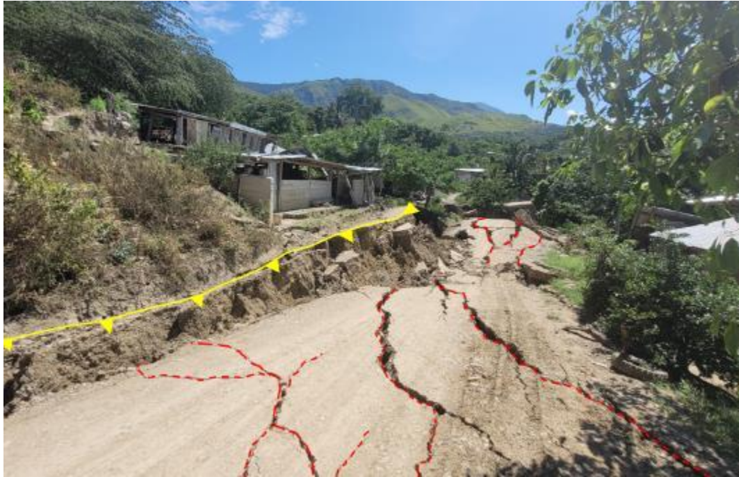
Figura 10. Escarpe secundario y grietas distribuidas en diferentes direcciones dentro del cuerpo en movimiento.
