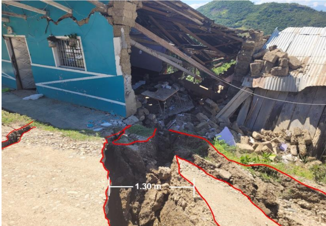
Figura 15. Grietas con un ancho mayor a 1 metro, afecta trocha carrozable y destruyen viviendas.
