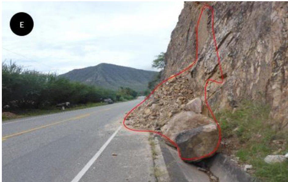
Figura 12. Derrumbe con tipo de rotura mixta, zona de arranque irregular de aproximadamente 5 m y altura 12 m, Características del depósito de canchales, bloques de 0.1 a 1.5m.
