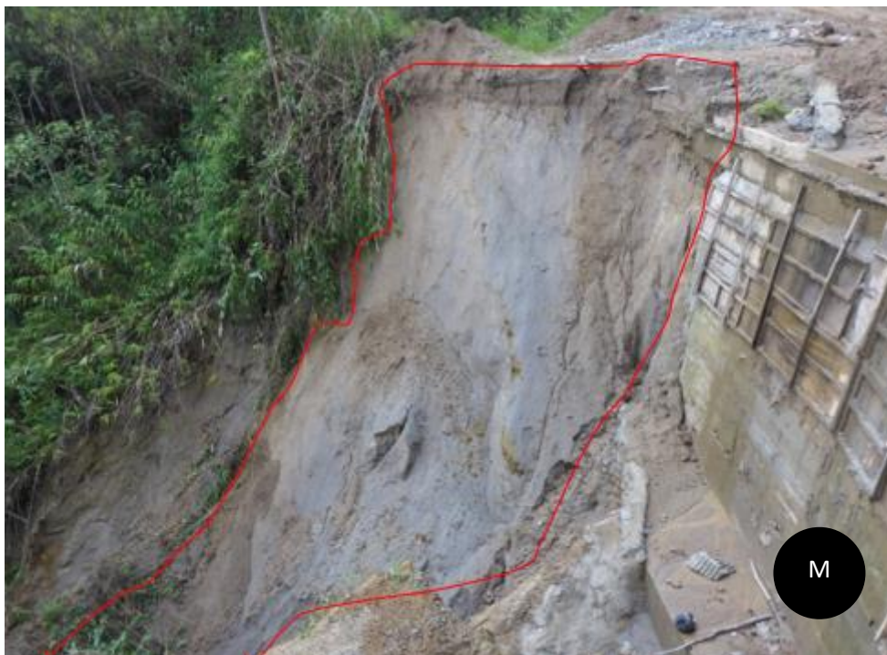
Figura 28. M. Deslizamiento traslacional con forma de escarpe elongada, desnivel entre escarpe y pie de 23m, la superficie de falla es plana, con salto de 10m de escarpa y distribución progresiva. material deslizado ocasionó daños al canal Perlamayo.
