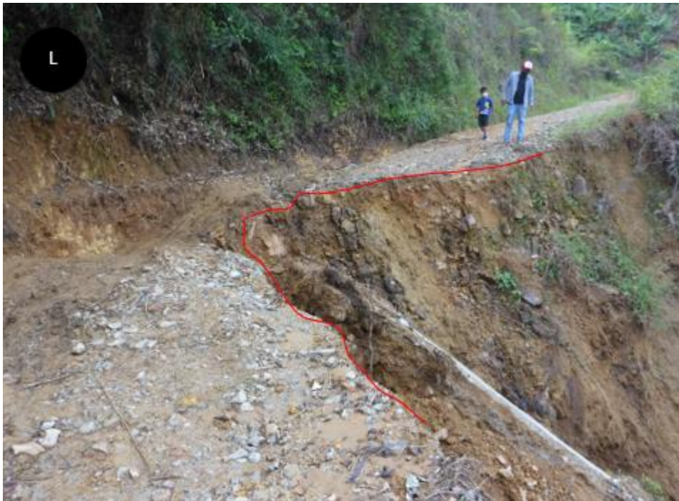
Figura 26. L. Pendiente pronunciada de ladera mayor a 45°, tipo de rotura mixta, forma de la zona de arranque irregular, canchal con bloques de 0.1 a 1 m con un alcance máximo de 15m.
