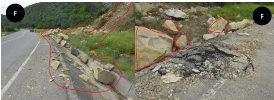
Figura 14. Talud de corte artificial con pendiente mayor a 45°, Características del depósito de canchales, bloques de 0.1 a 1.5m.
