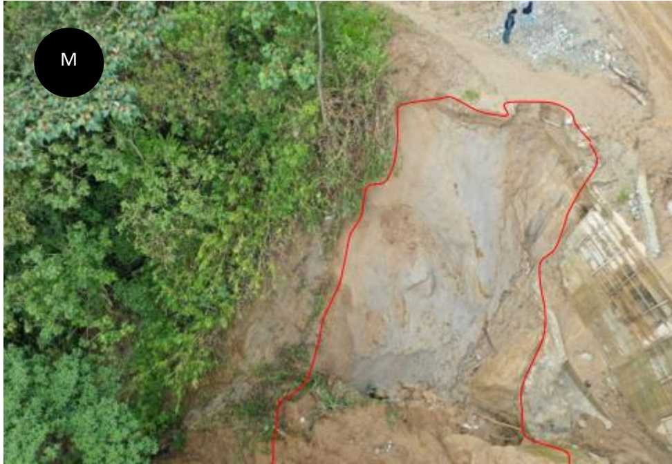
Figura 27. M. Ortofoto de deslizamiento traslacional en Caserío Huaco, Distrito de Huabal (115941066), sustrato de mala calidad, tonalita y granodiorita muy meteorizadas, pendiente de talud mayor a 45°.
