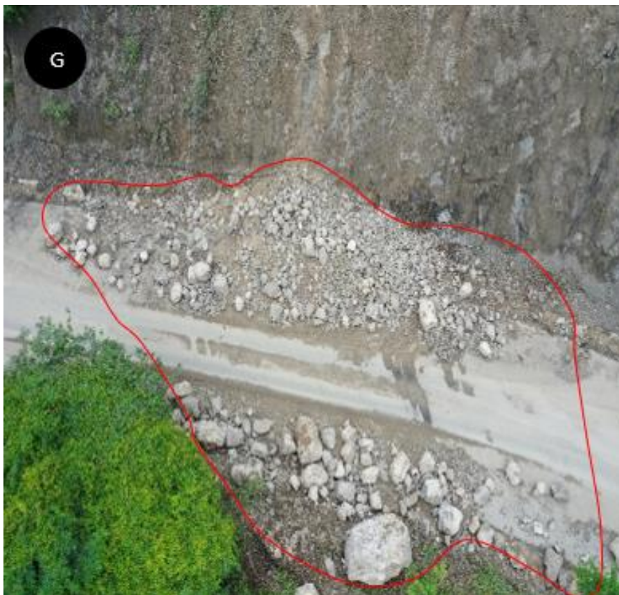
Figura 16. Obstrucción de vía de 150 m de vía, canchales de 0.1 a 2.5 m.
