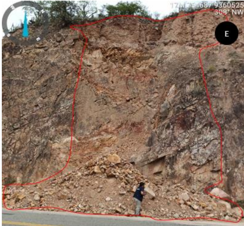
Figura 11. Derrumbe en km 192 de carretera Bagua Chamaya (115921092), talud de corte artificial en sustrato de mala calidad constituido por arenisca de grano medio y limoarcillitas grises, obstrucción de 18 m de vía.
