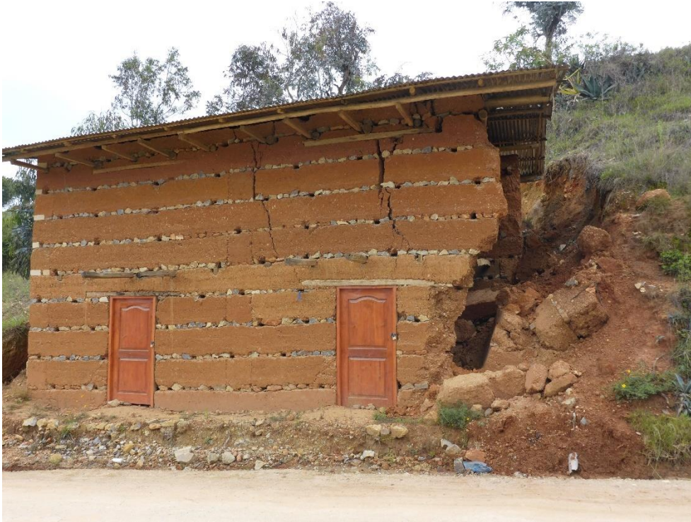
Foto 01. Efectos cosísmico en vivienda del caserío Alto Cumbe provincia Celendín.
