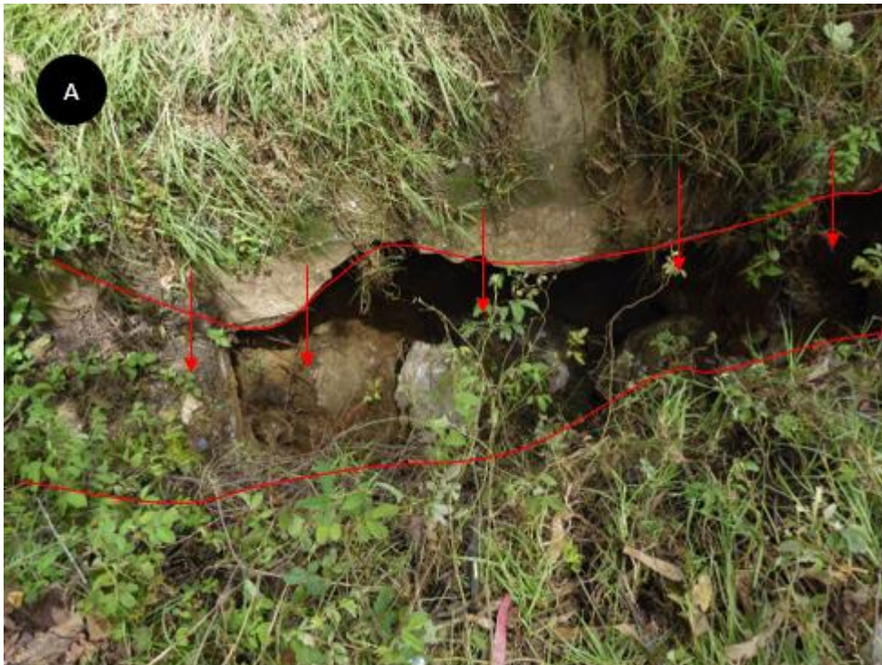
Figura 10. Hundimientos (dolinas) en calizas nódulo arcillosas intercaladas con margas, daños en canal de riego.
