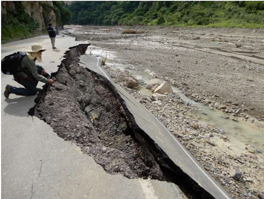
Fotografía 41. Plataforma de la carretera Fernando Belaúnde Terry afectada por la erosión fluvial, post desembalse del río Utcubamba en Aserradero coordenadas UTM WGS-84, Norte: 9348569, Este: 812034.
