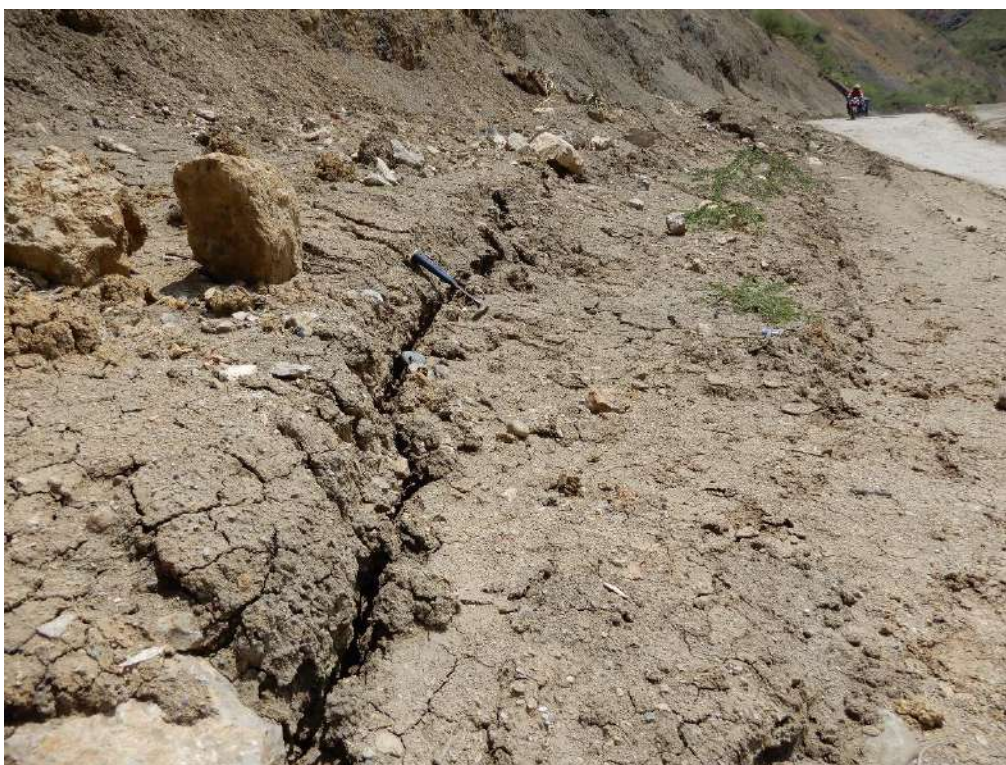
Fotografía 6. Grietas que evidencian la activación de deslizamiento en el Pongo de Rentema que podría afectar el oleoducto y la carretera Bagua - Santa María de Nieva.
