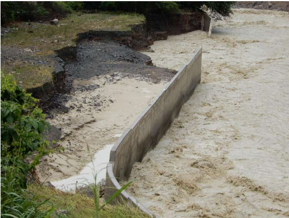
Fotografía 39. Erosión fluvial afectó defensa ribereña de la carretera Fernando Belaúnde Terry en Margen izquierda del río Utcubamba, aguas abajo de Magunchal.
