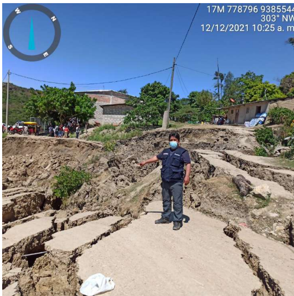
Fotografía 8. Escarpa principal del deslizamiento rotacional de longitud de 500 m y salto de 3 m en el C.P. San Isidro, distrito La Peca.
