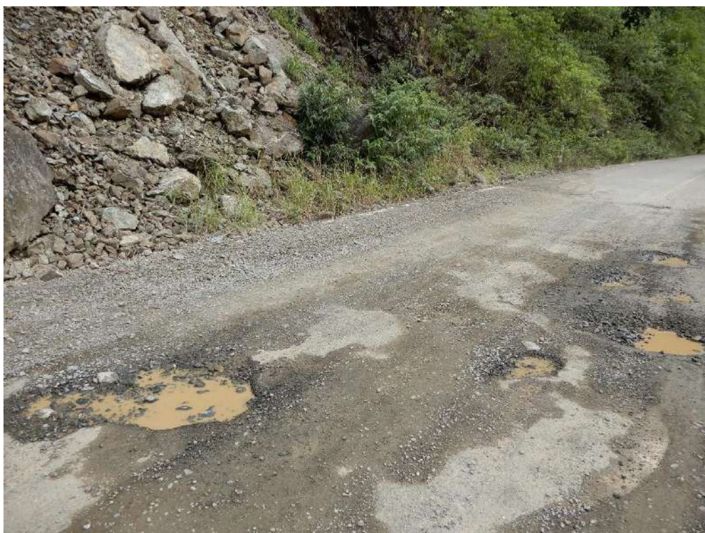
Fotografía 2. Plataforma de carretera Bagua – Santa María de Nieva afectada por el golpe de la caída de rocas, ubicado en la margen derecha del río Marañón, aguas arriba de Tutumberos.
