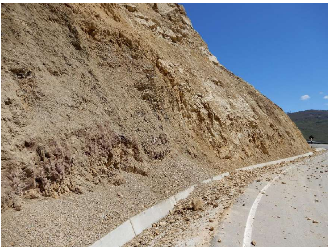
Fotografía 21. Caída de rocas en el sector de Caclic que afectó la carretera Chachapoyas – Luya.
