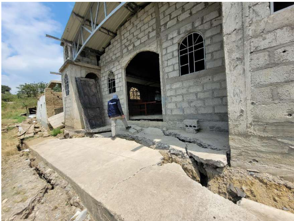
Fotografía 9. Capilla afectada por el deslizamiento en el C.P. San Isidro, distrito La Peca
