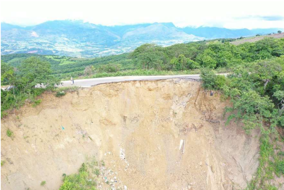
Fotografía 37. Escarpa de deslizamiento de actividad retrogresivo con erosión en la carretera entre Puerto Naranjitos – Pururco .
