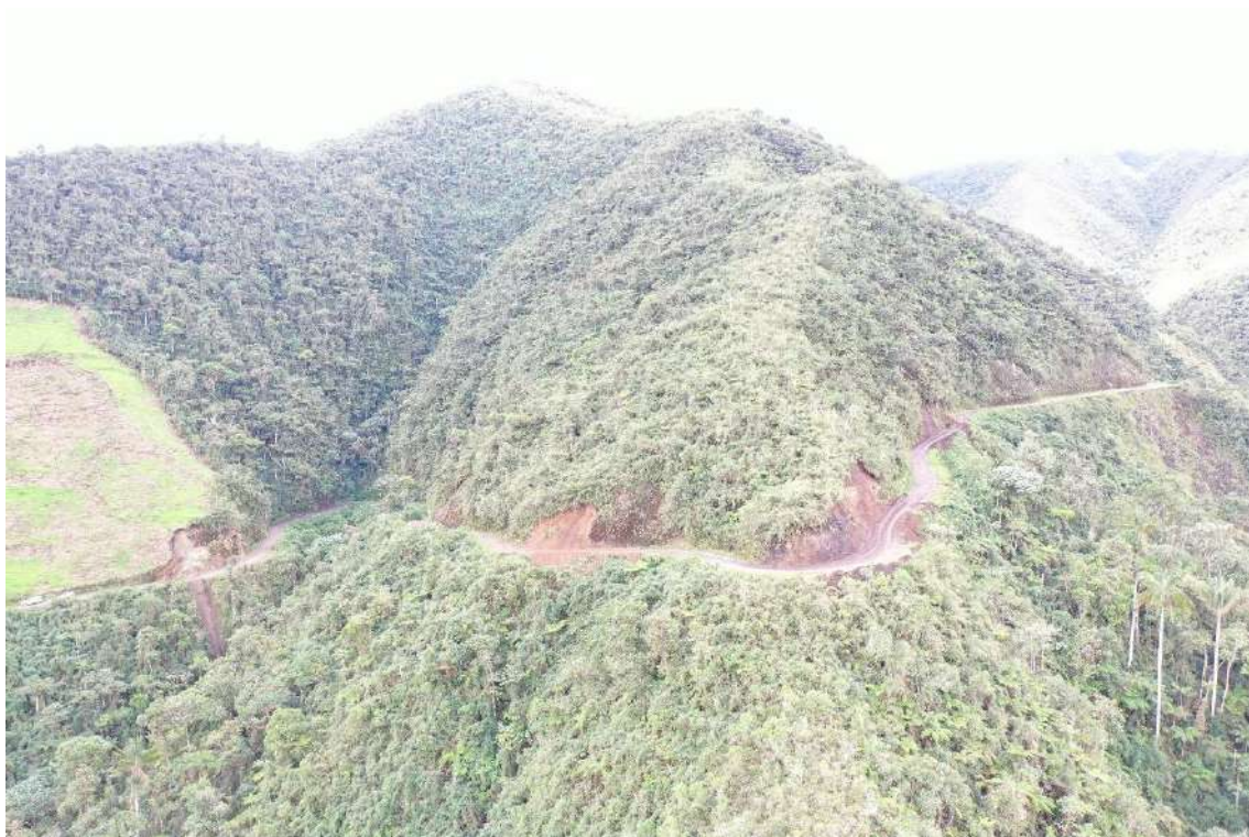
Fotografía 25. Vista panorámica de zona de derrumbes discontinuos que afecta tramos de carretera ubicado entre quebradas Tarasca - Chonia, frente a Vista Hermosa.
