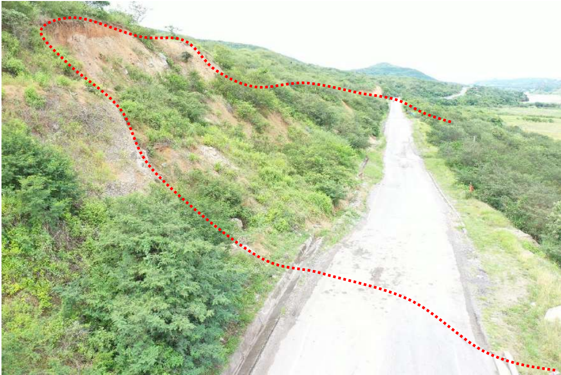
Figura 17. Deslizamiento rotacional ubicado al noroeste de Puerto Motupe, Km 240 de carretera Fernando Belaúnde Terry.
