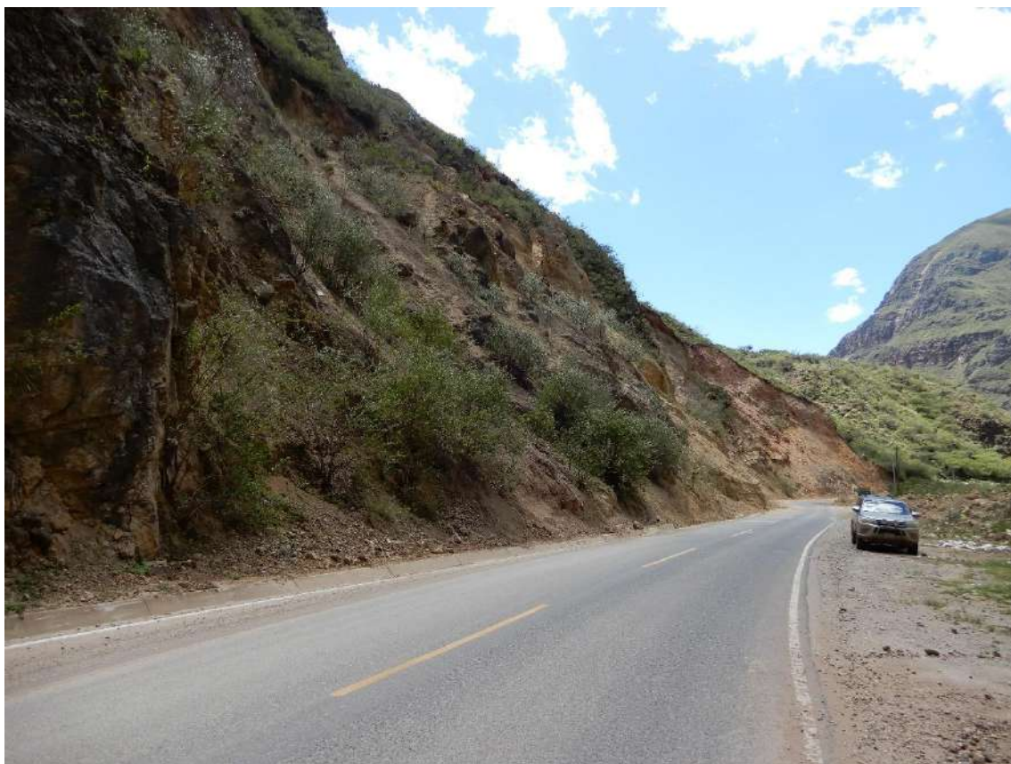
Fotografía 19. Zona de derrumbes y caídas de rocas que podría afectar carretera de la ruta Chachapoyas y Pedro Ruíz Gallo en tramos discontinuos.
