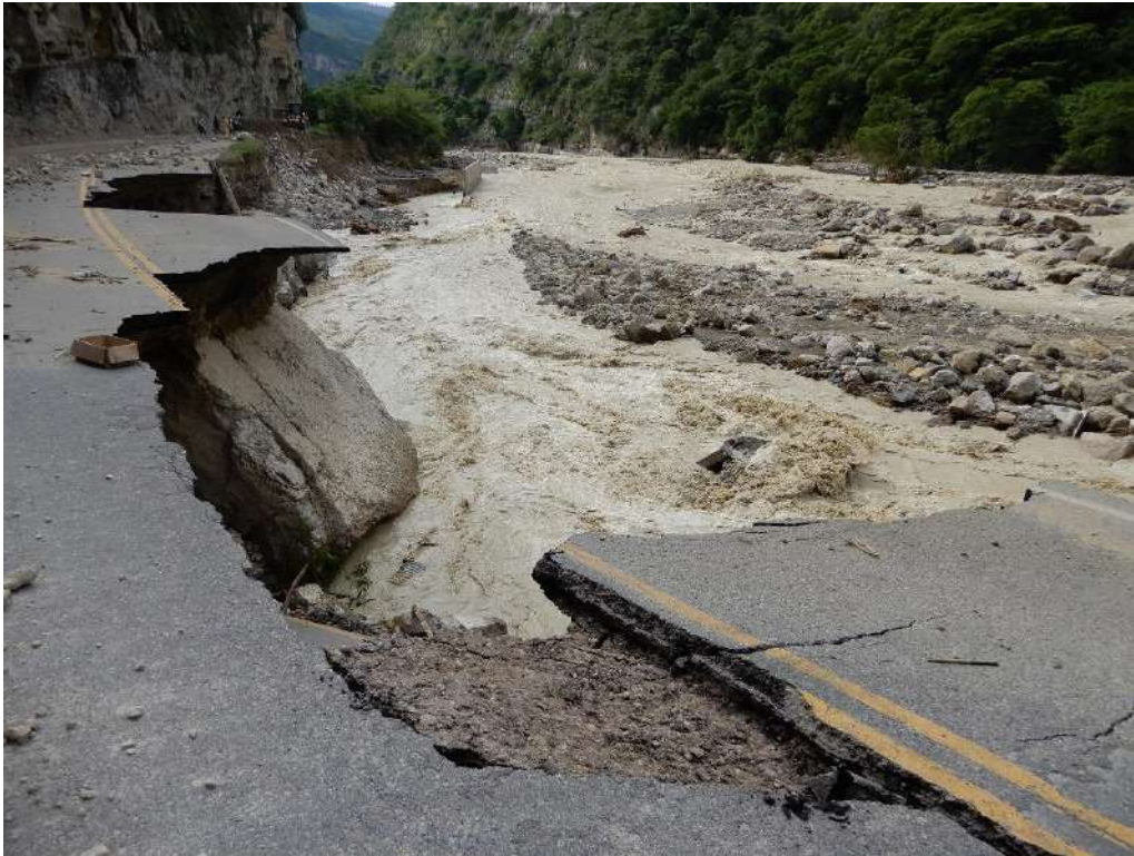
Fotografía 40. Erosión fluvial, en la carretera Fernando Belaúnde Terry en Margen izquierda del río Utcubamba, agua arriba de Magunchal.
