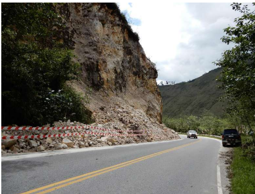
Fotografía 11. Derrumbe en la carretera Fernando Belaúnde Terry, entre el Km 316 y Km 317. Quebrada Chido.
