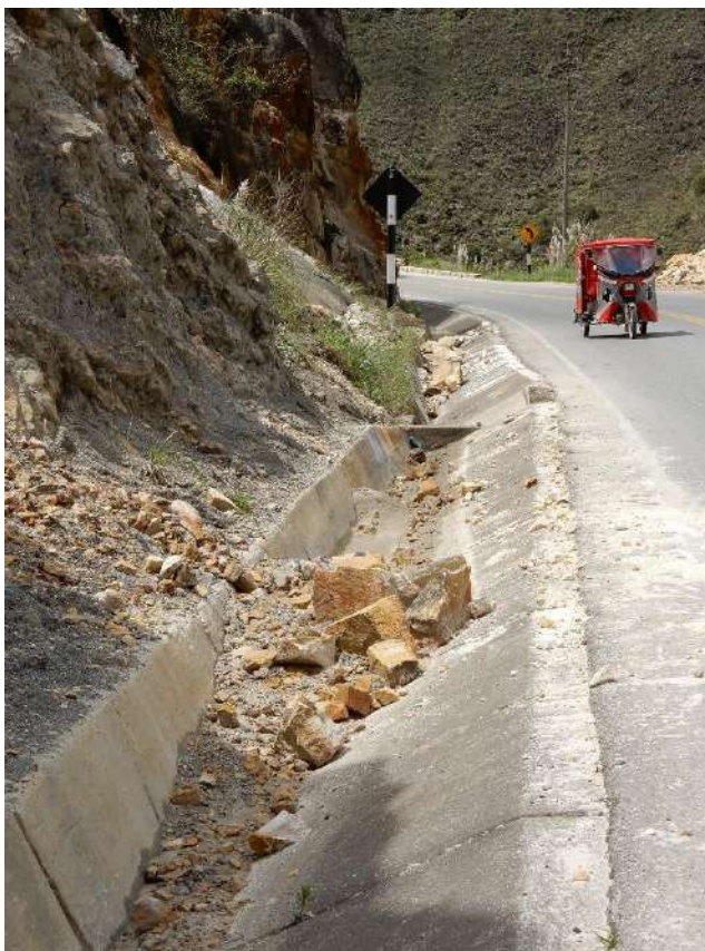
Fotografía 10. Caída de rocas en cuneta de la carretera Fernando Belaúnde Terry, Quebrada Pomacocha.
