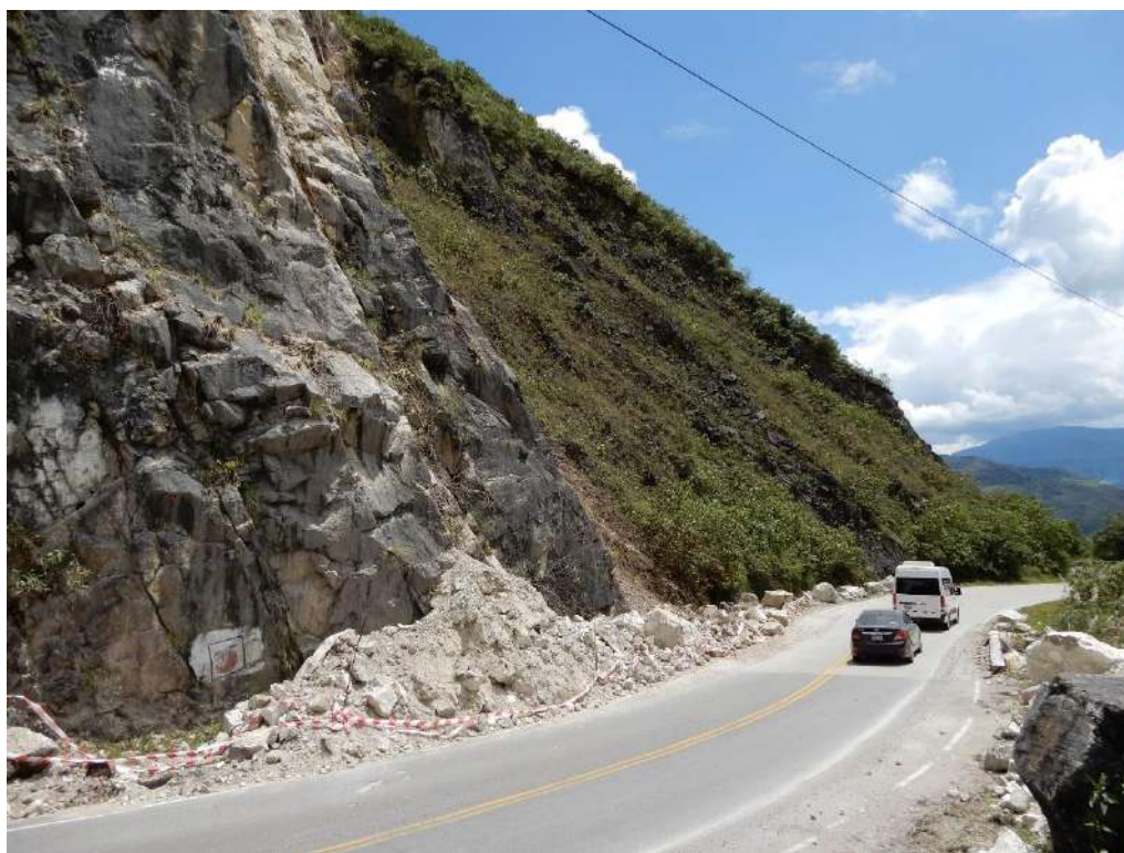
Fotografía 13. Derrumbe que afectó la cuneta y la plataforma de la carretera Fernando Belaúnde Terry, entre el Km 314 y Km 315. Noroeste del sector Carrera.
