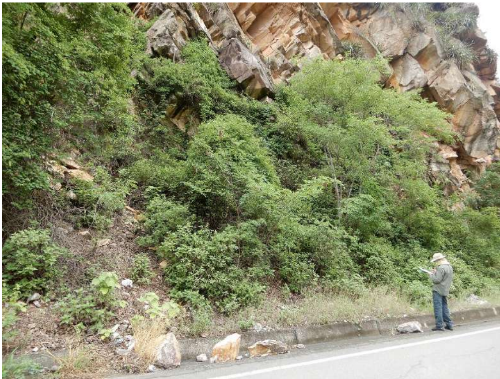
Fotografía 5. Caída de rocas en bloques dispersos que afectó la cuneta de carretera en el tramo e Rentema- Magdalena, margen derecha del río Marañón.
