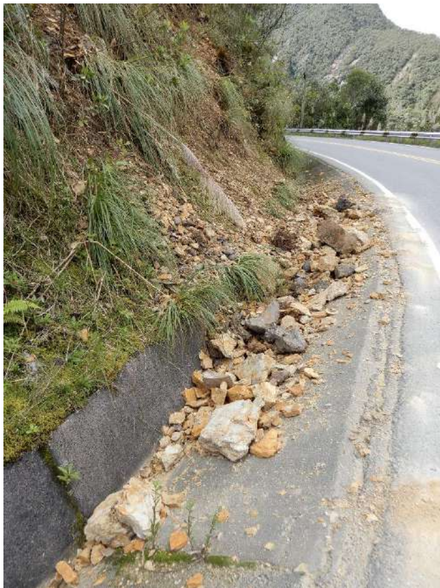
Fotografía 16. Caída de rocas ubicado al Suroeste de Alto Nieva que afectó la cuneta de la carretera Fernando Belaúnde Terry.
