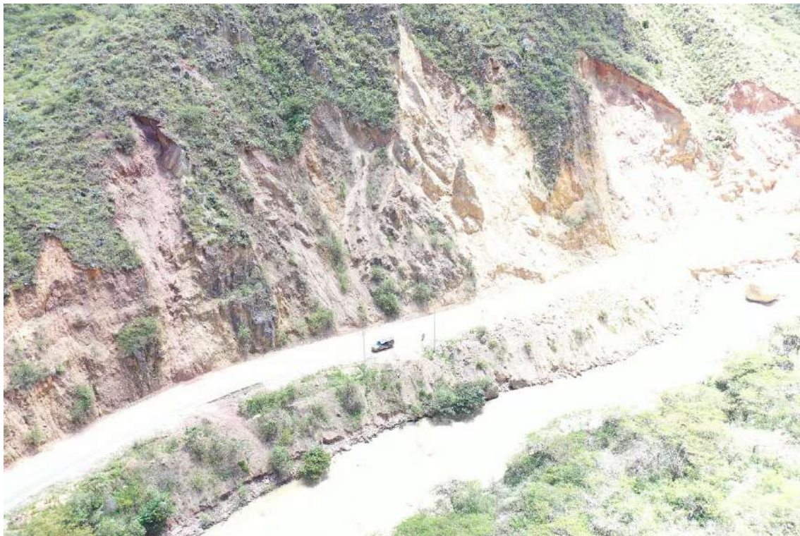
Fotografía 18. Ocurrencias de derrumbes y caídas de rocas que podría afectar 360 m de carretera de la ruta Chachapoyas y Pedro Ruíz Gallo en tramos discontinuos. Ubicado al sur de Yunga, carretera.
