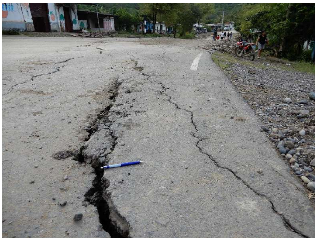
Fotografía 34. Grietas en carretera de ingreso al caserío El Salao.
