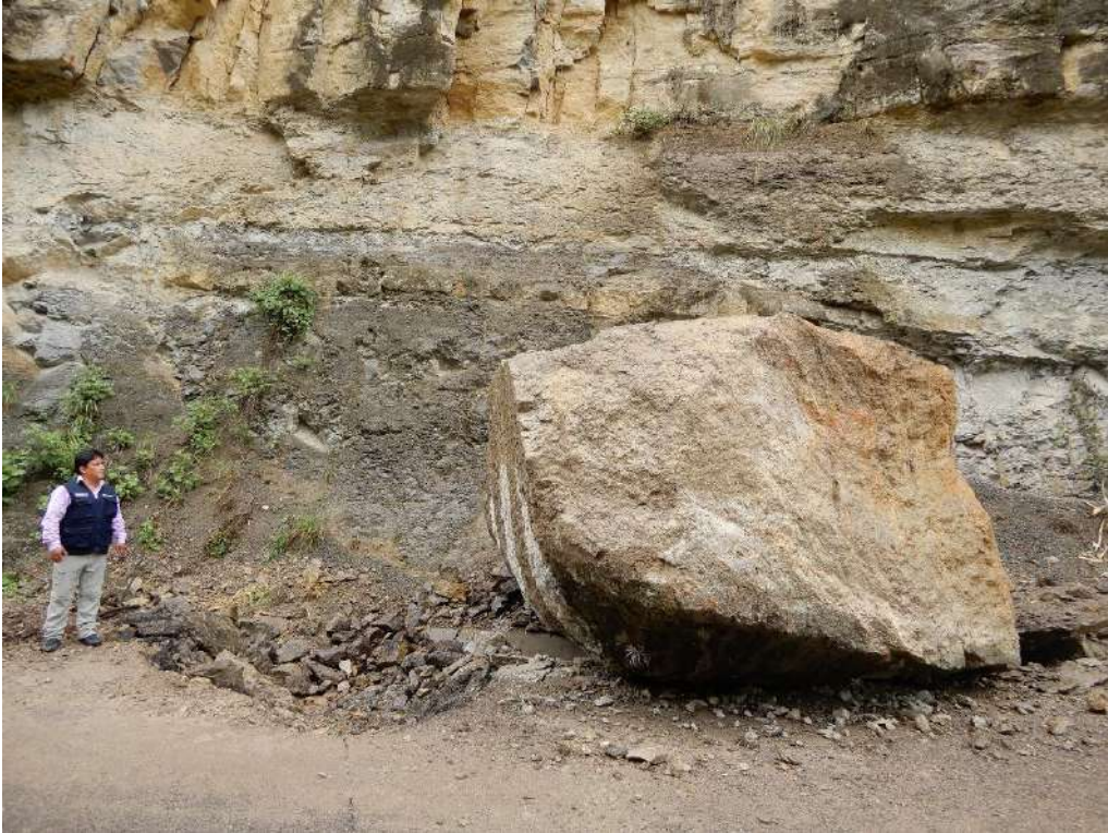
Fotografía 38. Bloque caído de 5 m de diámetro que afectó la plataforma de la carretera Fernando Belaúnde Terry, aguas abajo del sector de Magunchal, coordenadas UTM WGS-84, Norte: 9349226, Este: 809413.
