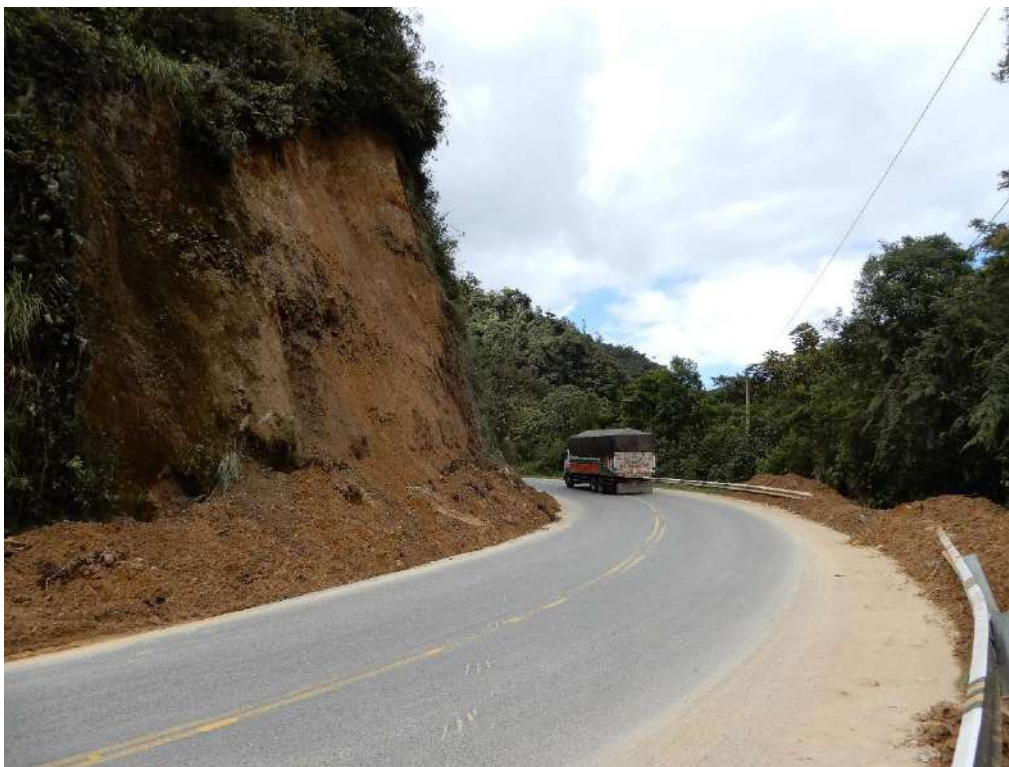
Fotografía 17. Derrumbe ubicado al este de Vista Alegre que afectó la cuneta y la plataforma de la carretera Fernando Belaúnde Terry.
