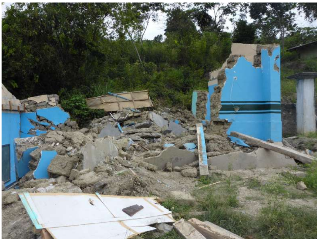
Fotografía 43. Institución Educativa destruida por ocurrencia de deslizamiento en San Martín.
