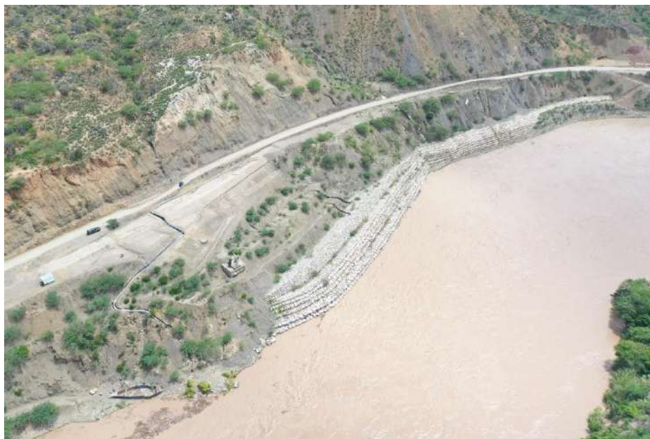
Fotografía 7. Vista panorámica del deslizamiento en proceso de activación en el Pongo de Rentema que podría afectar el oleoducto y la carretera Bagua - Santa María de Nieva.
