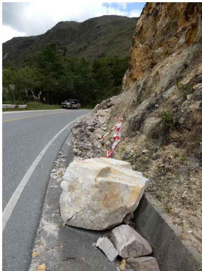
Fotografía 12. Caída de rocas que afectó cuneta en la carretera Fernando Belaúnde Terry, entre el Km 316 y Km 317. Quebrada Chido.
