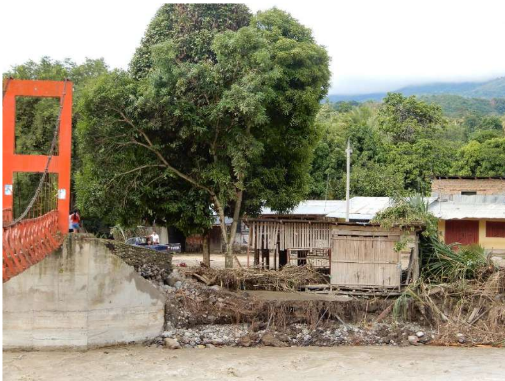
Fotografía 33. Estribo de puente peatonal ubicado en margen derecha del río Utcubamba en el Puerto El Huingo (El Salao) podría ser afectado por la erosión fluvial.
