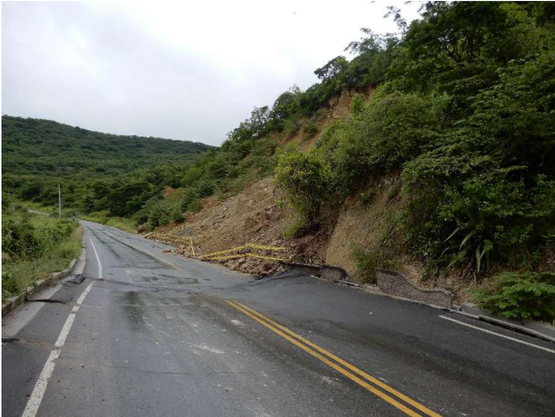
Fotografía 36. Carretera Fernando Belaúnde Terry se aprecia empuje y asentamiento originado por reactivación de deslizamiento.,.
