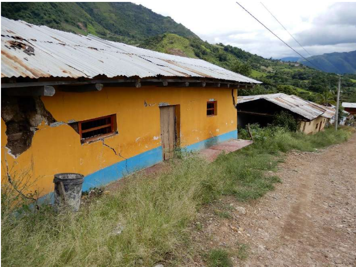
Fotografía 26. Vivienda con grietas en su estructura, por el deslizamiento en el centro poblado Los Patos.
