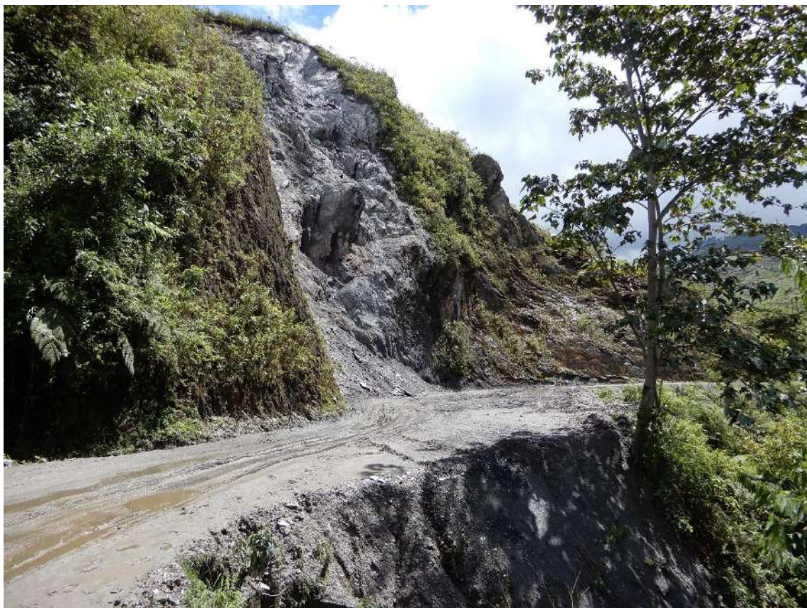
Fotografía 22. Derrumbe que afectó carretera entre San Felipe y Yaulicachi.
