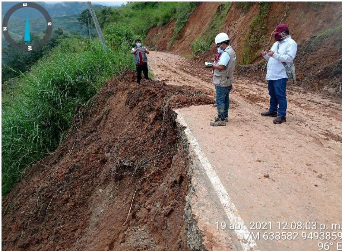
Figura 9: Derrumbe de parte del pavimento que conforma la vía en estudio, evidencia de ello es la inclinación del poste de tendido eléctrico
