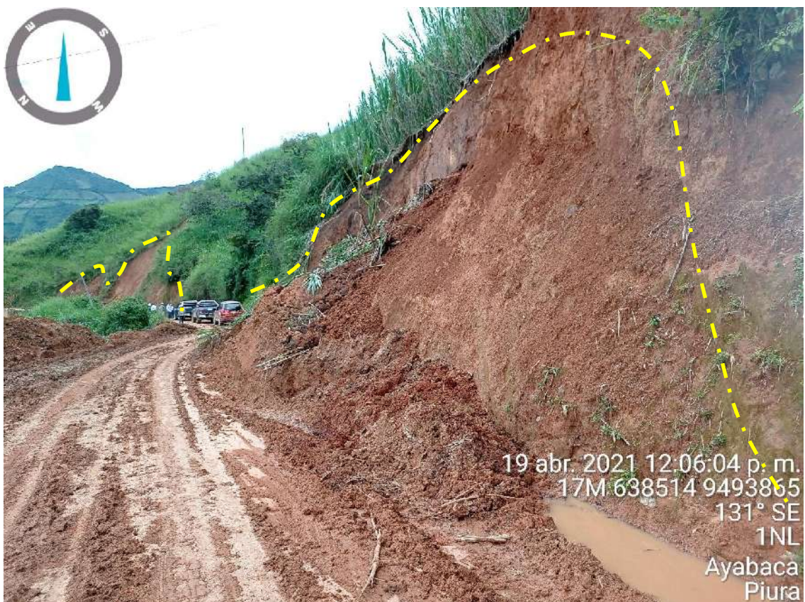
Figura 8: Deslizamientos en los taludes ubicados en las inmediaciones del sector Linderos, los materiales removidos se encuentran sobre la vía asfaltada.
