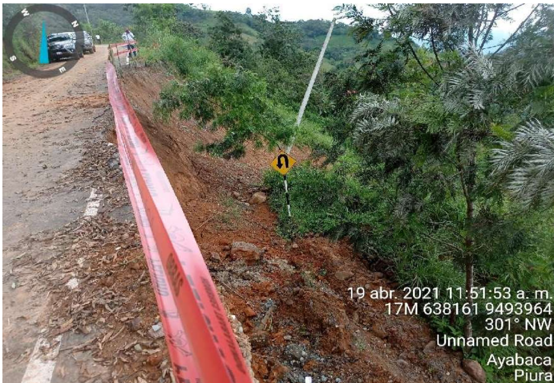
Figura 11: Derrumbe al costado de vía, en las inmediaciones del sector Monterrico
