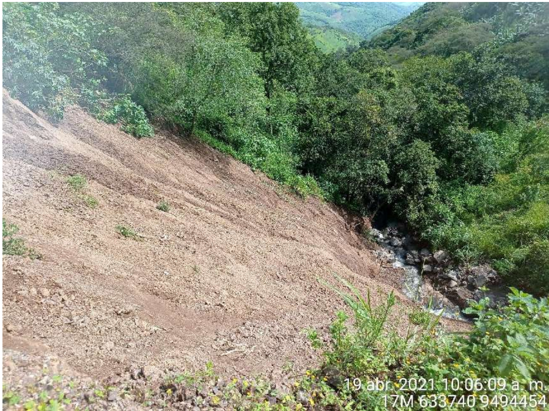
Figura 13: Erosión fluvial de ladera sobre la cual se asienta la vía Jílili – Linderos, en la parte baja de la quebrada Las Vegas
