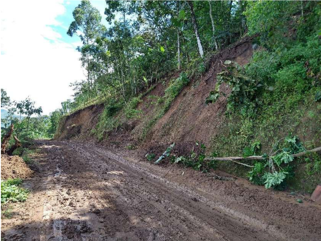
Figura 5: Taludes conformados por suelos arcillosos de pendiente vertical en los cuales han ocurrido derrumbes y deslizamientos debido a la saturación de los materiales que los conforman, se encuentran cubriendo parte de la vía asfaltada.
