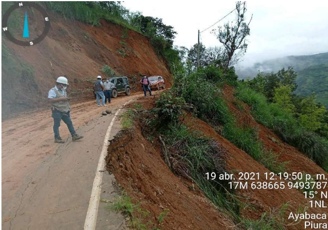
Figura 10: Derrumbe de parte del pavimento que conforma la vía, además se aprecian grietas que podrían incrementar las dimensiones de este evento.
