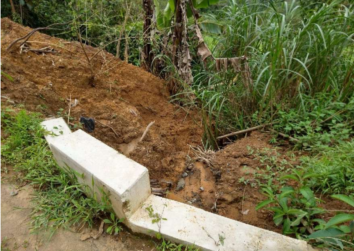
Figura 12: Flujos de agua encauzados mediante infraestructura de drenaje (pontones) para la derivación del agua pluvial que erosionan los suelos que conforman las laderas y generan derrumbes en la vía
