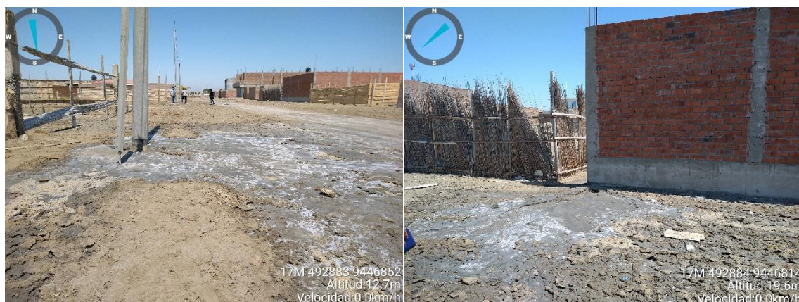
Figura 23: Licuación de suelos en C.P. La Esmeralda de Colán en las inmediaciones de poste y cimentación de edificación
