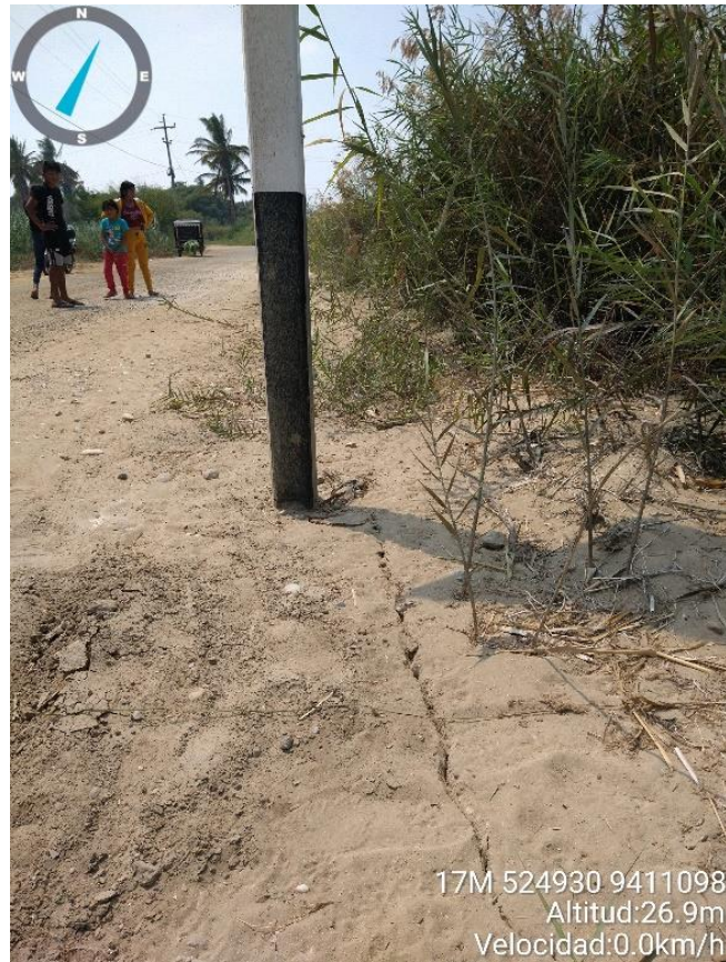
Figura 13: Agrietamiento situado a 0.20 m. del poste de energía eléctrica, C.P Santa Elena
