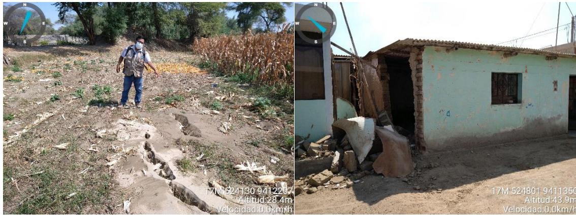
Figura 15: C.P. Santa Elena: Licuación de suelos (izquierda) en áreas agrícolas producto de la saturación en suelos conformados por arenas arcillosas. Derecha, colapso parcial de vivienda de adobe asentada sobre suelos arenosos
