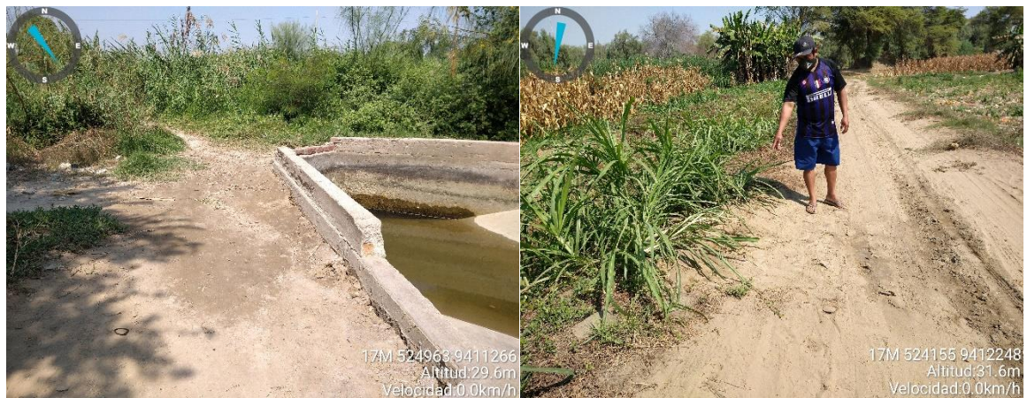
Figura 14: Agrietamiento en el borde de canal de regadío en C.P Santa Elena (izquierda) y en el área agrícola conformada por suelos arcillosos (derecha)
