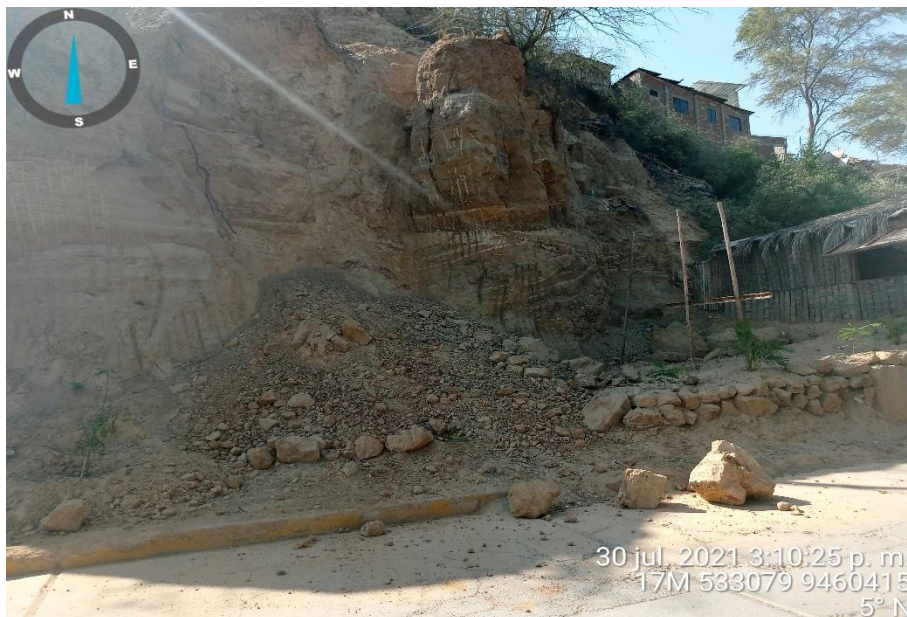
Figura 9.- Derrumbes en la zona contigua a la municipalidad de Marcavelica
