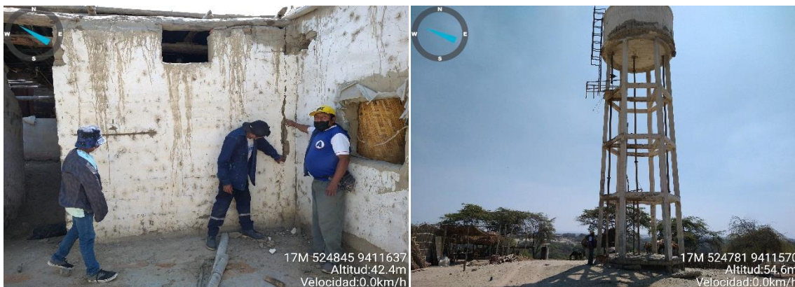
Figura 16: C.P Santa Elena: Fisuras en paredes de vivienda (lado izquierdo) de adobe y reservorio de agua con desprendimiento de cobertura ante el sismo
