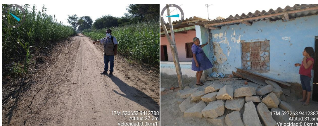
Figura 19: C.P Casa Grande: Agrietamiento (izquierda) en áreas agrícolas de 175 m de longitud en dirección sureste – noroeste y vivienda (derecha) de adobe con grietas
