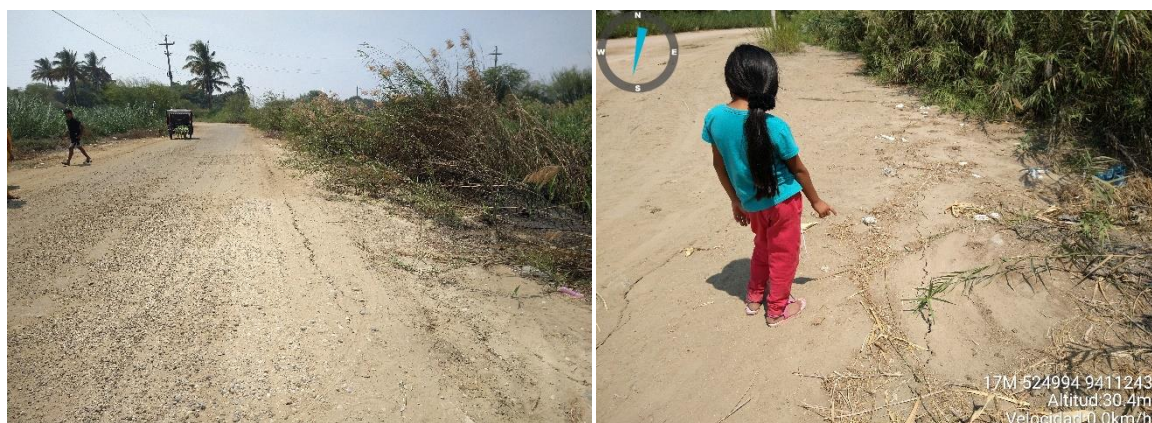
Figura 12: Agrietamientos en el suelo en el C.P Santa Elena: lado izquierdo (longitudes de hasta 16 metro en las coordenadas UTM: 535035 E, 0411246 N) con aberturas de 3 cm y 2 cm. respectivamente
