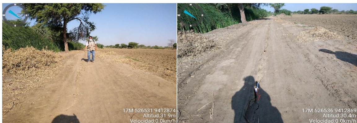
Figura 18: C.P Casa Grande: Agrietamiento (izquierda) en trocha carrozable de 5 cm de abertura y longitud de 175 m y agrietamiento en el suelo de 175 m paralelas a canal de regadío
