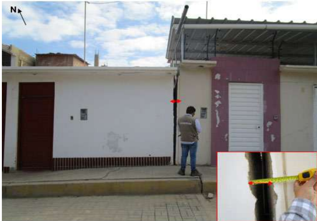
Foto 30: Asentamiento de las estructuras, separación mayor a 5 cm. entre las edificaciones colindantes
