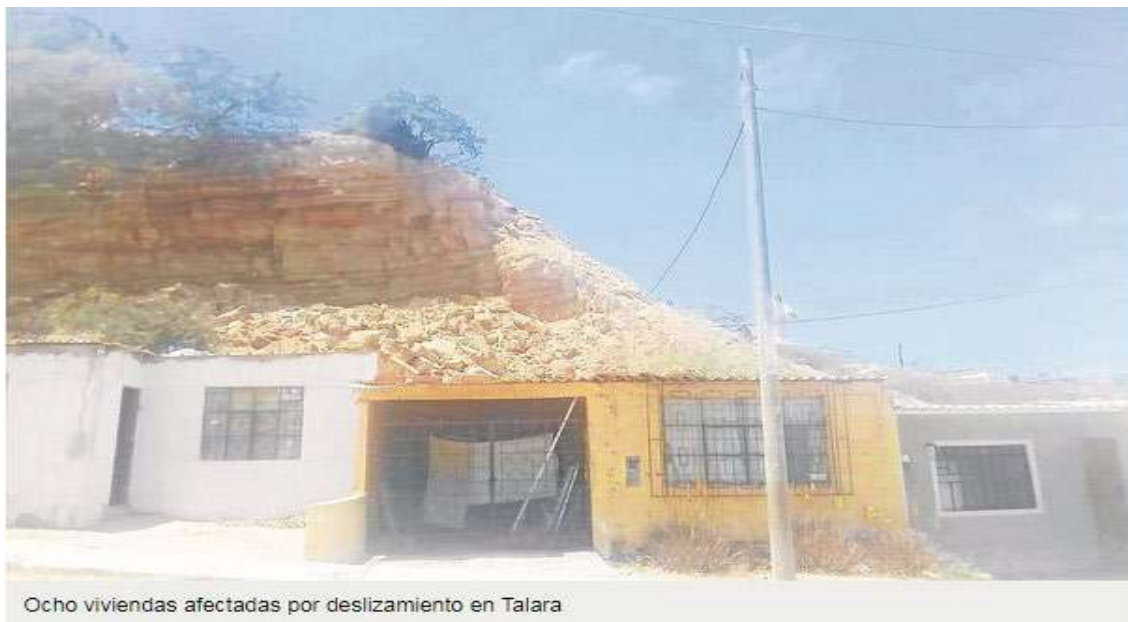
Figura 01: Viviendas afectadas por el deslizamiento, Fuente: Diario El Correo
