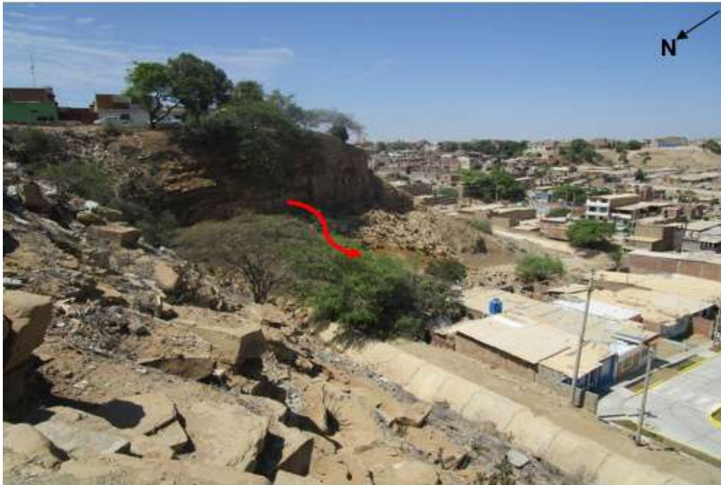
Foto 22: Deslizamiento de material del tablazo, Barrio Popular colindante con A.H. Juan Pablo II
