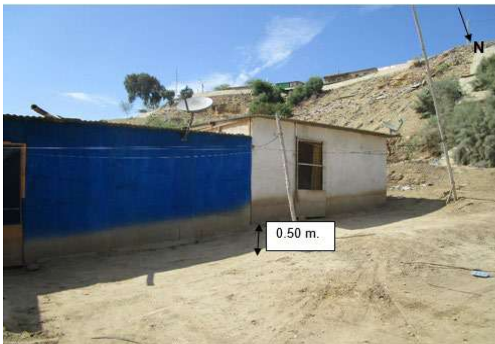
Foto 21: Zona afectada por activación de escorrentías
