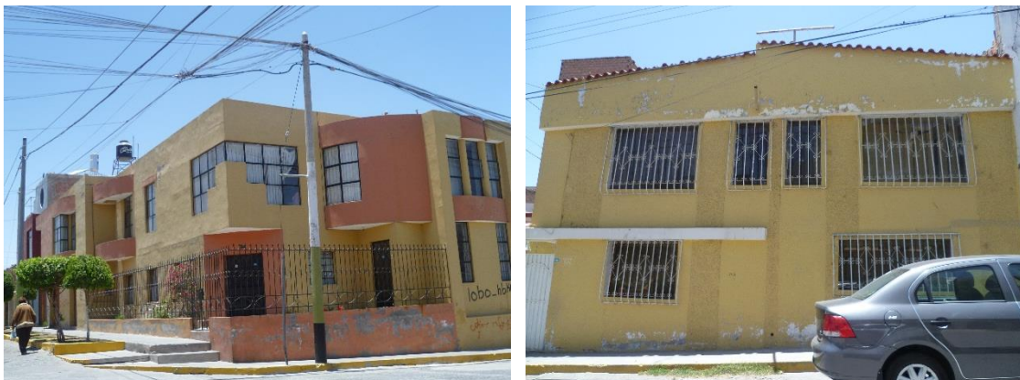
Figura 17. Edificaciones de albañilería del sector 2 con presencia de humedad.
