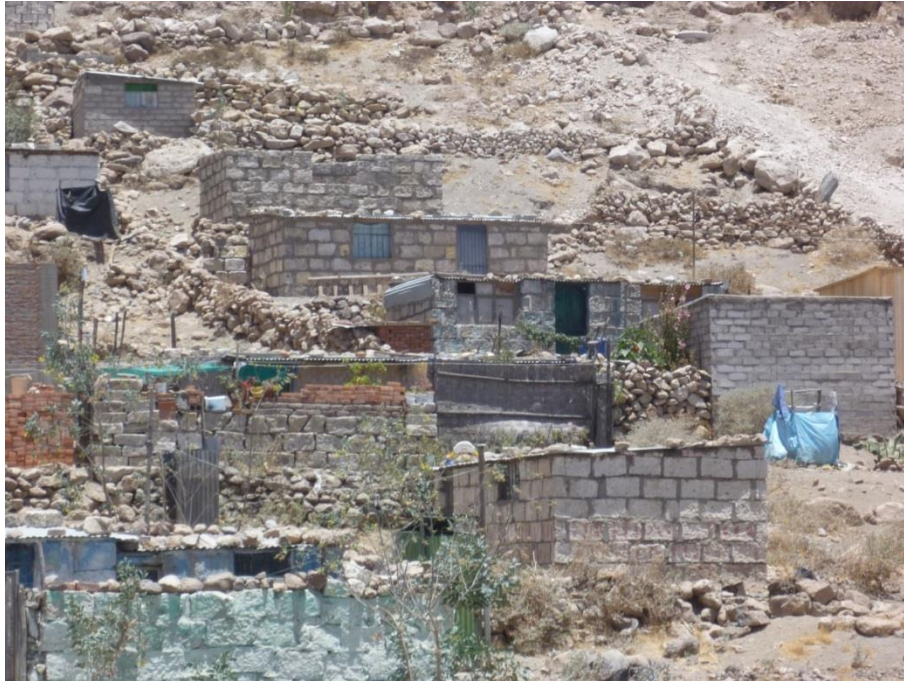
Figura 40. Viviendas de sillar sin confinamiento de un nivel sobre laderas
