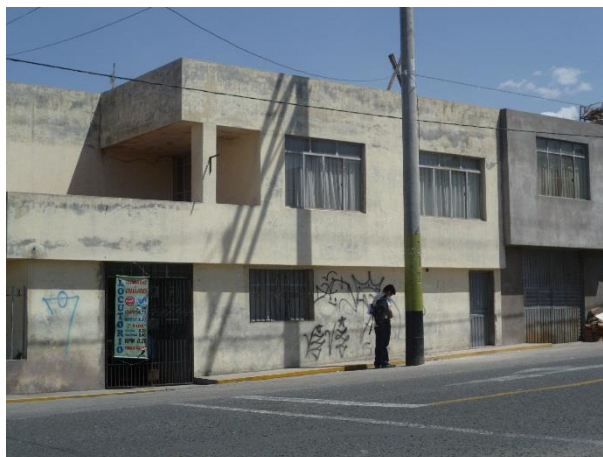
Figura 21. Edificación de albañilería con presencia de humedad del sector 05
