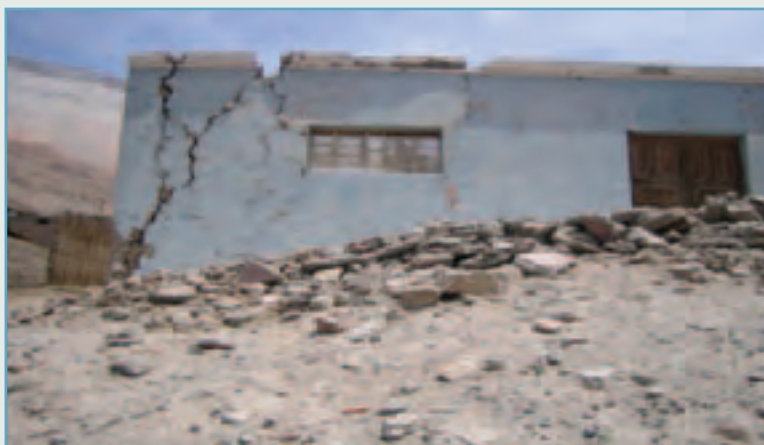
Ilustración 1. Viviendas de la provincia de Castilla luego del sismo del 23 de junio de 2001
