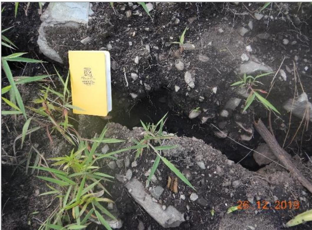
Fotografía 2. Vista de agrietamientos longitudinales en la parte posterior del deslizamiento, con aperturas de 0.50 m en promedio. Ello indica su actividad retrogresivo. Fuente: Ingemmet, 2020.
