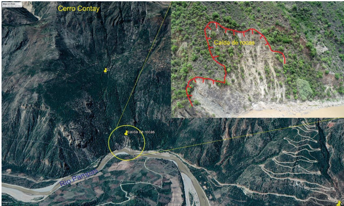
Figura 14. Imagen tomado de Google Earth pro y vista tomada con vehículo aéreo no tripulado (VAT), se observa la zona donde se genera caída de rocas, que afecta tubos de conducción de agua para riego.
