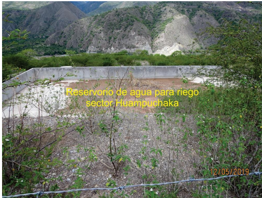
Figura 13. Vista tomada con dirección este, se observa el reservorio de agua para riego, que se ubica sobre depósito de flujo de detrito, de reactivarse podría ser afectado
