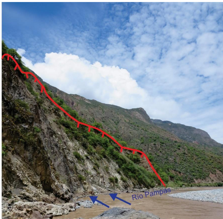
Figura 15. Vista tomada con dirección noroeste, se observa sector que es afectado por caída de rocas; así como también, erosión fluvial al pie del talud.
