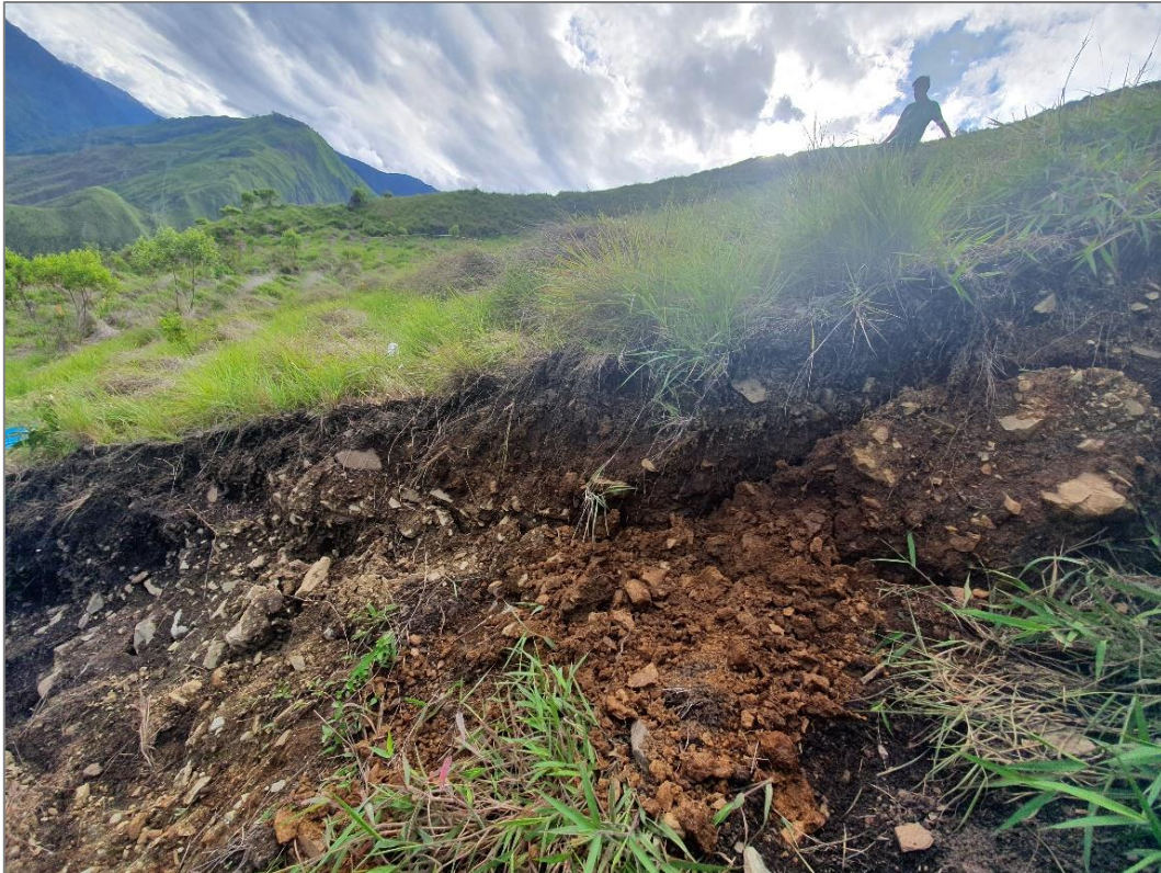
Fotografía 1. Material coluvial (pizarra y arcillas) en el cuerpo del deslizamiento cerro San Valentín- Quilcapata.
