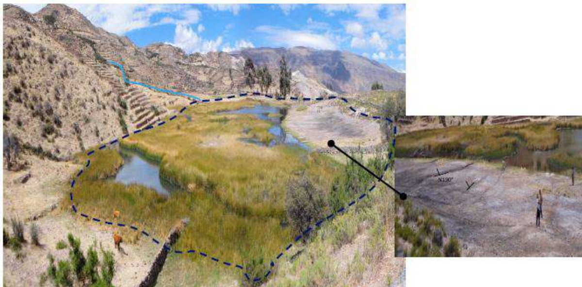
Figura 34. Reservorio artesanal de Jeyrucha, localidad de Andamarca, se resalta la ubicación de las grietas en el piso del reservorio (Fuente: Informe técnico: A6590).
