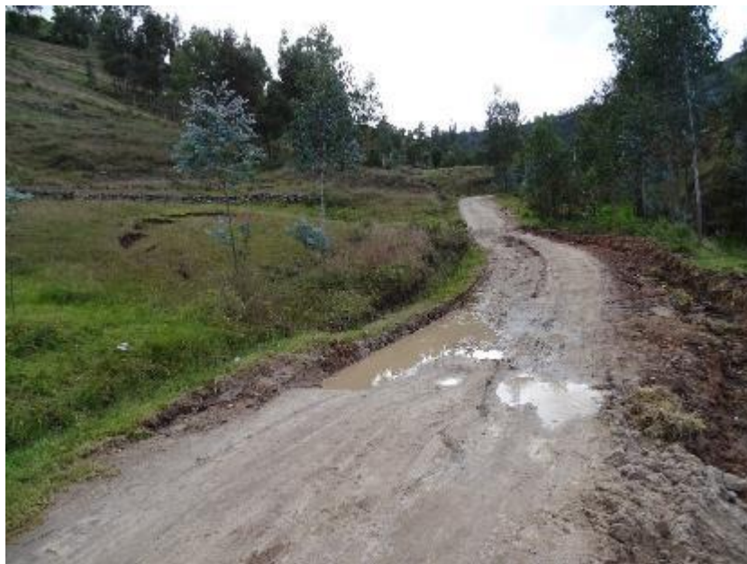
Foto 6: Presencia de escarpas recientes que indica la inestabilidad del terreno.
