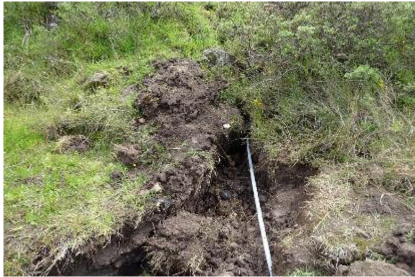
Foto 10: La red de agua potable ha sido afectada por el deslizamiento, por lo que los pobladores han sido desabastecidos temporalmente.
