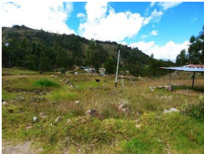
Foto 13: Inclínación de poste de tendido eléctrico, debido al deslizamiento.
