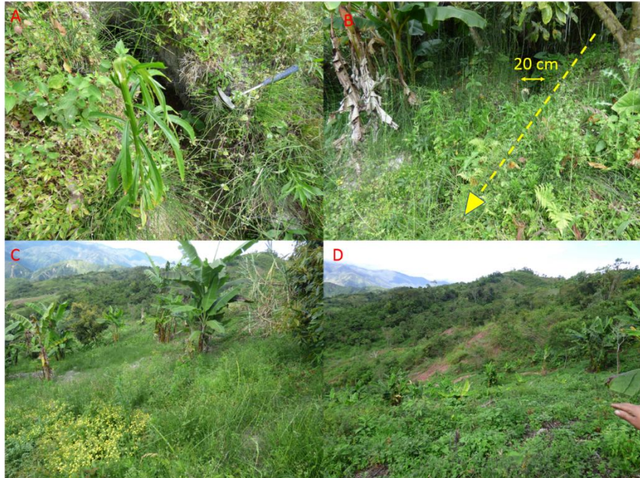
Figura 15: A) se muestra en la quebrada Conchapata la grieta tensional del deslizamiento con escala de medida. B) Presencia de grietas de 20 cm de ancho. C) Se aprecia los árboles inclinados indicando movimiento del suelo. D) Se aprecia erosión superficial en el cuerpo del deslizamiento.
