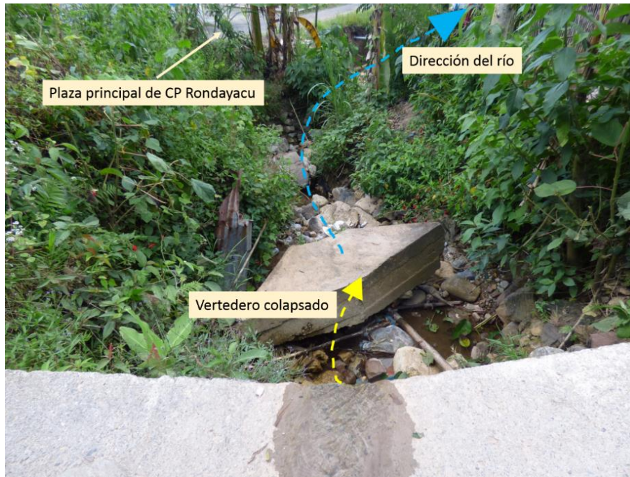
Figura 16: Se ve la quebrada Palillo a la altura del centro poblado Rundayacu, se aprecia al vertedero del badén colapsado a causa del flujo de detritos, que se dio en época de lluvias.
