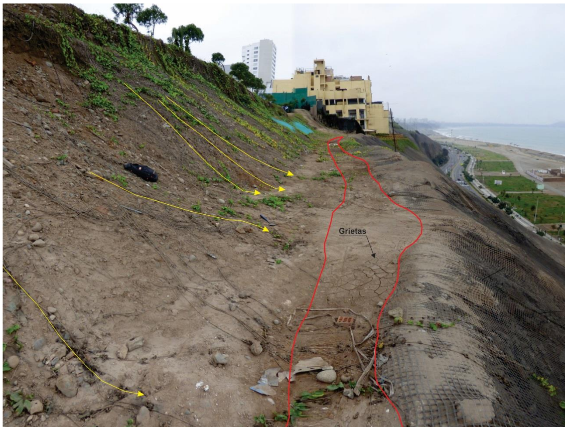
Figura 7.7: Imagen en la que se marcó con flechas de color amarillo los surcos de erosión y en con líneas rojas el depósito de material fino (arcilla y limo) producto de la erosión en surcos acumulado en la terraza superior del acantilado.
