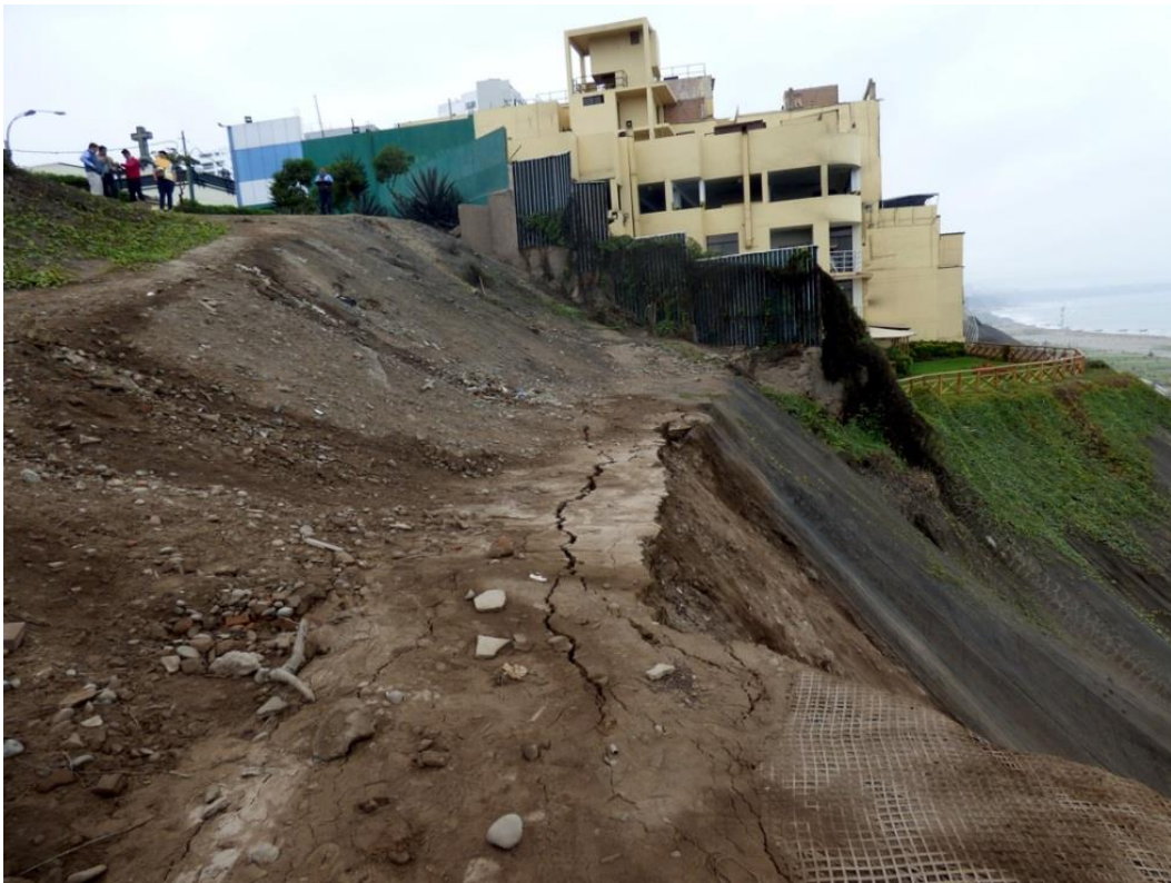
Fotografía 7.1: Vista con dirección hacia el sureste donde se puede ver la zona de arranque del derrumbe ubicado por detrás de los anclajes de las geomallas colocadas en el acantilado; también se pueden observar los agrietamientos abiertos localizados por detrás de la zona de arranque.
