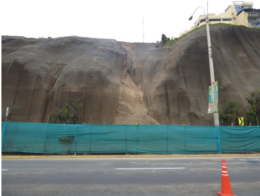
Fotografía 7.4: Vistas con dirección al noreste desde la vía Circuito de Playas donde es posible ver la zona de arranque del derrumbe, parte del material caído que no fue removido y la geomalla arrancada por el evento.
