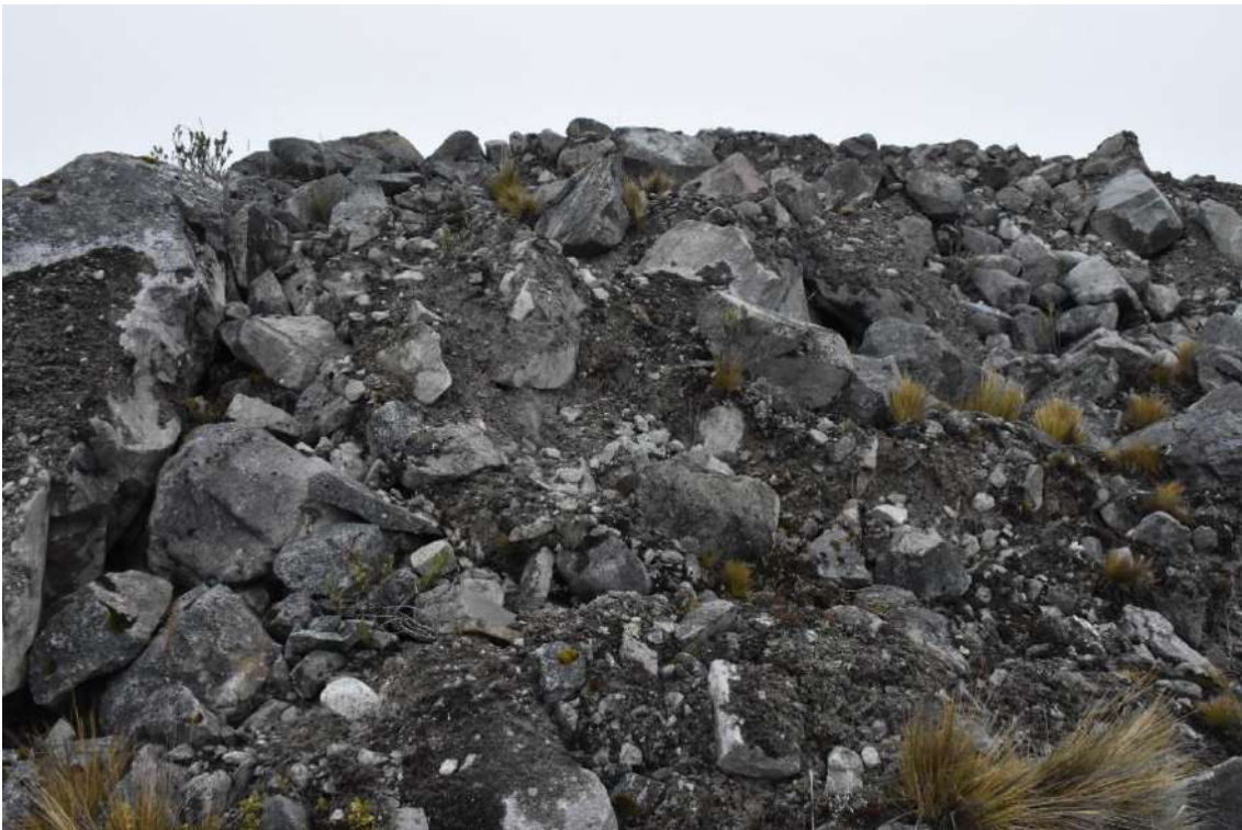
Figura 12. Asentamientos observados el día de la inspección en la zona de desagüe del dique frontal (INAIGEM/ O. Vilca, 20/10/2020).
