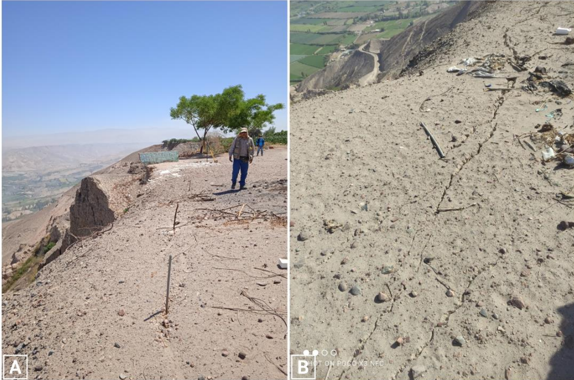
Figura 6. Grietas en la corona del deslizamiento de Pie de la Cuesta. (A) Vista tomada con dirección norte donde se observa grietas selladas por arena. (B) Vista tomada con dirección norte donde se observa grietas abiertas.
