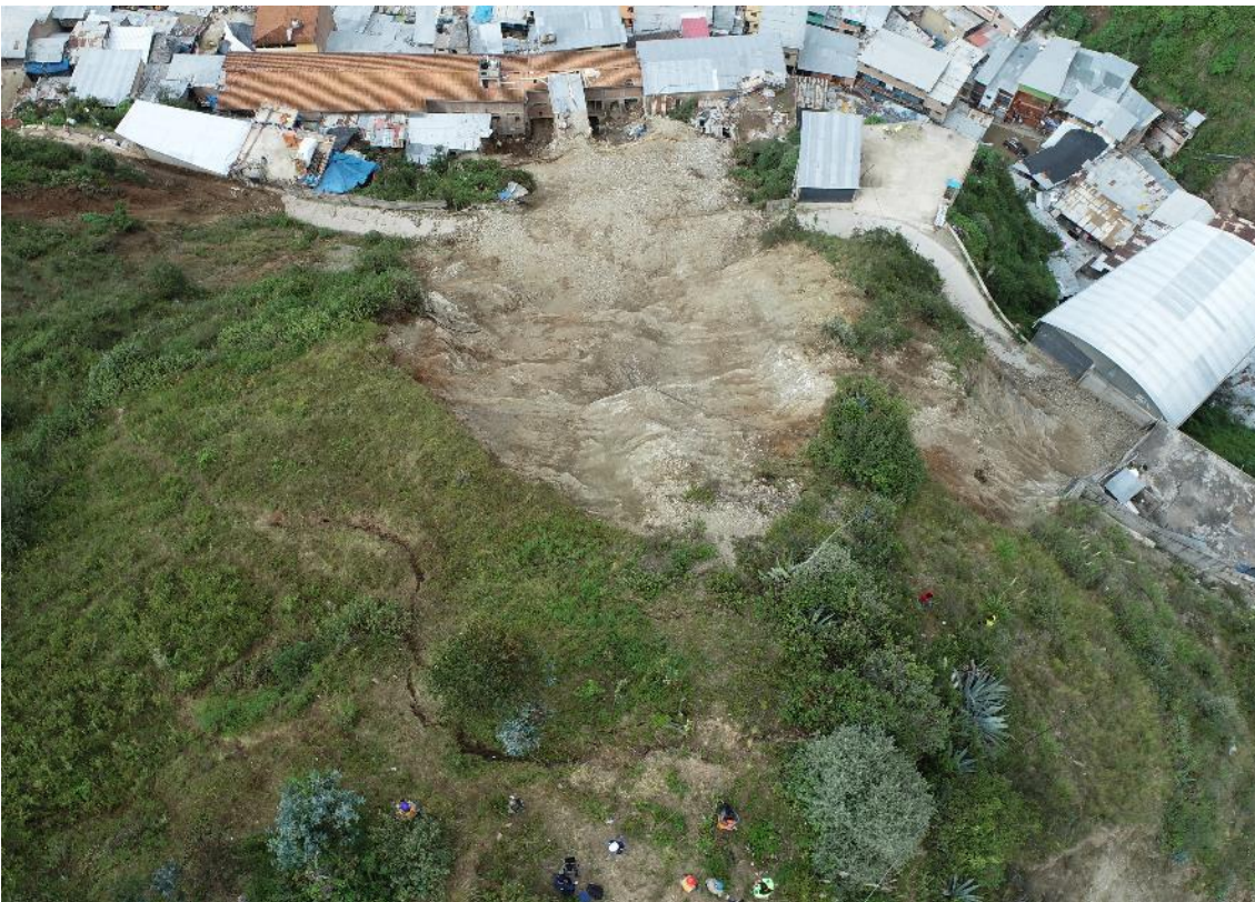
Fotografía 8. Vista vertical de la grieta ubicada en el inmediato superior a la zona de arranque del derrumbe.
