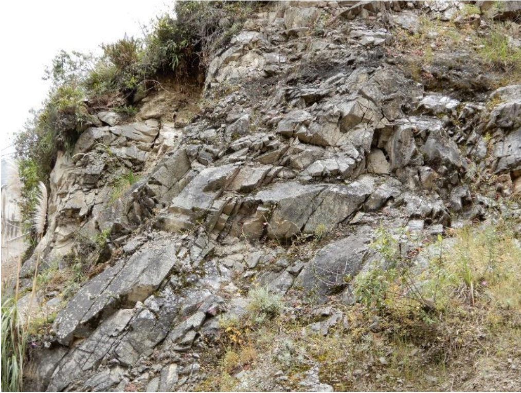
Fotografía 2. Macizo rocoso muy fracturado ubicado en el lado derecho del derrumbe.
