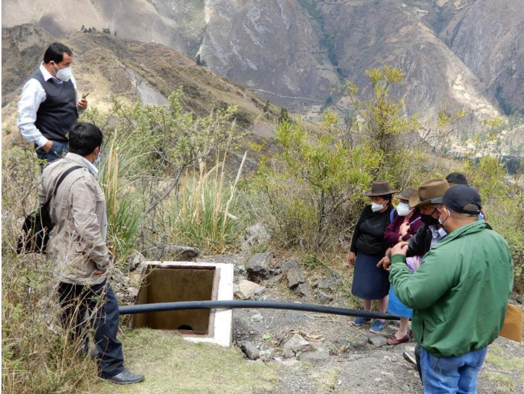
Fotografía 12. Sistema de riego deficiente construido en la cima de la montaña influye en la activación del deslizamiento de Lacsacocho
