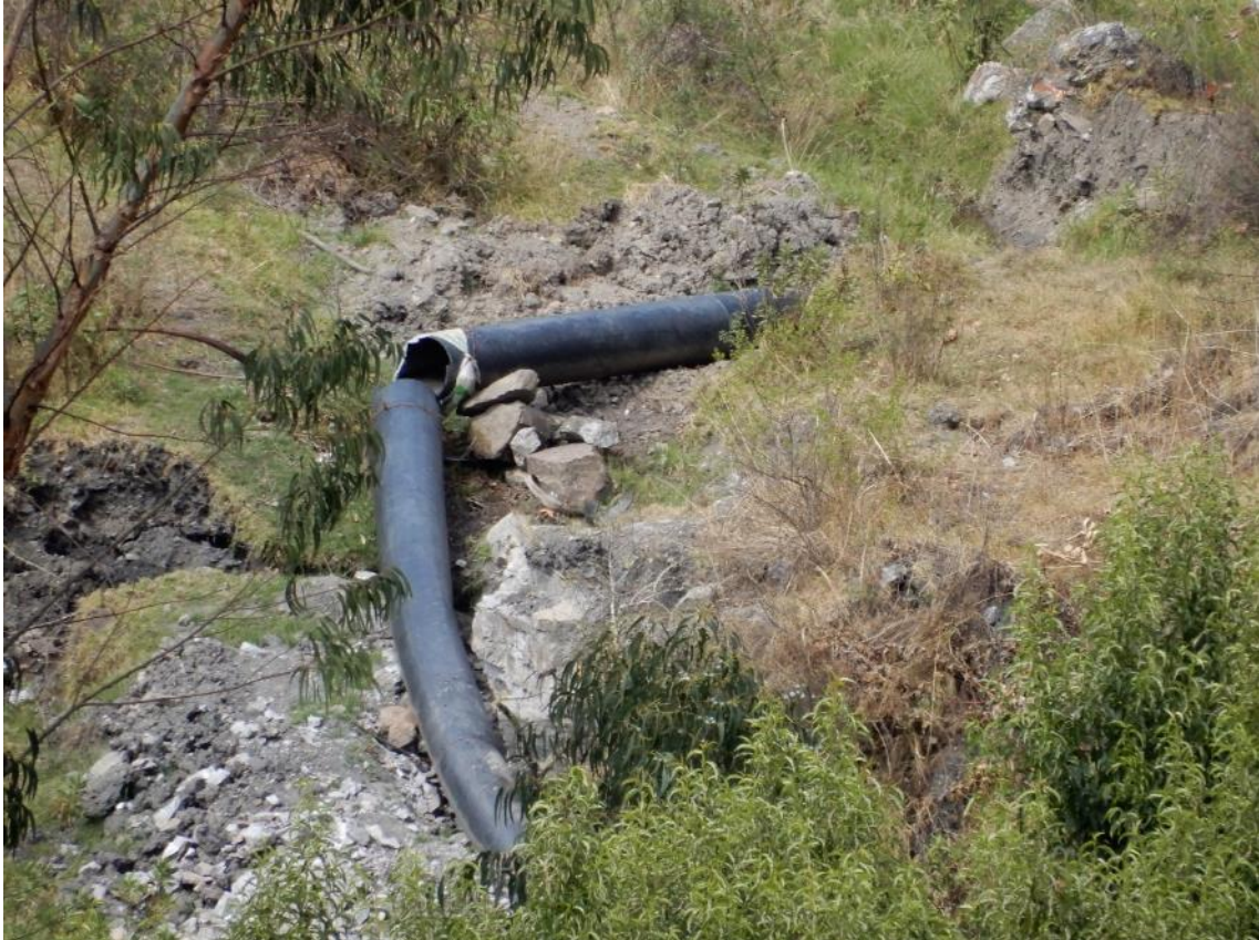
Fotografía 14. Tubería de riego rota ubicado en el cuerpo del deslizamiento de Lacsacocha
