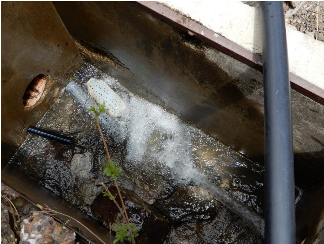
Fotografía 11. Captación de agua para riego sin criterio técnico.
