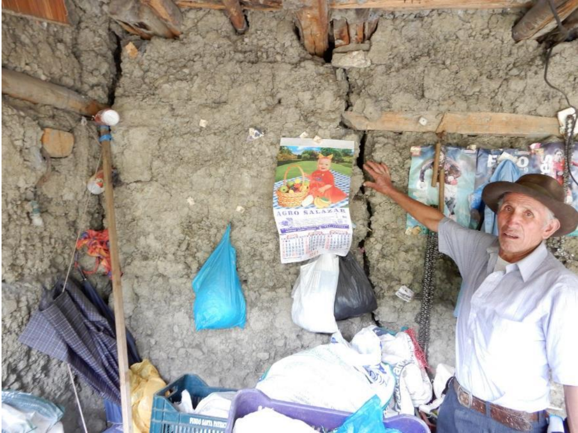
Fotografía 6. Vivienda con pared de tapial afectada por la activación del deslizamiento.
