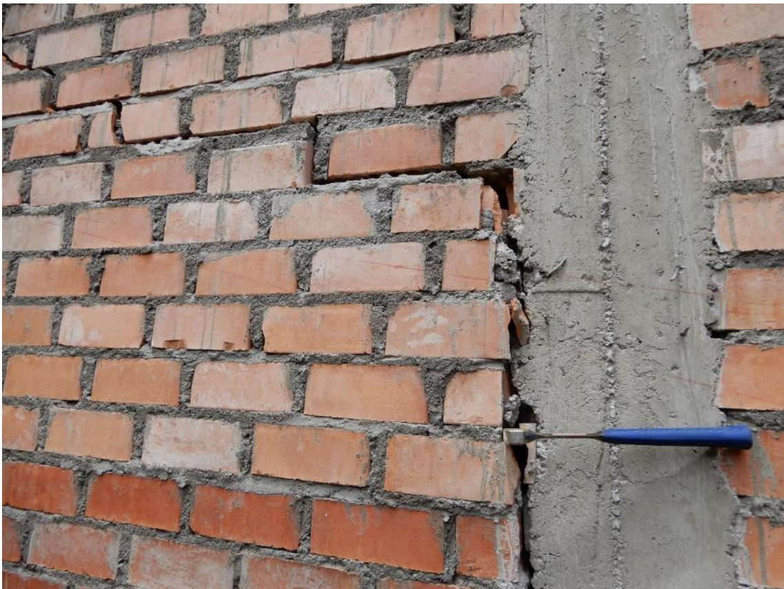
Fotografía 7. Vivienda con pared de ladrillo afectada por la activación del deslizamiento.
